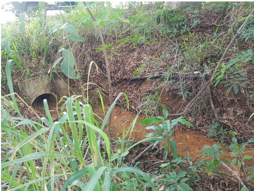
Figura 6 - Saída da rede que capta a água pluvial do lote 26, com lançamento das águas no canal natural que continua existindo após atravessar a via
