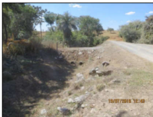
Foto 84: Visada oposta da vala que recebe os efluentes pluviais oriundos da área administrativa.
