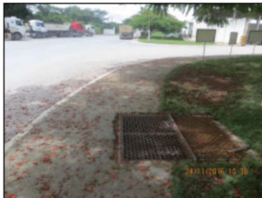
Foto 82: Poço de visita da rede de drenagem pluvial da área administrativa.
