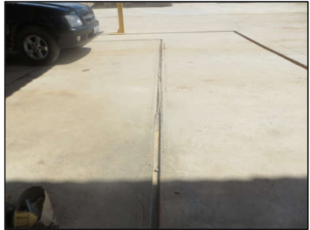
Figura 243: Coordenadas UTM ( Datum Sirgas 2000, fuso 23 L): 200.711 m E; 8.282.579 m S. Canaletas de proteção contra drenagem oleosa.
