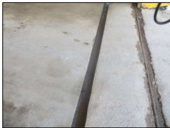
Figura 237: Coordenadas UTM ( Datum Sirgas 2000 , fuso 23 L): 200.712 m E; 8.282.576 m S. Canaletas de proteção contra drenagem oleosa.
