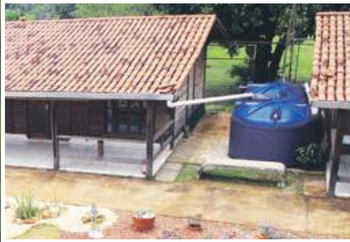
SISTEMA DE CAPTAÇÃO DE ÁGUA DA CHUVA DO CENTRO DE REFERÊNCIA EM EDUCAÇÃO AMBIENTAL - ÁGUAS CLARAS
