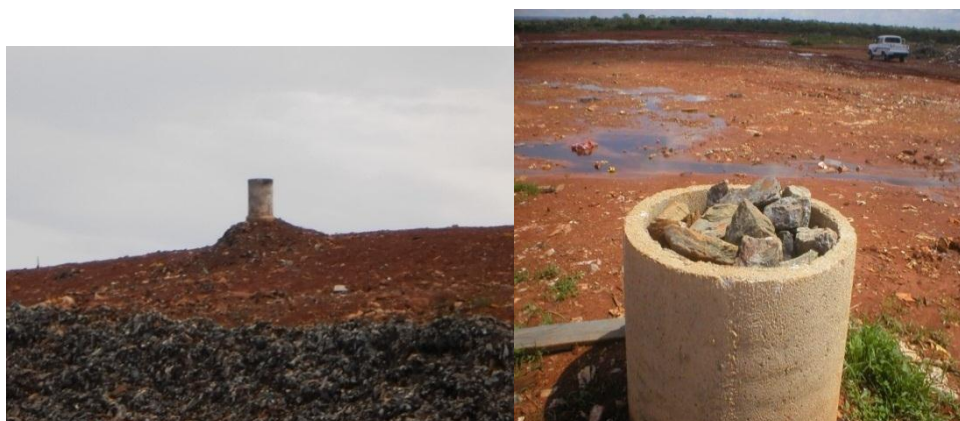
Figura 212 – Dutos de gases.
