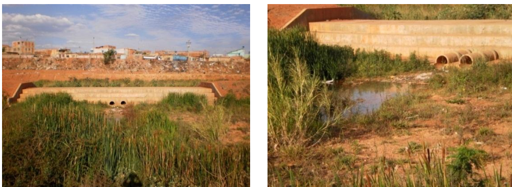
Figura 200– Dissipador e canal de ligação localizado no meio das bacias de contenção.
