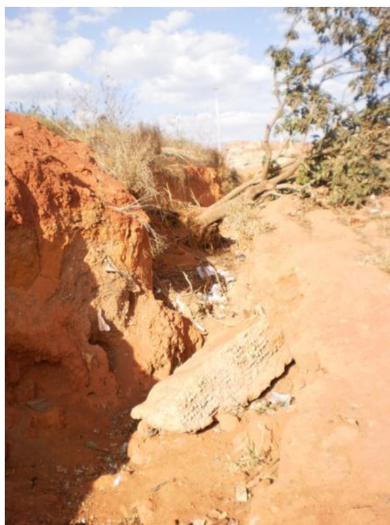
Figura 31 – Processo erosivo ao norte da bacia de contenção no limite externo da poligonal da ARIE do Córrego Cabeceira do Valo.
