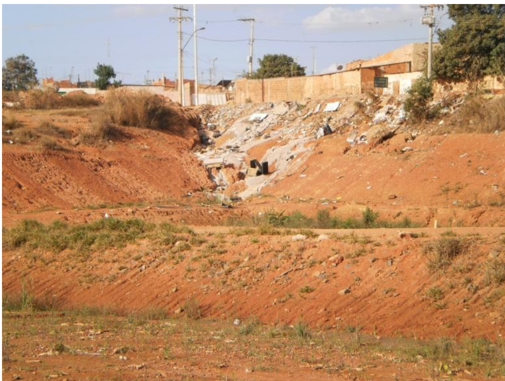
Figura 30 – Ponto de descida do escoamento superficial, com restos de cimento e entulho depositados pela população para contenção dos processos erosivos.
