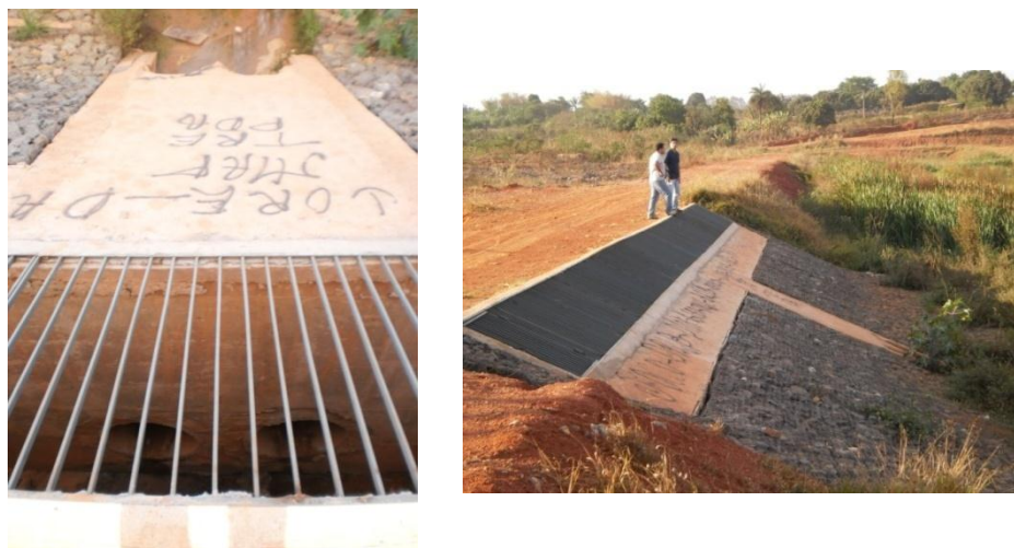
Figura 202 – Início do emissário que verte as águas coletadas nas bacias de contenção para o corpo receptor.
