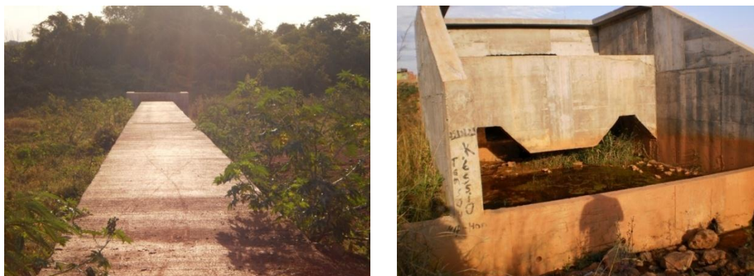
Figura 203 – Emissário e Dissipador final junto ao corpo receptor córrego Cabeceira do Valo.
