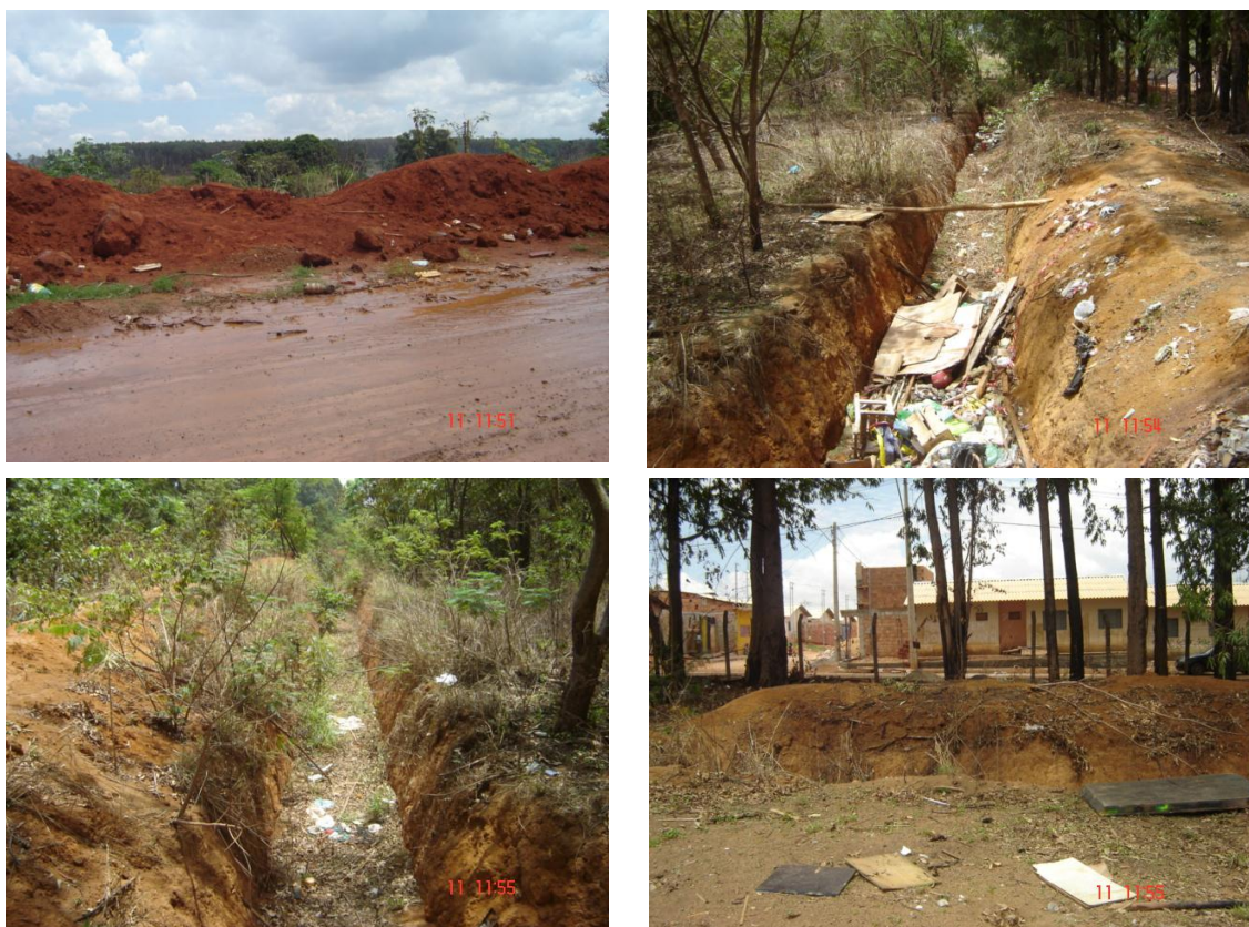
Figura 172 - Indicação do estado da estrada com respectiva barreira física de terra, e o estado da vala de contenção do Lixão.
