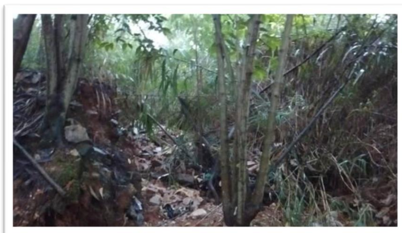
Figura 43: Lixo e material de aterro carreados para dentro da unidade.
