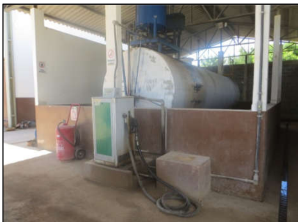
Figura 191: Coordenadas UTM ( Datum Sirgas 2000, fuso 23 L): 200.712 m E; 8.282.576 m S. Tanque de combustível que será desativado.
