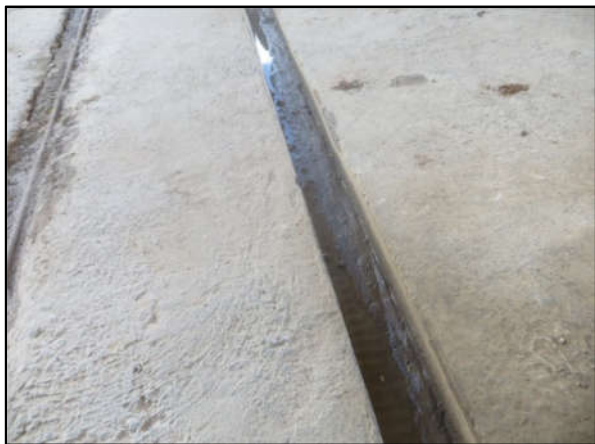
Figura 193: Coordenadas UTM ( Datum Sirgas 2000, fuso 23 L): 200.712 m E; 8.282.576 m S. canaletas de drenagem.
