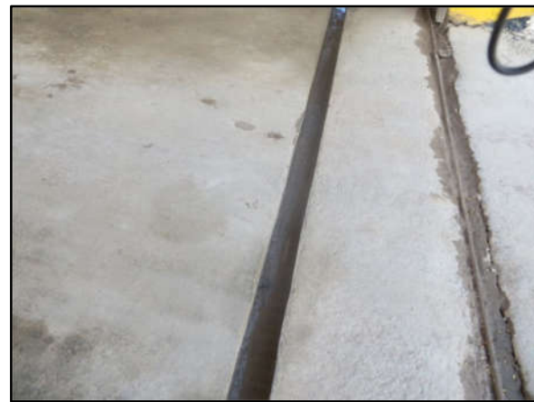
Figura 190: Coordenadas UTM ( Datum Sirgas 2000 , fuso 23 L): 200.712 m E; 8.282.576 m S. Canaletas de proteção contra drenagem oleosa.
