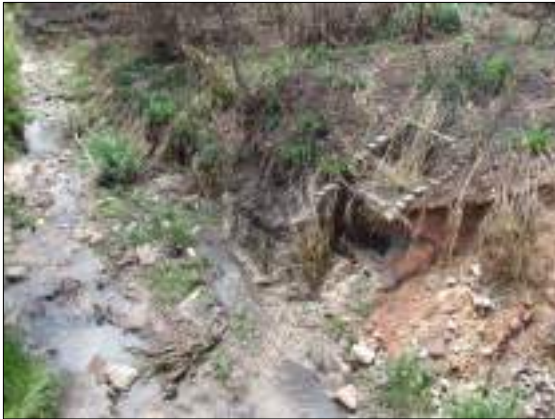
Figura 126 – Constatação de erosão e assoreamento nas margens do Córrego Vereda Grande – Imagem 01 (Ponto 991)
