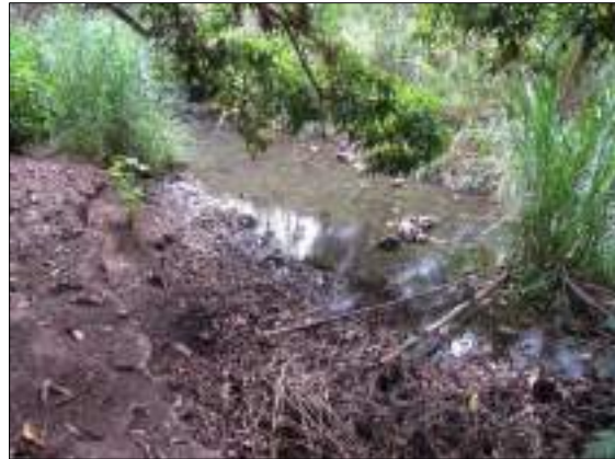
Figura 137 – Constatação de assoreamento e quantidade significativa de serrapilheira (Ponto 992)
