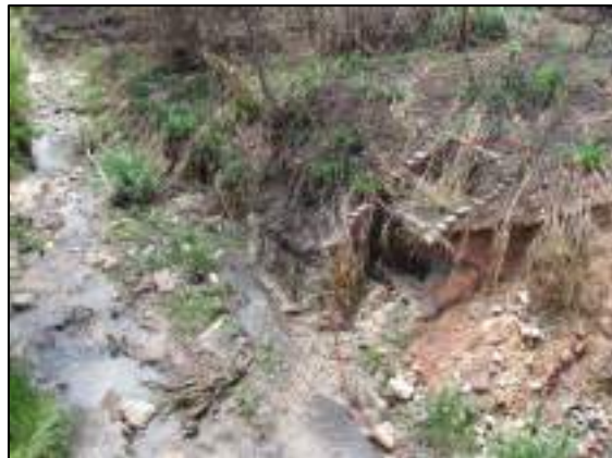
Figura 53 – (AD05) Erosão às Margens do Córrego Vereda da Cruz Coordenada UTM - SIRGAS 2000 / Zona 23S/E- 178378,2156 /S- 8246380,798. Data da foto: 10/10/2016 às 11 h e 05 min.
