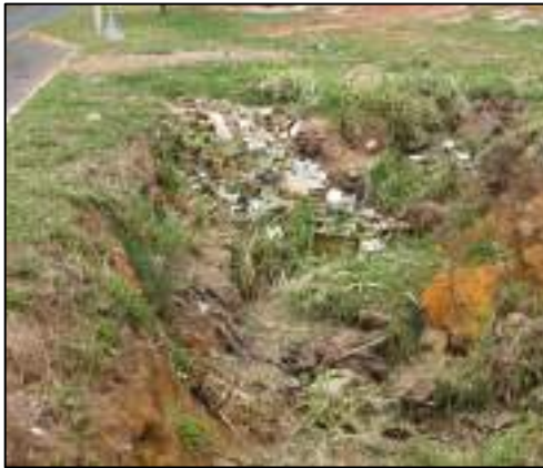
Figura 40 – (AD02) Resíduos Sólidos Domésticos e Erosão
