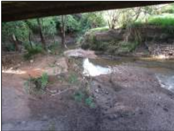
Figura 101 – (CVP02) Assoreamento Coordenada UTM - SIRGAS 2000 / Zona 23S/E- 179331,13/S-8247250,97. Data da foto: 10/10/2016 às 16 h e 35 min
