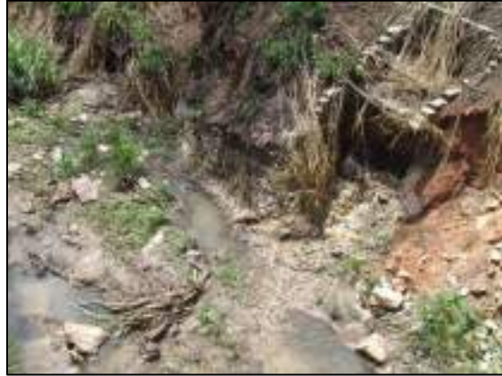
Figura 84 – (CVC02) Assoreamento e Erosão. Coordenada UTM - SIRGAS 2000 / Zona 23S/E- 178378,22/S-8246380,8. Data da foto: 10/10/2016 às 11 h e 05 min
