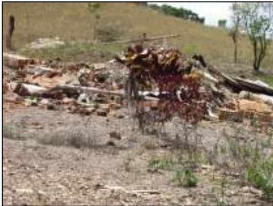
Figura 57 - (AD 07) Resíduos de Construção Civil Coordenada UTM - SIRGAS 2000 / Zona 23S/E- 177295,7597 /S- 8244070,405. Data da foto: 10/10/2016 às 12 h e 16 min.
