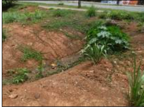
Figura 55 - (AD06) Erosão Coordenada UTM - SIRGAS 2000 / Zona 23S/E- 178704,2138 /S- 8245643,667. Data da foto: 10/10/2016 às 11h 22 min.
