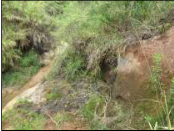
Figura 50 – (AD04) Erosão às Margens do Córrego Vereda da Cruz Coordenada UTM - SIRGAS 2000 / Zona 23S/E- 176998,3033 /S- 8245734,832. Data da foto: 10/10/2016 às 10h 45 min.
