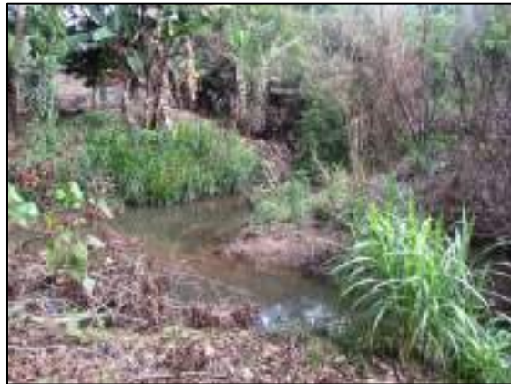
Figura 98 – (CVG03) Assoreamento Coordenada UTM - SIRGAS 2000 / Zona 23S/E- 179449,36/S-8243567,17. Data da foto: 10/10/2016 às 15 h e 13 min
