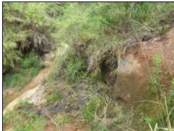
Figura 82 – (CVC01) Erosão das Margens. Coordenada UTM - SIRGAS 2000 / Zona 23S/E- 176998,3/S-8245734,83. Data da foto: 10/10/2016 às 10 h e 46 min
