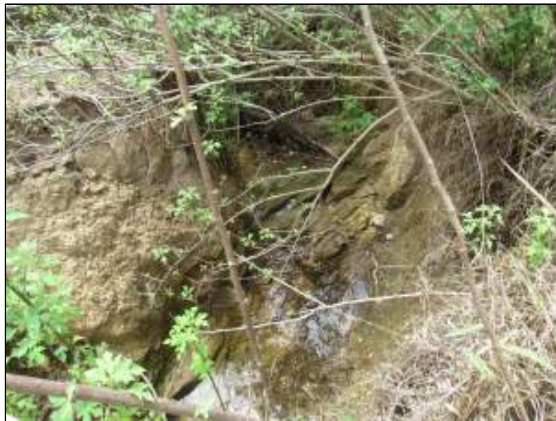
Figura 64 – (AD11) Solo Erodido Coordenada UTM - SIRGAS 2000 / Zona 23S/E- 178284,4977 /S- 8243269,701. Data da foto: 10/10/2016 às 12 h e 49 min.
