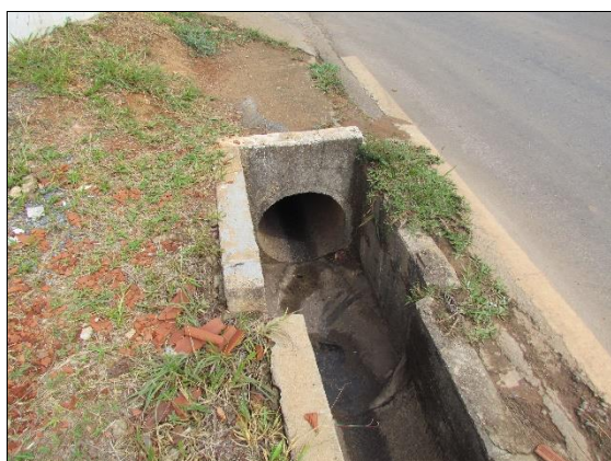
Foto 1.7: Rede de águas pluviais na estrada do sol. Data: 06/10/2016. UTM Zona 23 L 201177 m E 8243861 m N. Azimute: 316°.
