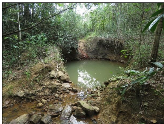
Foto 4.11: Erosão causada pelo escape de água da barragem.
