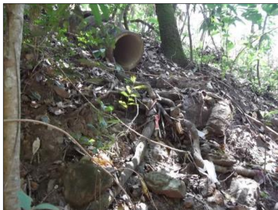
Foto 3.20: Observa-se lançamento de água das residências próximas.
