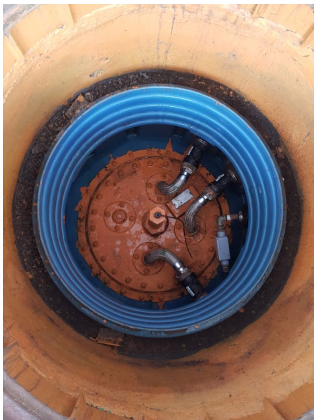
Foto 05 - Boca de visita de um dos tanques, dotada de câmara de contenção
