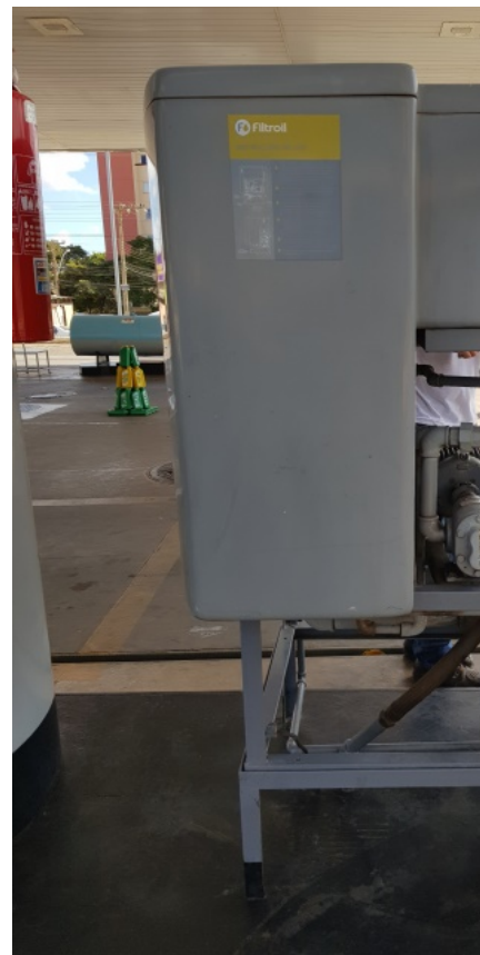
Foto 22 - Filtro de diesel localizado na área
