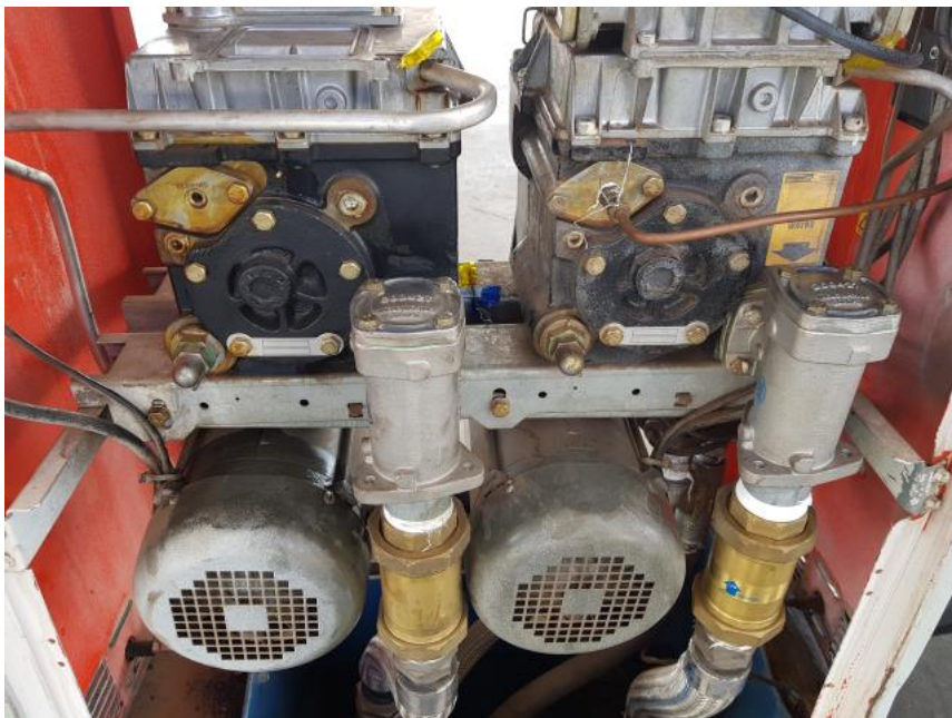
Foto 21 - Unidade abastecedora dotada de sensor de detecção de vazamentos "CheckValve"
