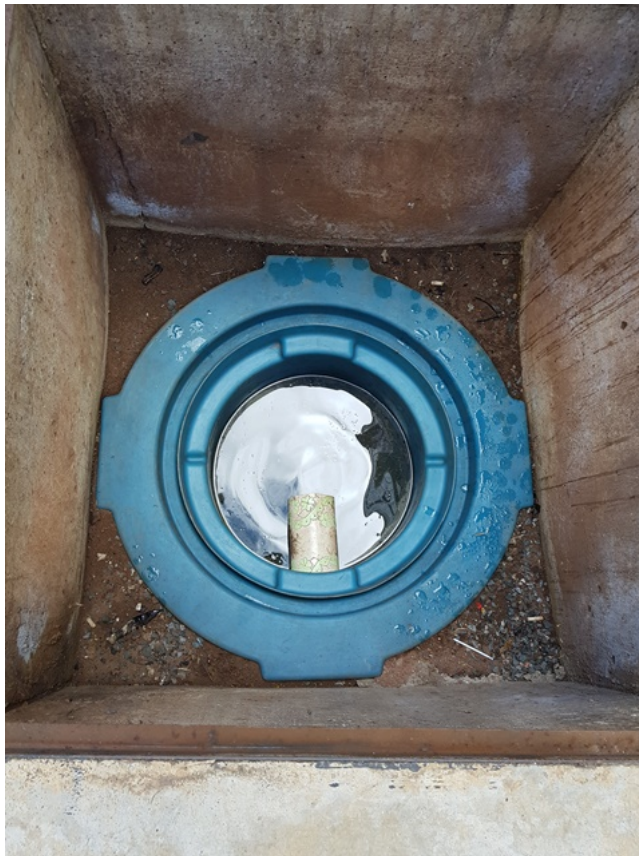
Foto 25 - Caixa de areia
