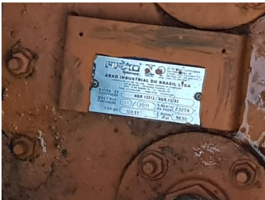
Foto 03 - Placa de identificação de um dos tanques
