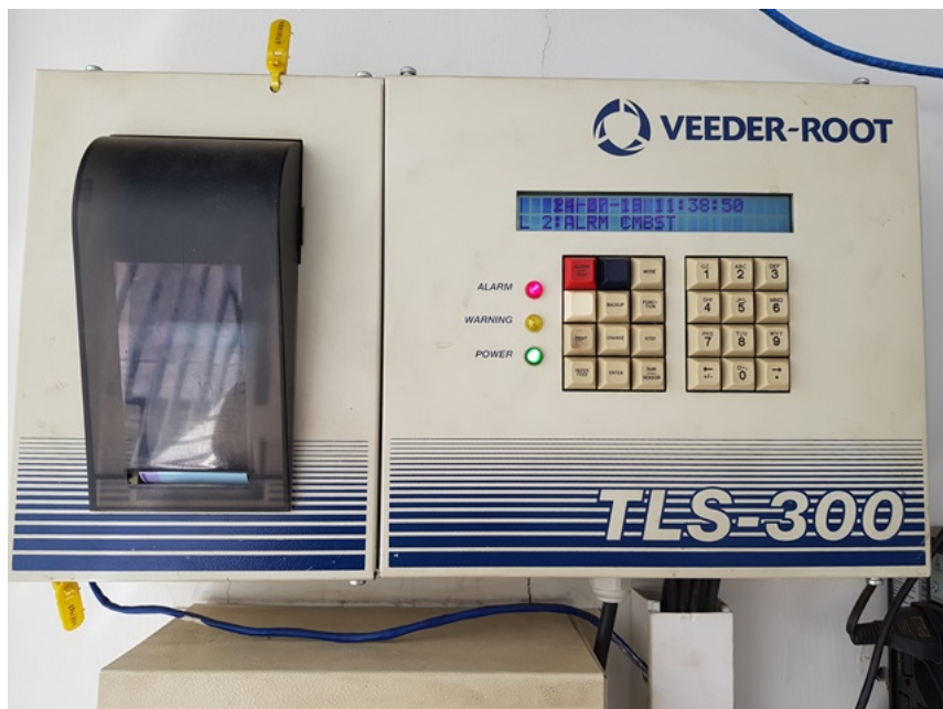
Foto 07 - Monitoramento realizado de forma eletrônica, "Veeder Root"
