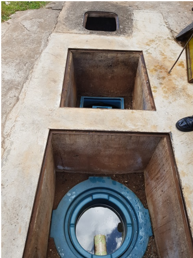
Foto 24 - Sistema Separador de Água e Óleo
