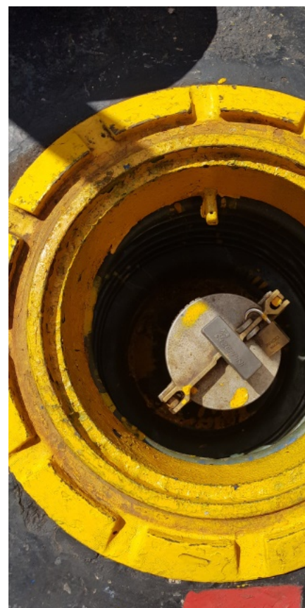
Foto 10 - Câmara de contenção da descarga selada a distância
