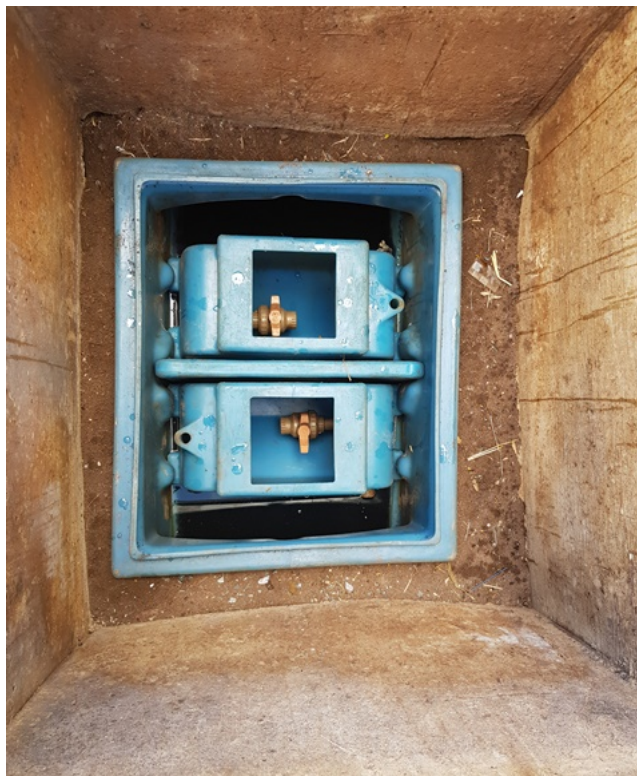
Foto 26 - Caixa separadora de água e óleo
