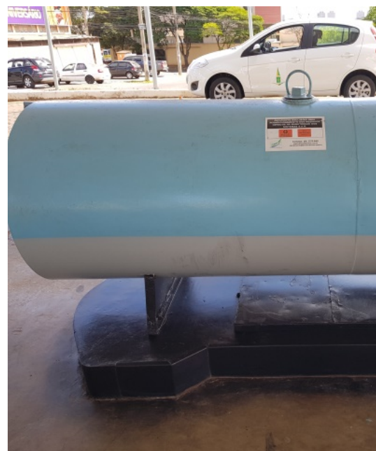
Foto 28 - Tanque de OLUC
