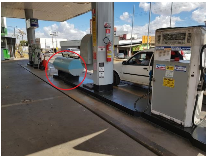
Foto 27 - Tanque de OLUC, localizado dentro de área coberta e circundado por canaletes
