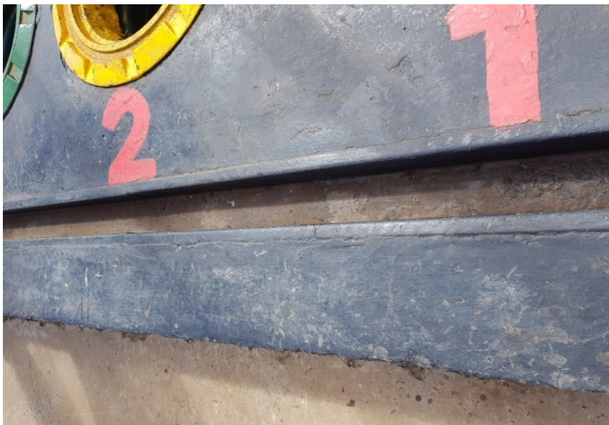
Foto 11 - Canaletas da descarga selada a distância, em bom estado de manutenção
