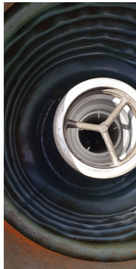
Foto 06 - Válvula anti-transbordamento da descarga selada e da área circundada por canal
