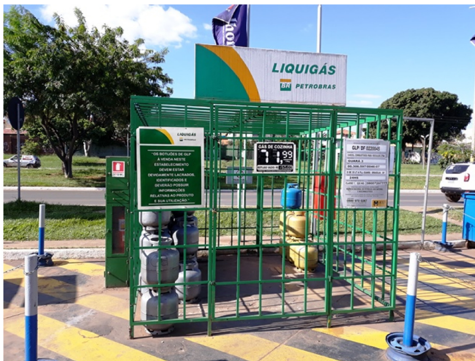
Figura 12 - Área de armazenamento de Gás Liquefeito de Petróleo - GLP.
