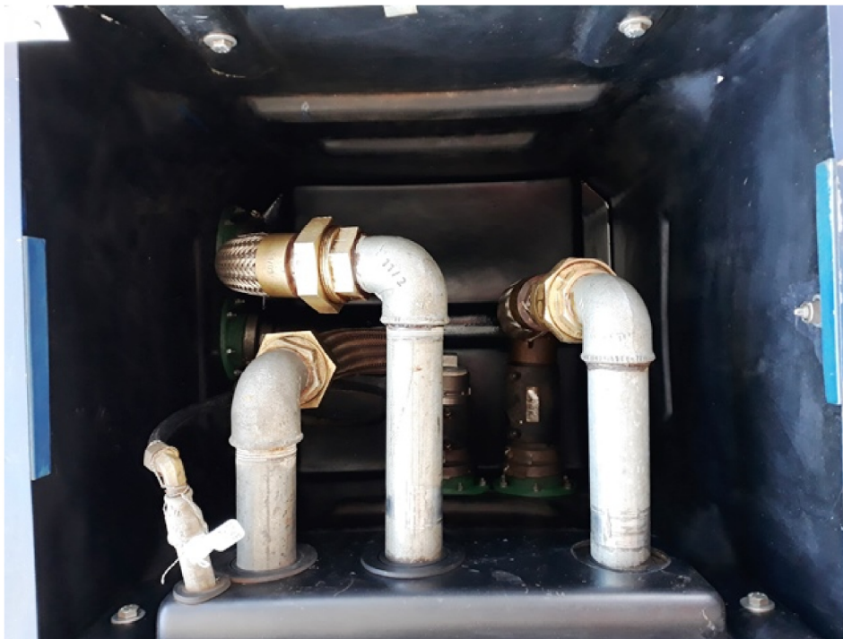
Figura 7 - Detalhe interno da câmara de contenção da unidade de filtragem de óleo diesel. Observa-se que a tubulação está totalmente contida no sump de filtro da câmara de contenção no dispositivo de segurança. Os sump das demais unidades necessitam de manutenção operacional diária conforme exige a ABNT NBR 15594-3:2008 tabela 1.
