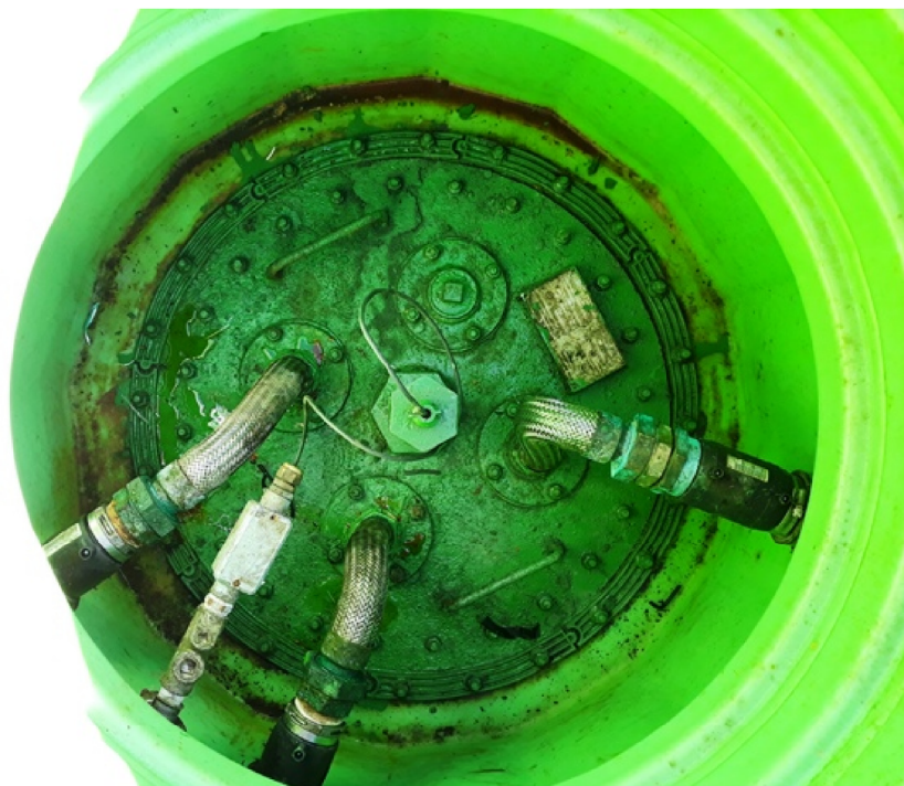
Figura 10 - Aspecto da câmara de contenção de acesso à boca de visita ( sump de tanque ) do tanque com controle eletrônico de estoque, tubulação metálica flexível, tubulação subterrânea em PEAD e flanges de vedação. O tanque deverá ter manutenção operacional constante conforme exige a ABNT NBR 15594-3:2008 tabela 1.
