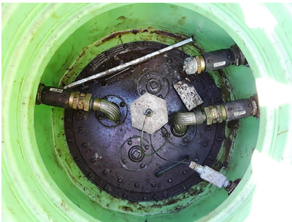
Figura 11 - Aspecto da câmara de contenção de acesso à boca de visita de um dos SASC ( sump de tanque ) do tanque com controle eletrônico de estoque, tubulação metálica flexível, tubulação subterrânea em PEAD e flanges de vedação. O tanque deverá ter manutenção operacional constante conforme exige a ABNT NBR 15594-3:2008 tabela 1.
