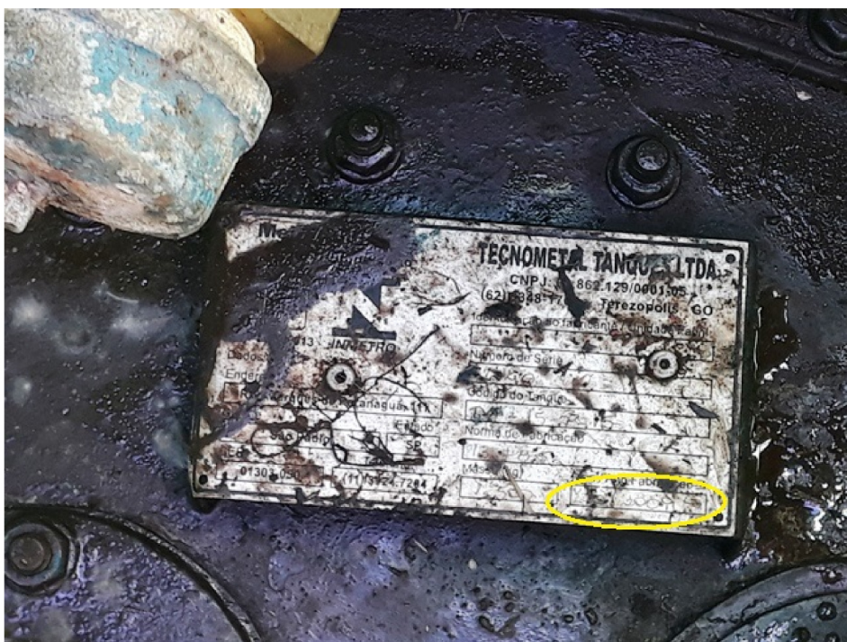
Figura 12 - Placa de identificação datado de 2009 de um dos tanques. Observa-se o estado de conservação da placa do tanque no que prejudica a sua visualização.
