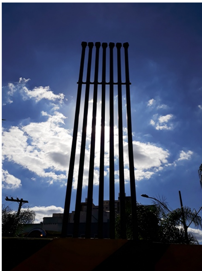
Figura 9 - Aspecto das unidades dos Respiros com terminal corta chamas em conformidade com o que é exigido na norma vigente.
