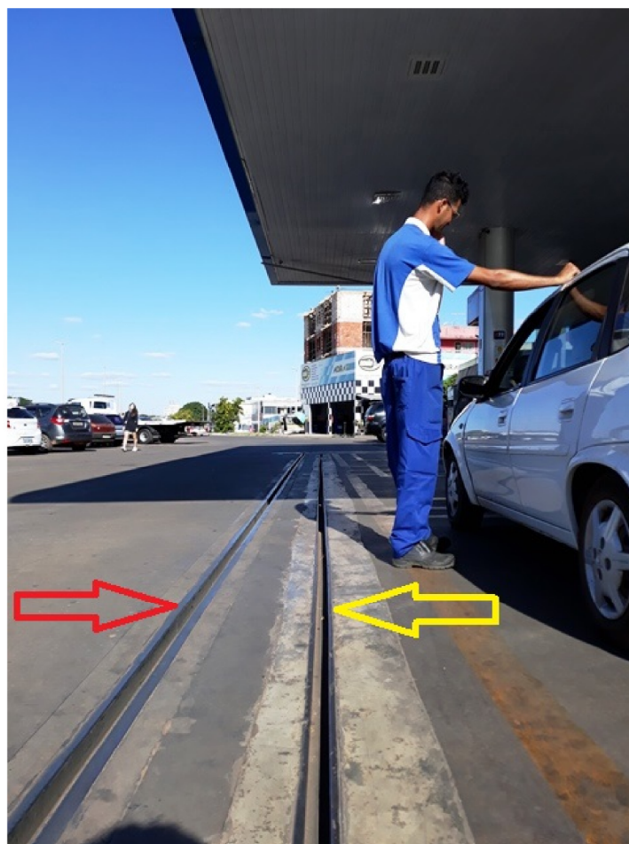
Figura 8 - Canaletes Internos ( seta amarela ) do Sistema de Drenagem Oleosa - SDO com recuo interno de 0,5 metros conforme exige a ABNT NBR 14.605-2:2010 item 4 e externos ( seta vermelha ) do Sistema de drenagem de águas pluviais da pista de abastecimento.
