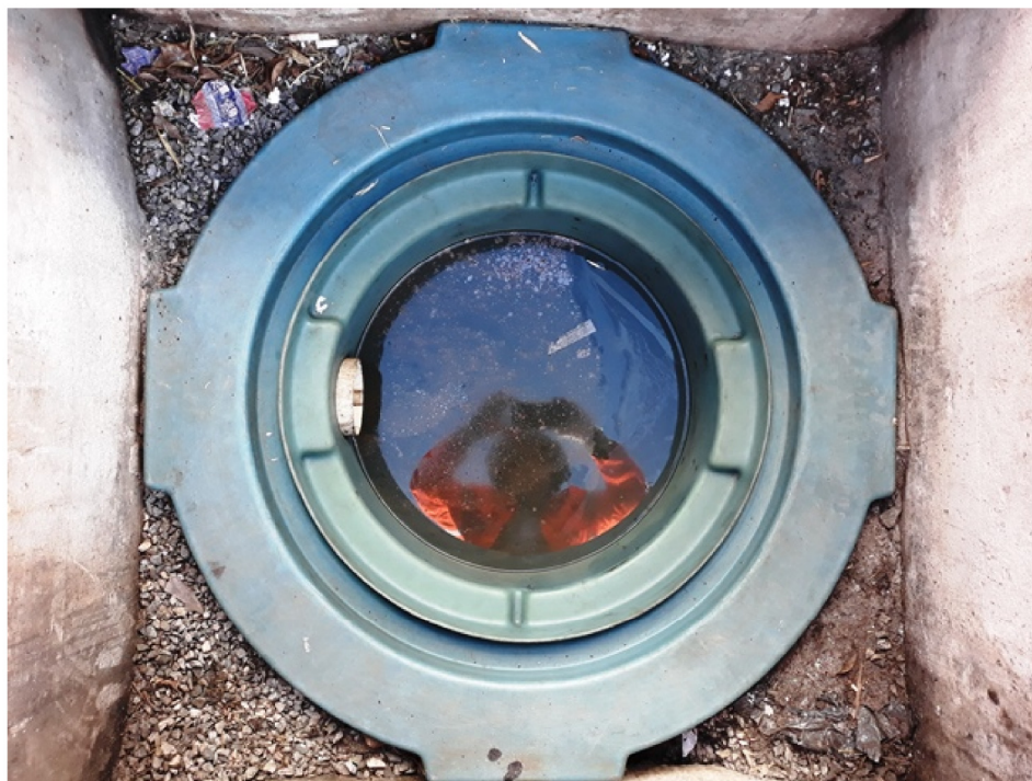
Figura 13 - Aspecto da Caixa de Areia do SAO da pista de Abastecimento.
