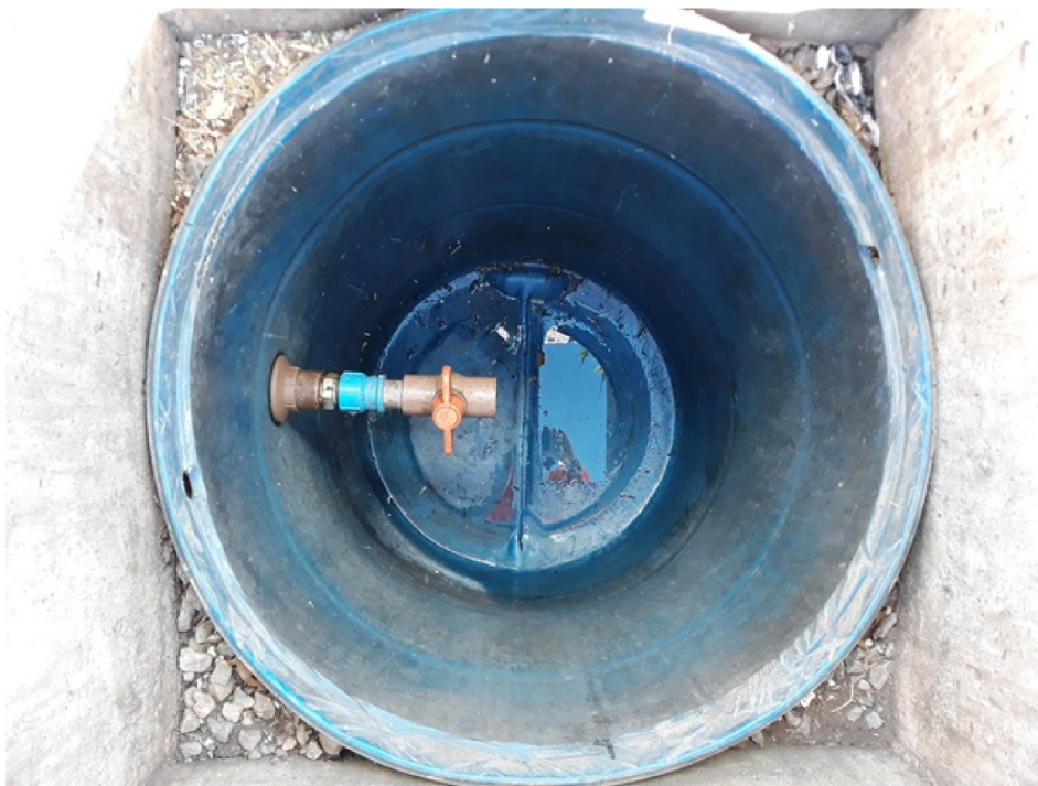
Figura 14 - Aspecto da Caixa Coletora de Óleo - CSAO da pista de abastecimento.
