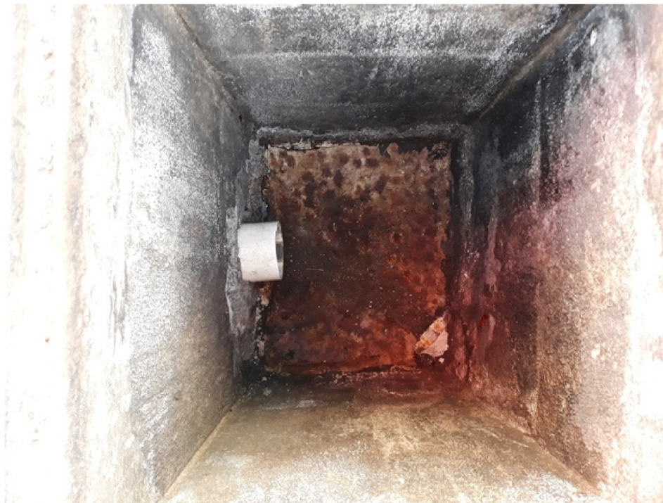
Figura 14 - Aspecto da caixa de amostragem de efluentes do SAO da pista de abastecimento.
