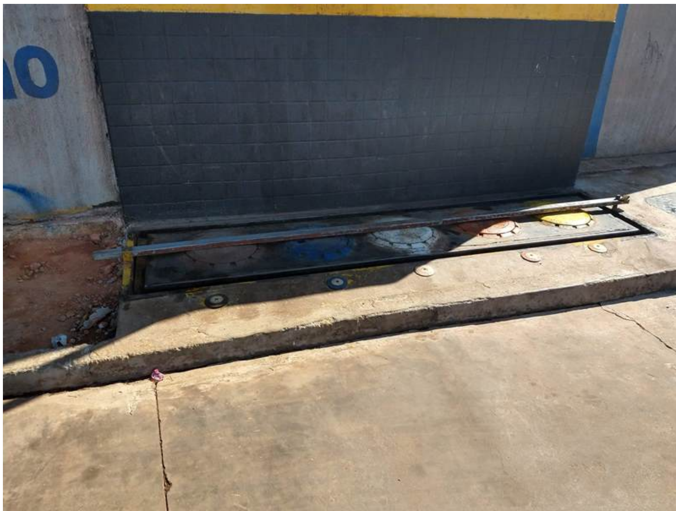
Figura 06 - Descarga selada a distância, que atende aos tanques bipartidos e pleno, cercada por canaletes e direcionado ao sistema separador.
