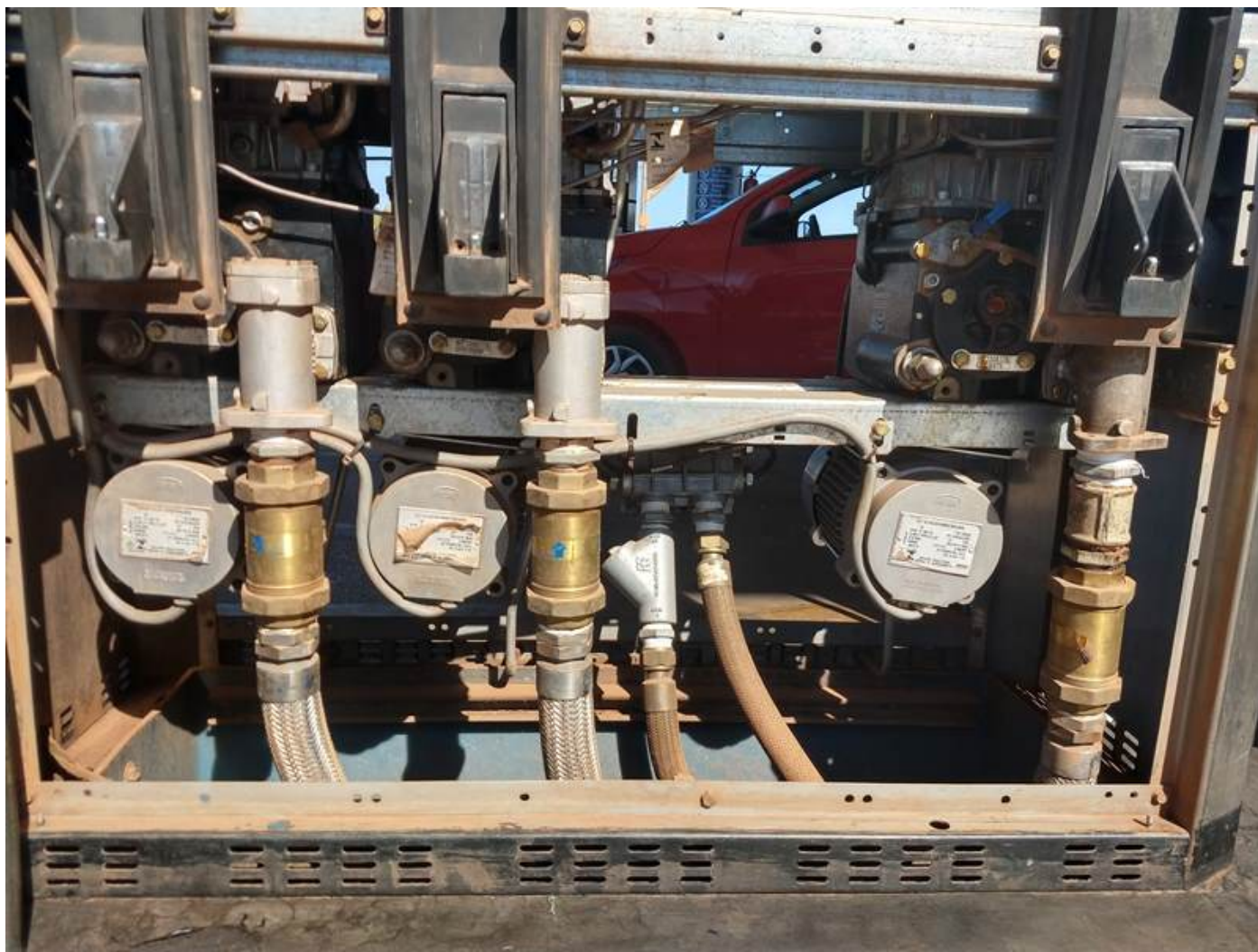
Figura 14 - Interior da unidade abastecedora, observa-se a presença de válvulas de retenção.
