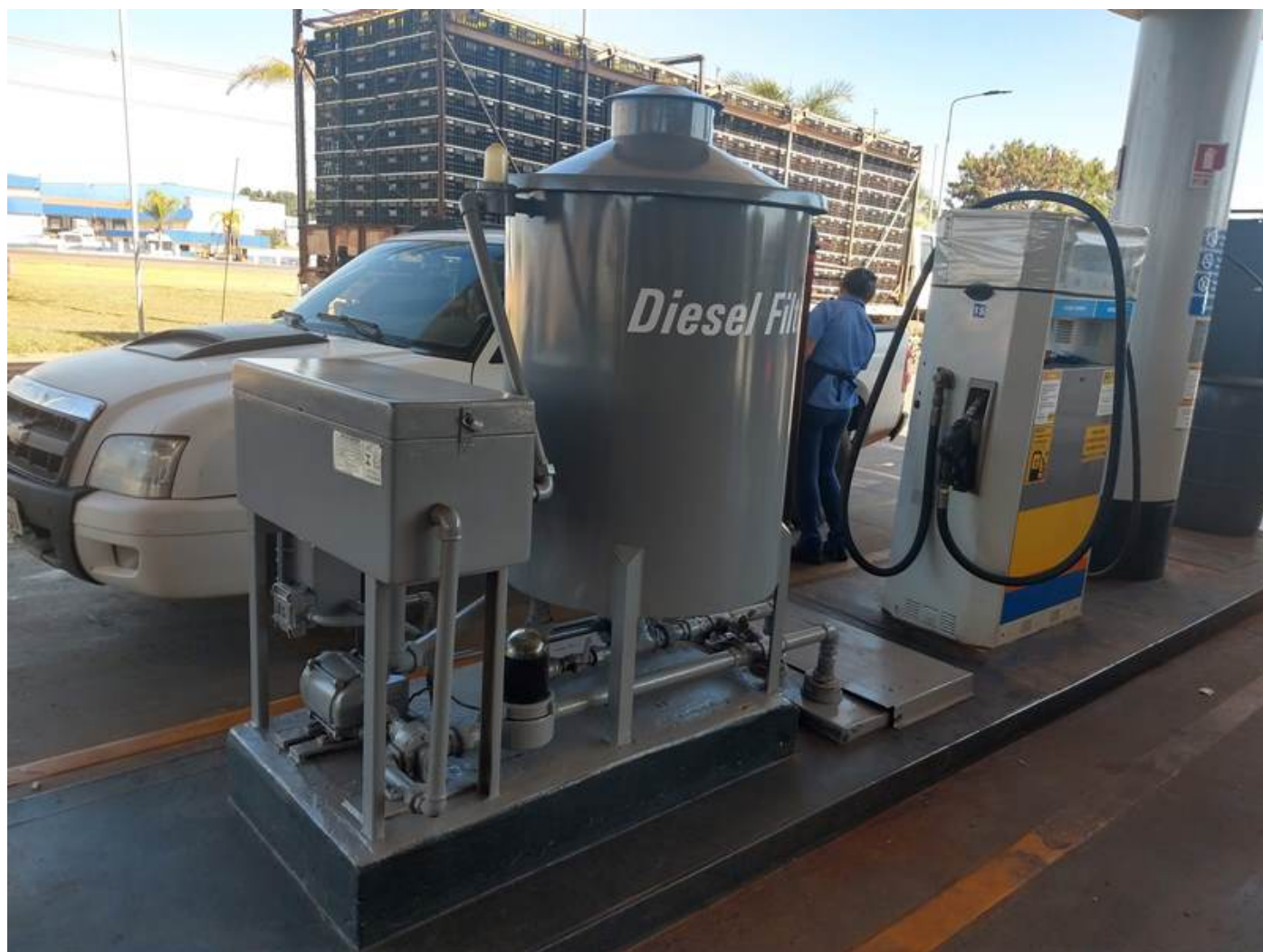
Figura 10 - Unidade de filtragem de diesel, dotada de câmara de contenção e boa manutenção.
