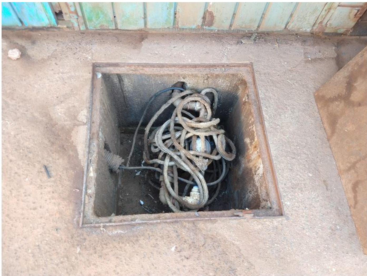
Figura 20 - Poço de captação de água, segundo funcionários ainda é utilizado para irrigação.
