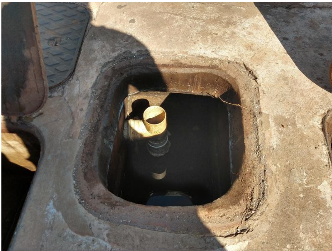
Figura 18 - Caixa separadora desativada.
