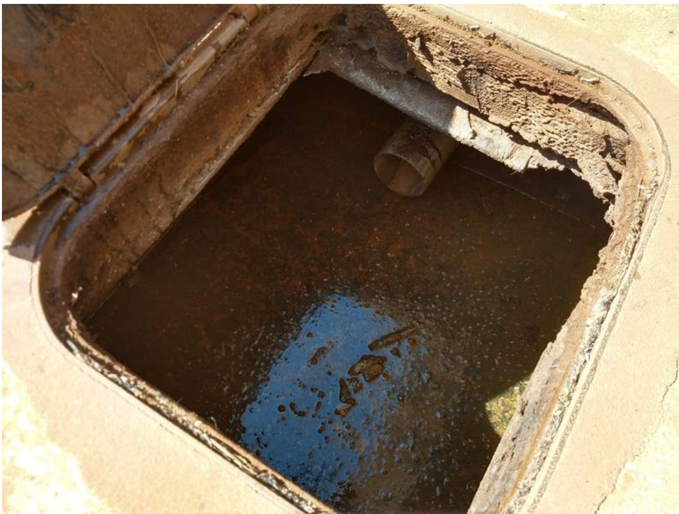
Figura 19 - Caixa de areia do sistema separador da área de lavagem de veículos, observa-se a presença de sobrenadantes.
