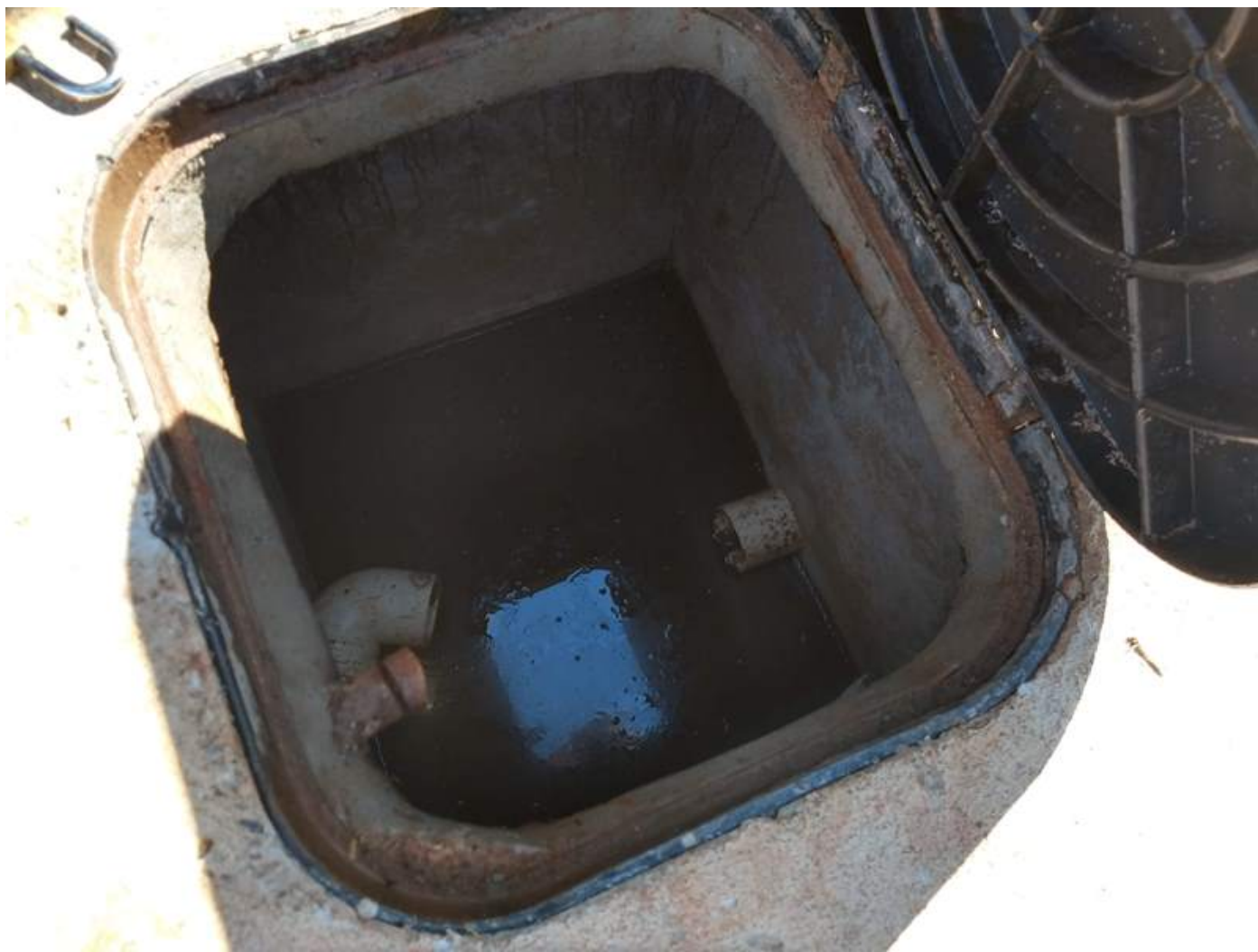
Figura 15 - Caixa separadora de água e óleo do novo sistema, instalado próximo as descargas seladas à distância.
