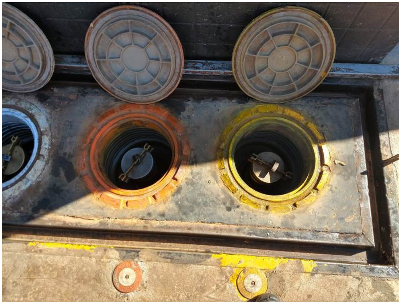
Figura 07 - Descargas seladas à distância dotadas de câmaras de contenção.
