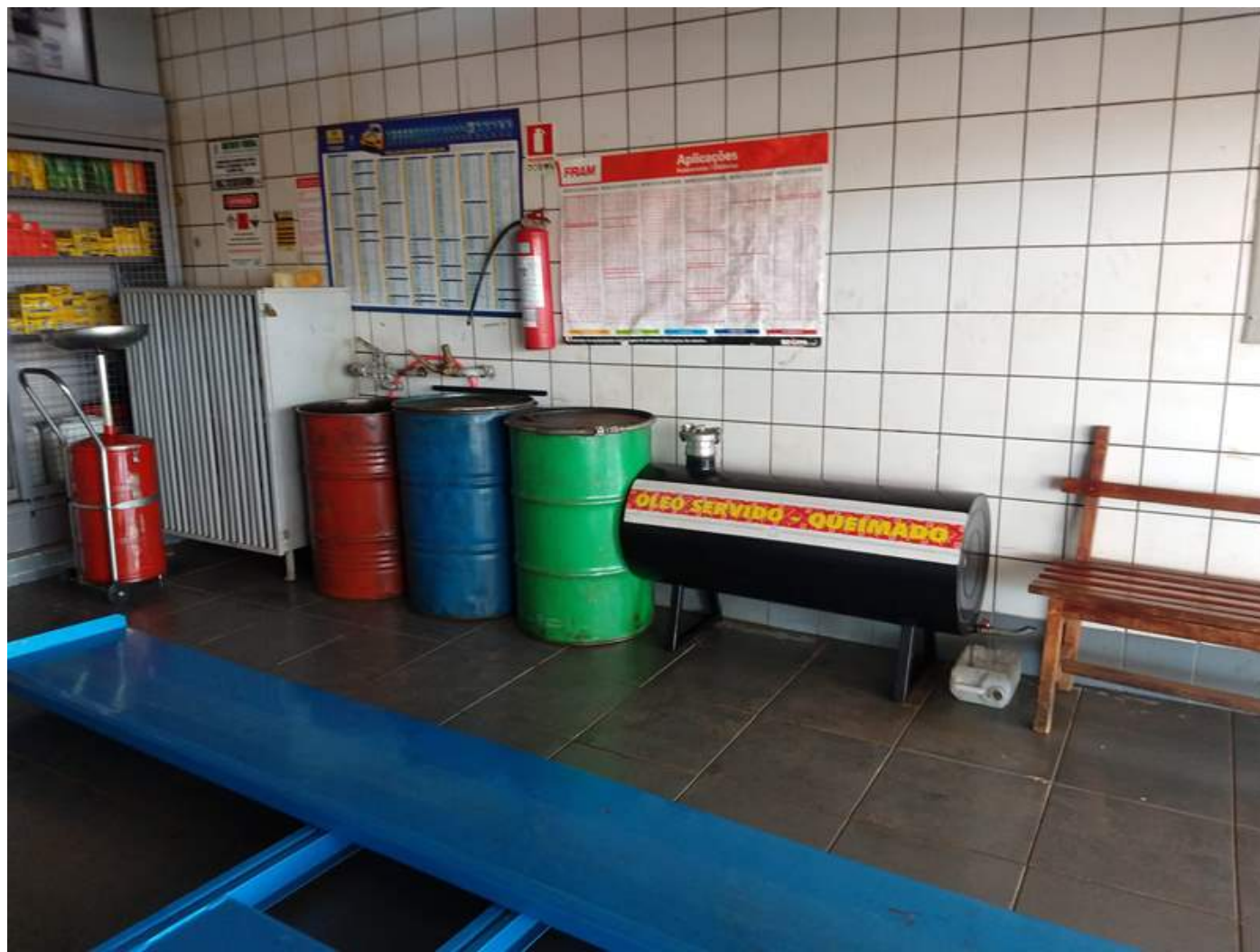
Figura 22 - Tanque de OLUC e resíduos Classe I, armazenados em local coberto e cercados por canaletes direcionados ao sistema separador. Na ocasião foi realizado o teste de corantes que comprovou a ligação da área com o sistema separador.
