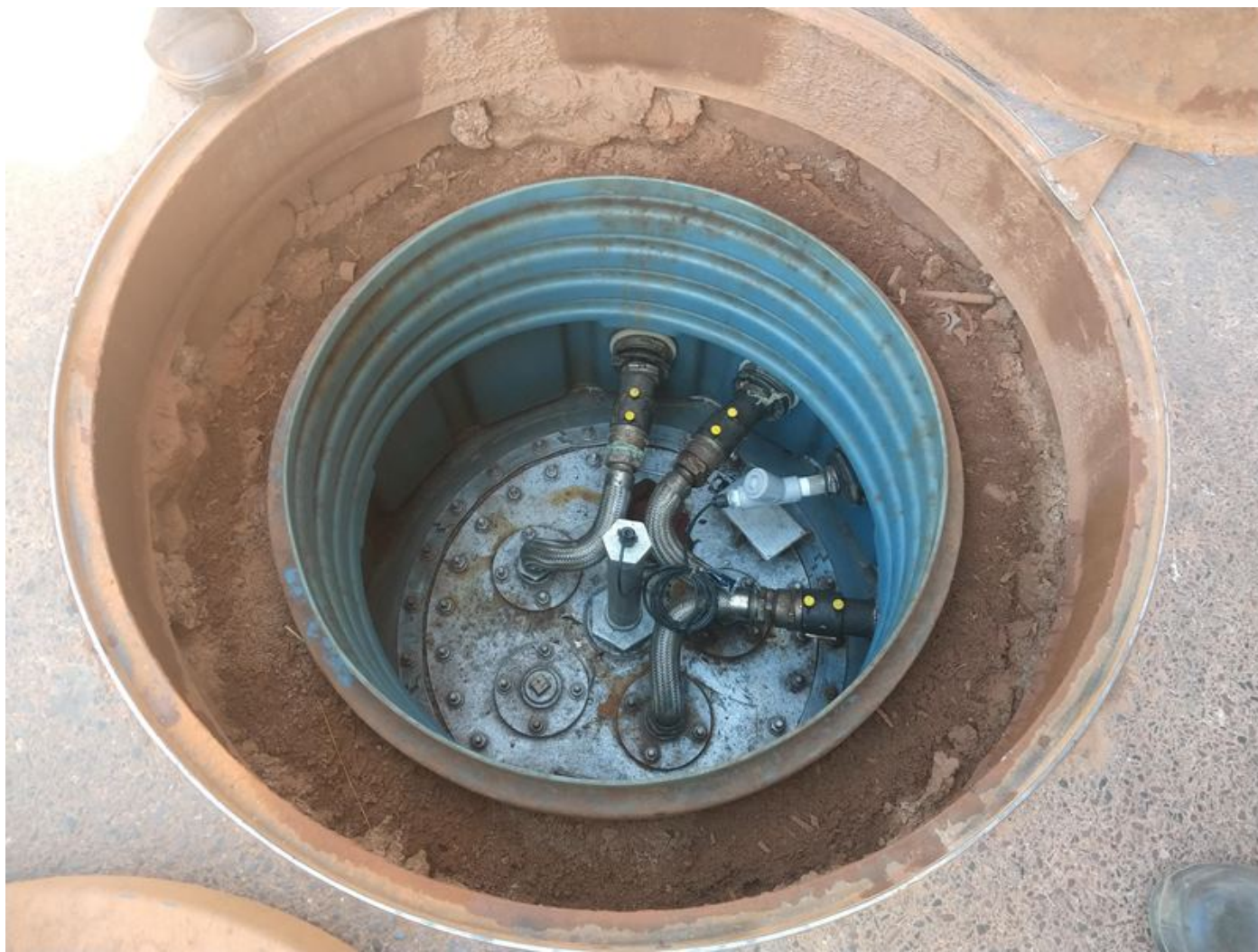
Figura 04 - Câmara de contenção do acesso a boca de visita do tanque, observa-se boa manutenção, tubulações em PEAD e controle de estoque eletrônico instalado.
