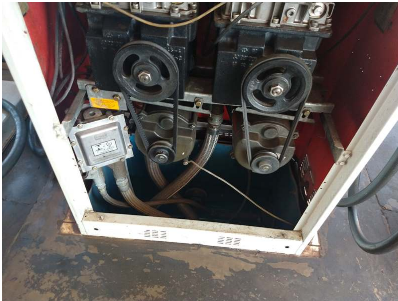
Figura 13 - Interior da unidade abastecedora, observa-se boa manutenção do equipamento.
