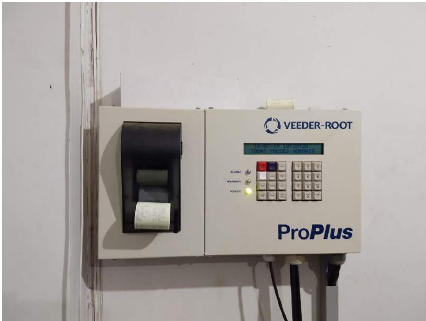
Figura 23 - Sistema de monitoramento ambiental e controle eletrônico de estoque, na ocasião foi emitido relatório comprovando o funcionamento dos sensores intersticiais.
