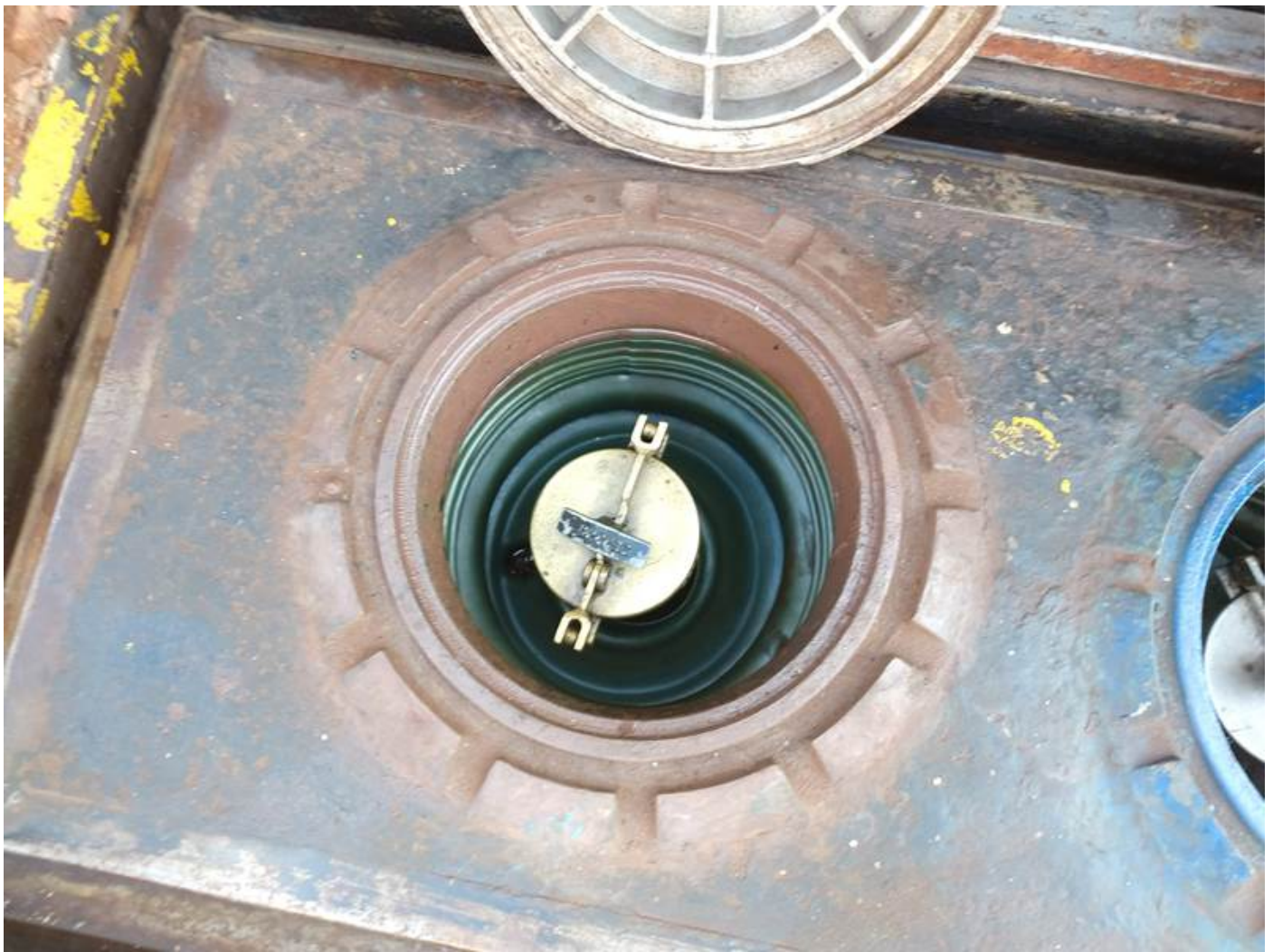
Figura 08 - Descarga selada à distância, dotada de câmara de contenção, observa-se boa manutenção do equipamento.
