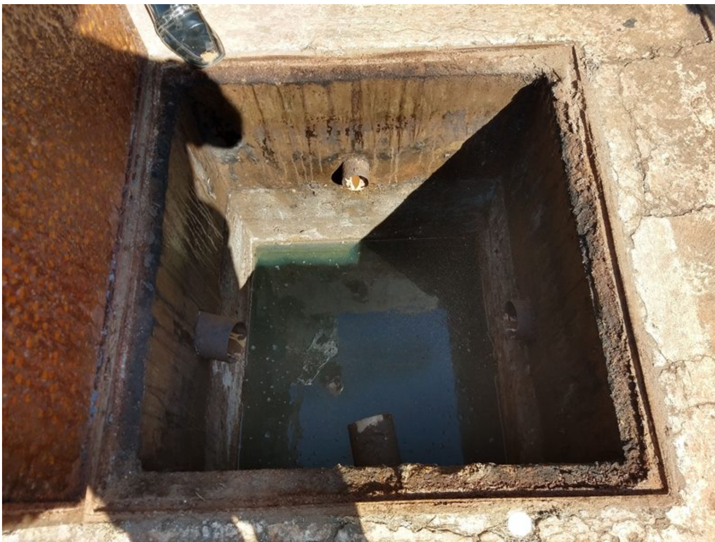
Figura 17 - Caixa de passagem desativada.
