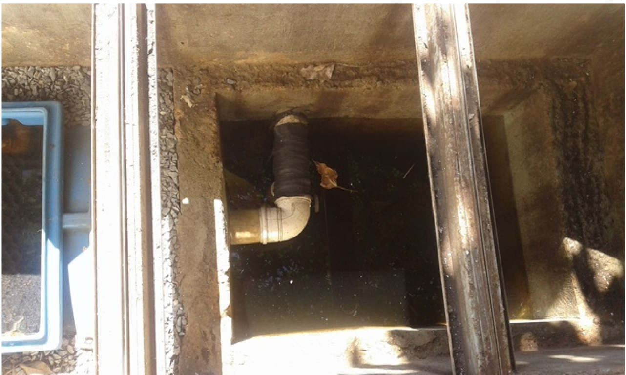
Figura 21: Caixa de inspeção do S.A.O. da pista de abastecimento com boa manutenção.
