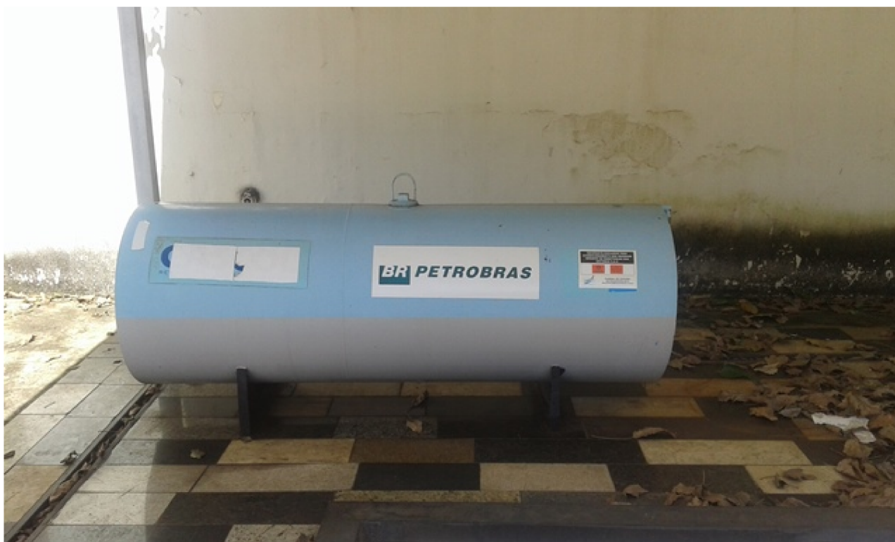
Figura 15: Tanque aéreo de OLUC em área coberta e contido entre canaletas.
