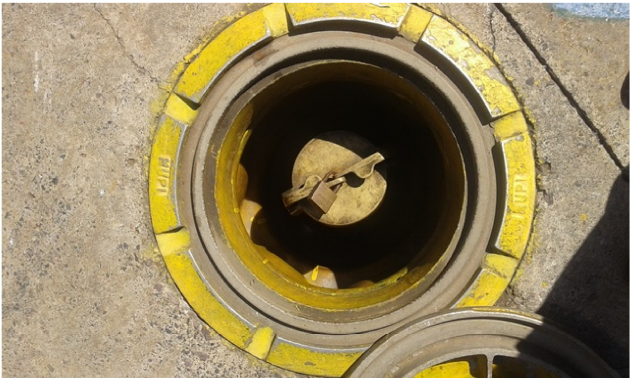
Figura 6: Descarga selada á distância com boa manutenção.
