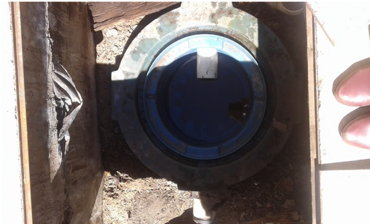
Figura 16: Caixa de areia do S.A.O desativado da antiga área de lavagem.
