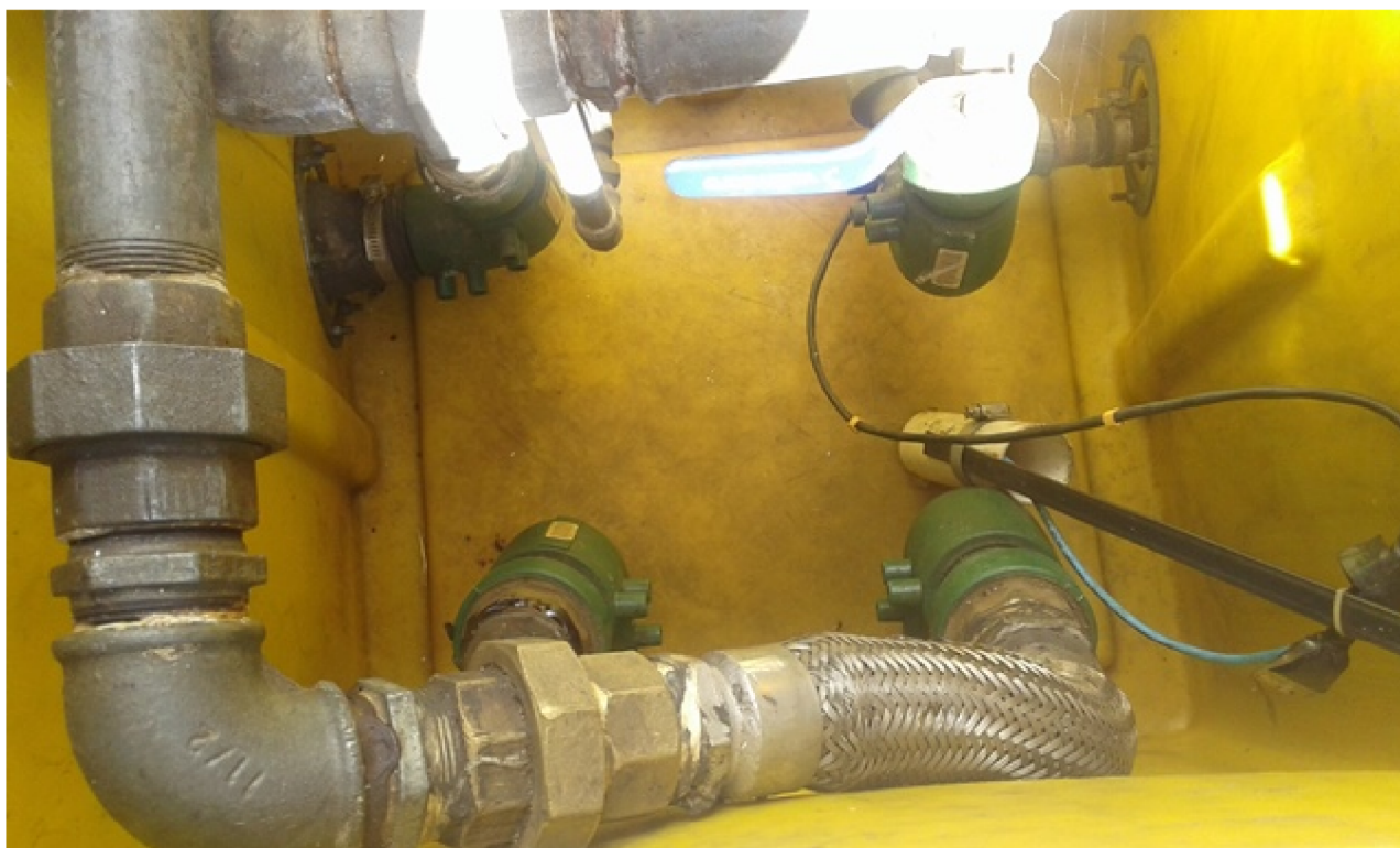
Figura 12: Câmara de contenção do filtro de diesel com boa manutenção.
