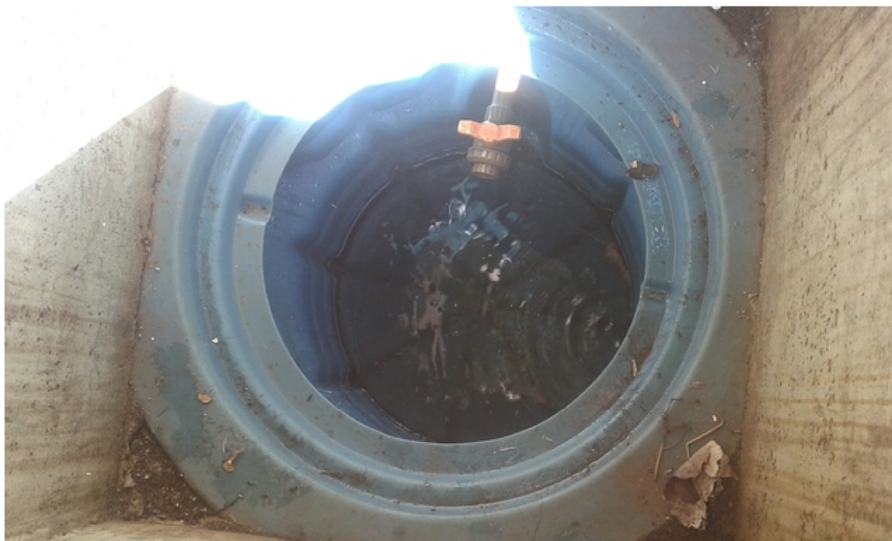
Figura 22: Caixa de amostragem do S.A.O. da pista de abastecimento com boa manutenção.
