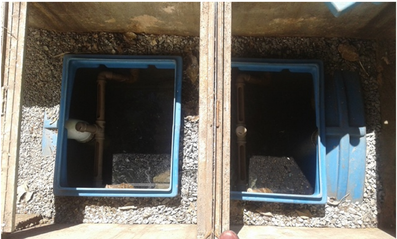
Figura 20: Caixa separadora de água e óleo do S.A.O. da pista de abastecimento com boa manutenção.
