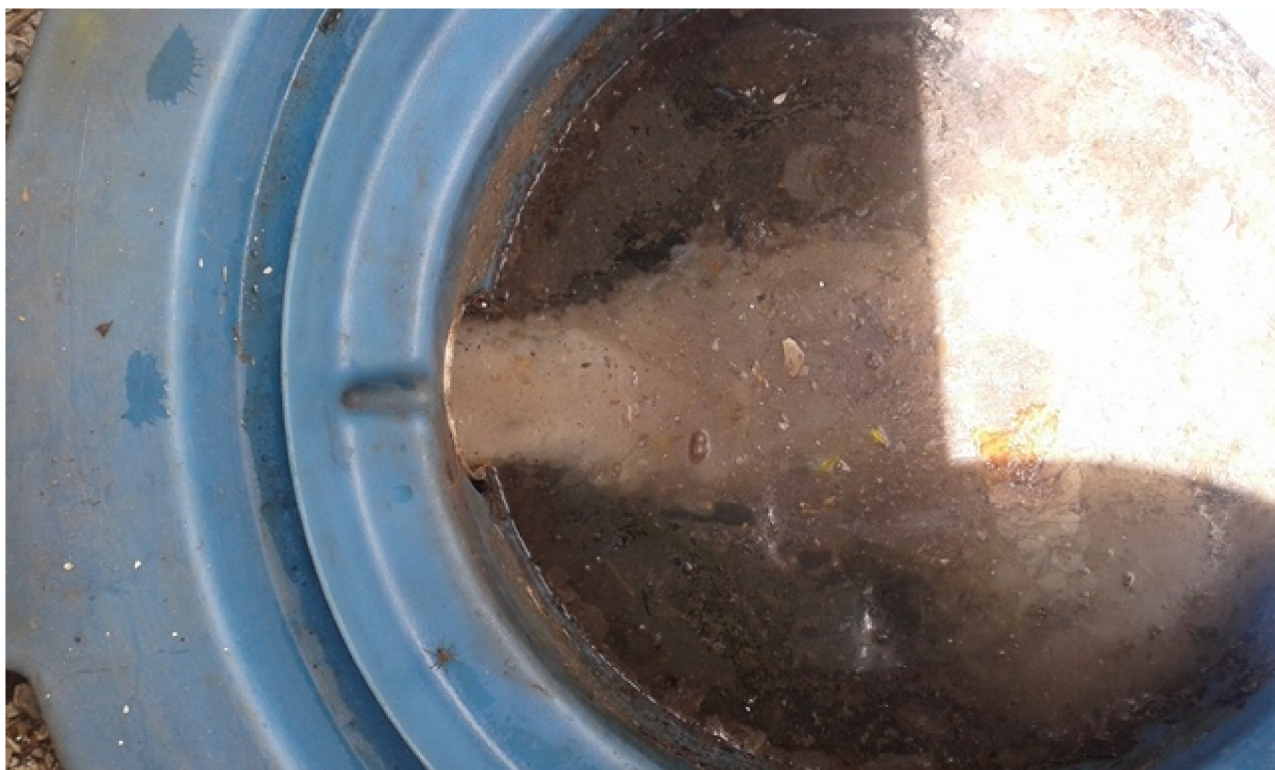
Figura 19: Caixa de areia do S.A.O. da pista de abastecimento. Nota-se o teste com corante, comprovando a drenagem dos canaletos da pista para este sistema.
