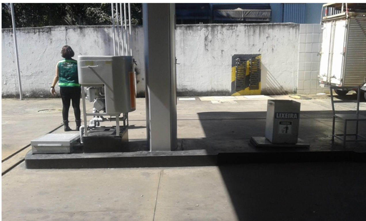
Figura 11: Filtro de Diesel com câmara de contenção e sem unidade abastecedora.
