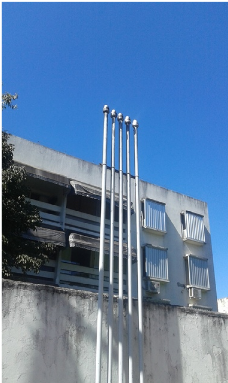
Figura 7: Conjunto de cinco respiros com terminal corta-chamas.
