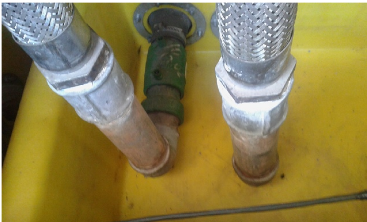
Figura 10: Câmara de contenção da unidade abastecedora com boa manutenção.
