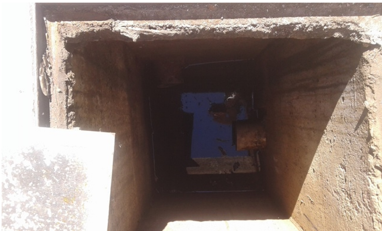
Figura 18: Caixa de amostragem do S.A.O. desativado da antiga área de lubrificação.
