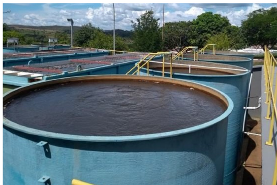
FOTO 2: Floculadores hidráulicos de seção circular
