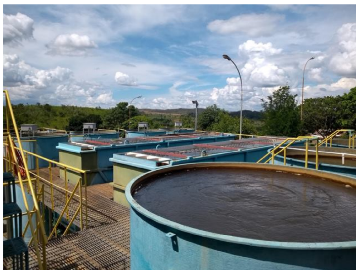
FOTO 5: Vista do floculador e decantadores
