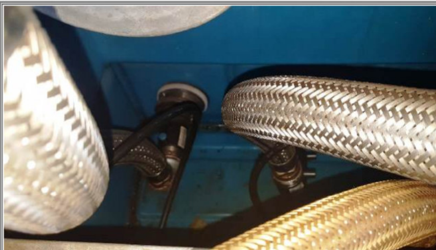
FOTO 1 - Sistema de contenção na bomba limpo em pleno funcionamento
