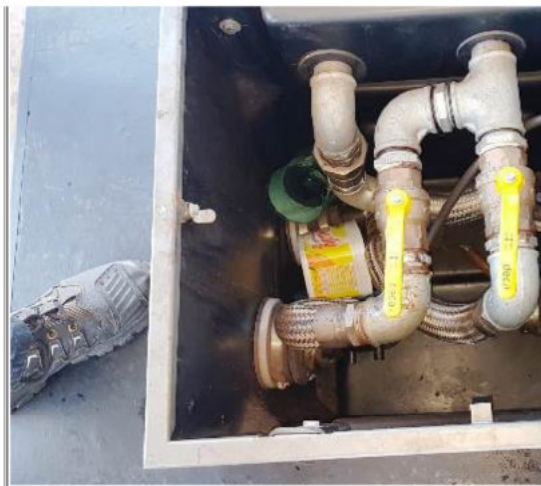
Foto 8 - Segundo SUMP do filtro de diesel
