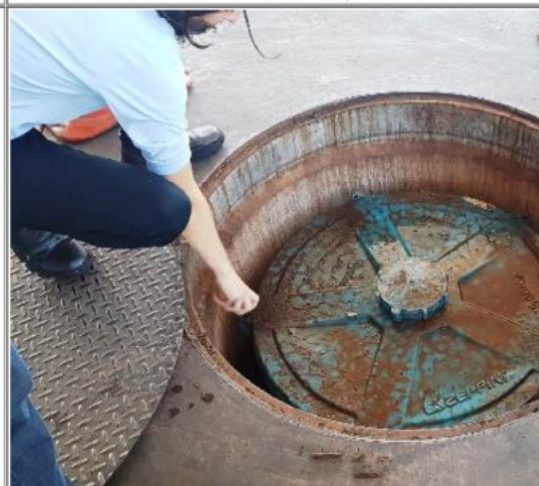
FOTO 4 - Câmara sobre o tanque de diesel com tampa para evi superior do tanque
