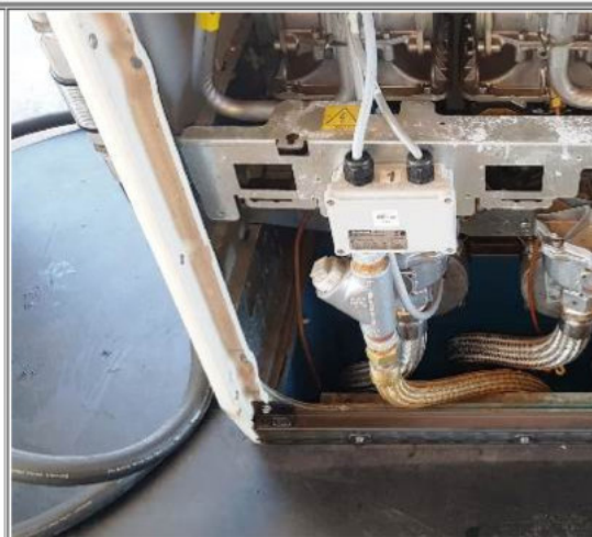
FOTO 2 - caixa contendo toda a tubulação da bomba
