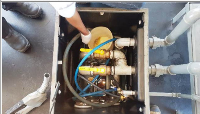
FOTO 3 - SUMP do primeiro filtro de diesel em funcionamento e com os vasilhames para coleta em caso de derramamento de ARLA
