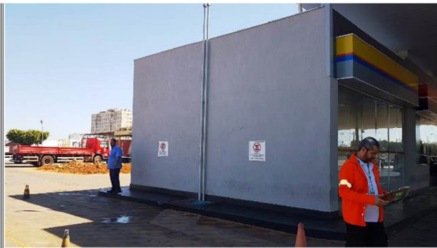
Foto 7 - suspiros com corta chamas de diesel, ao fundo local da retirada dos tanques antigos.
