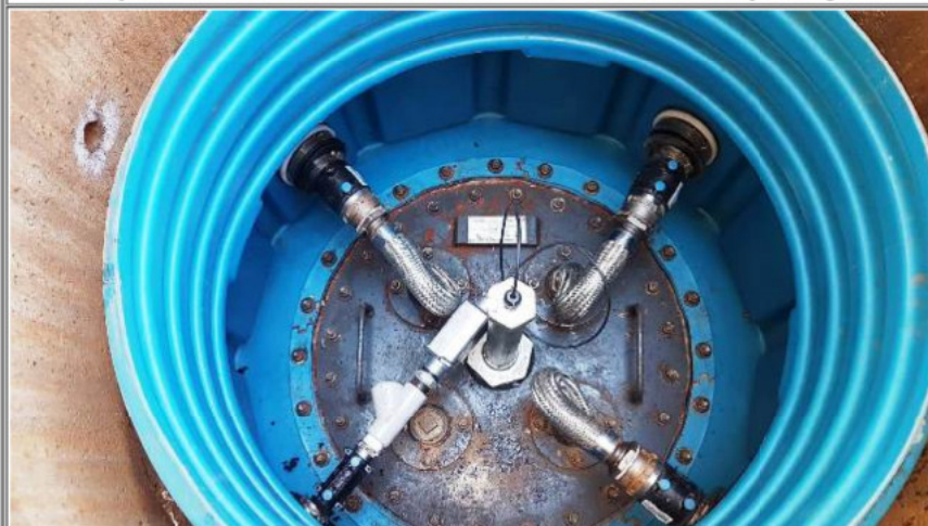
Foto 9 - Camara sobre o tanque limpa e com placa que confirma a fabricação 2018
