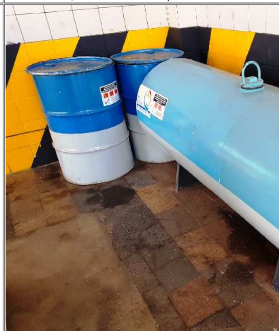
Foto 12 - tanque de oluc e tambores de segregação de resíduos c
