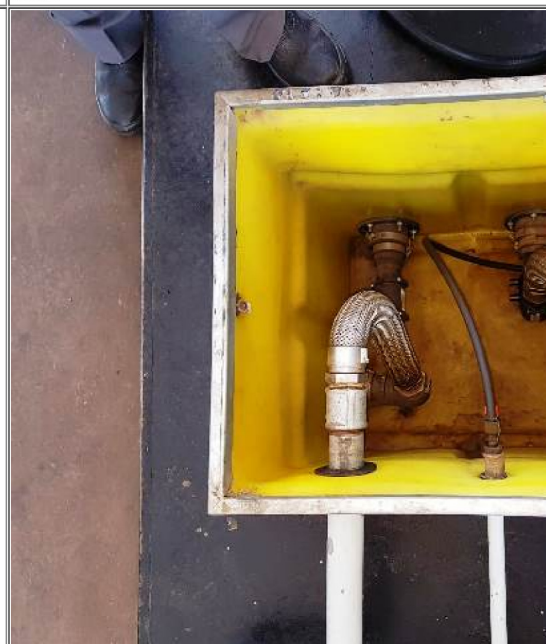
Foto 6 - SUMP do filtro de diesel adequado
