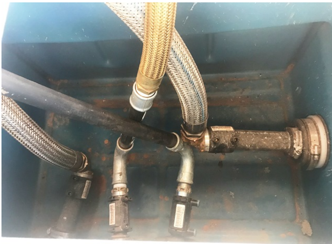
Figura 5 - Detalhe interno da Câmara de contenção de uma das Unidades Abastecedoras do SASC. Observa-se que a tubulação está totalmente contida no sump da câmara de contenção no dispositivo de segurança. Os sumps das demais unidades necessita de manutenção operacional diária conforme exige a ABNT NBR 15594-3:2008 tabela 1
