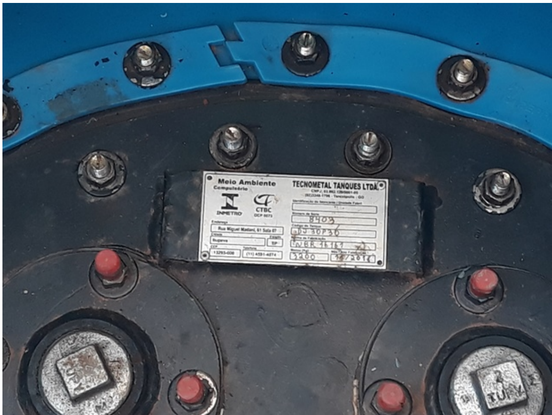
Figura 12 - Placa de identificação datado de 12/2018 de um dos SASC.
