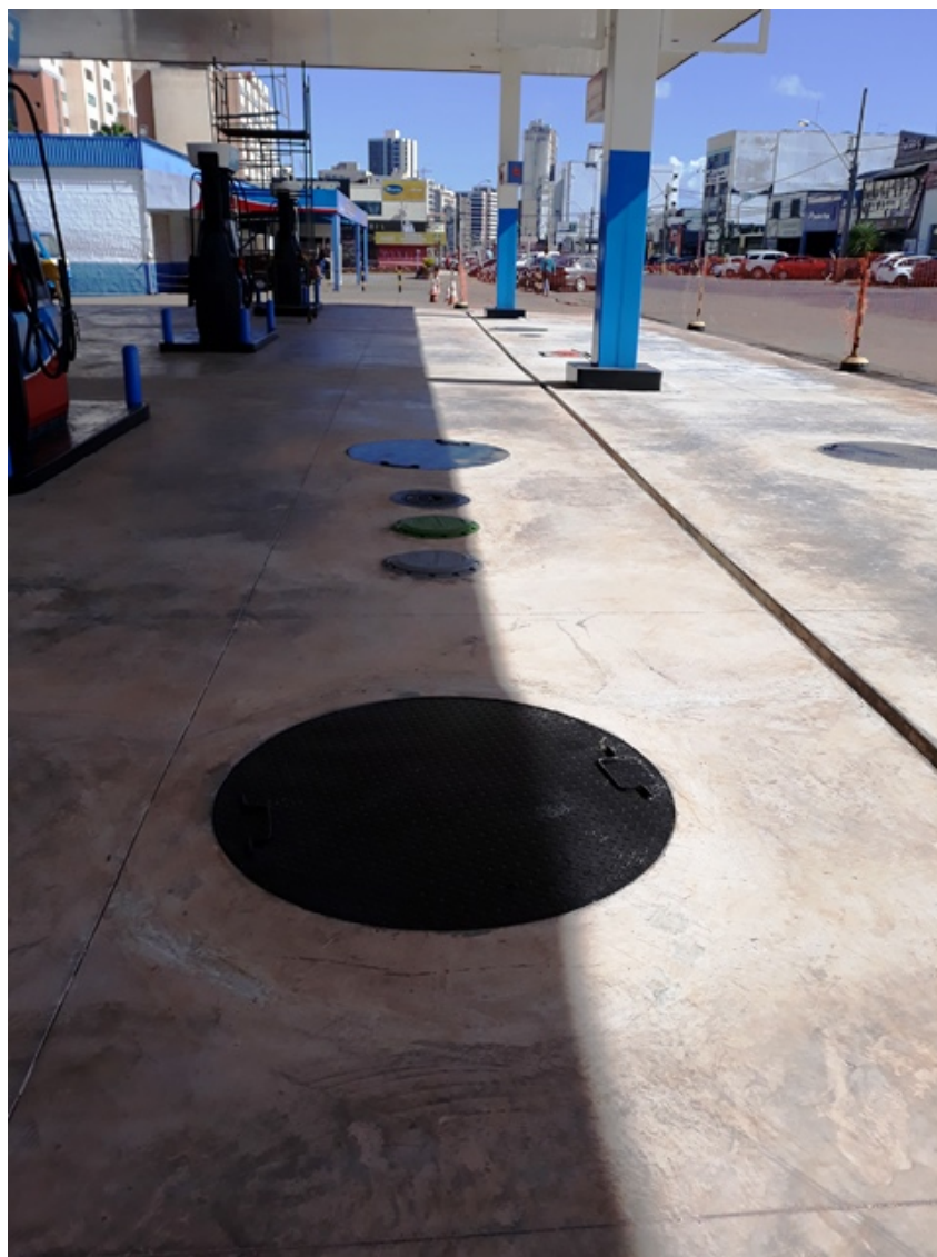
Figura 11 - Aspecto da área de tancagem do SASC tanque bipartido com capacidade de 30 m 3 .
