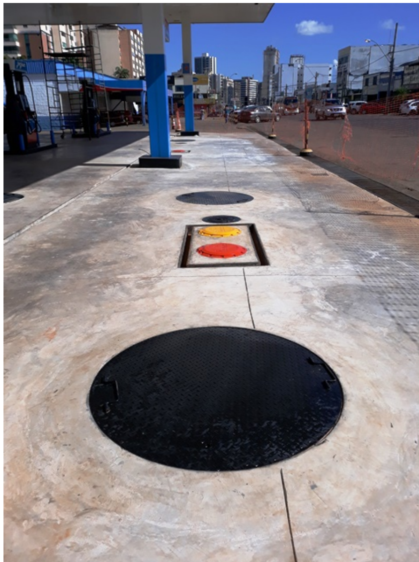
Figura 12 - Aspecto da área de tancagem do SASC tanque bipartido com capacidade de 30 m 3 .
