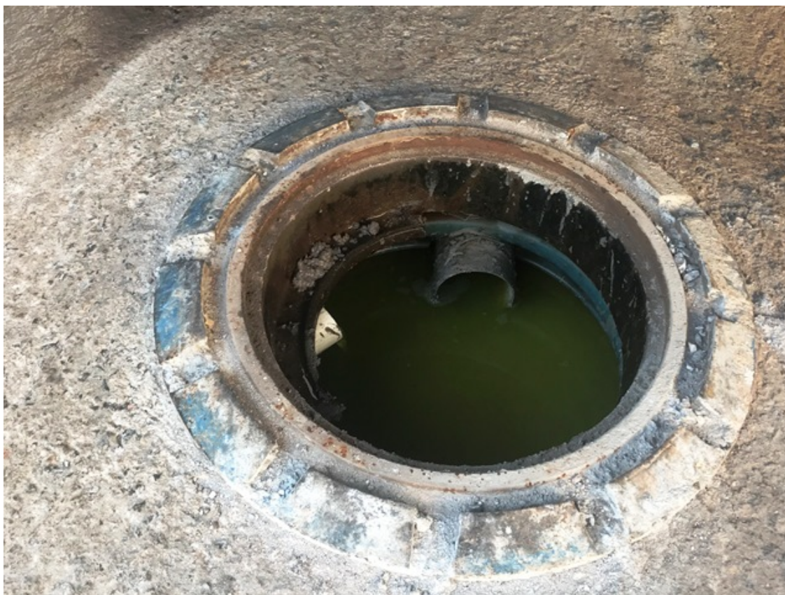
Figura 23 - Aspecto da Caixa de areia da área de lubrificação e manutenção de Veículos. O sistema quando entrar em operação deverá realizar manutenção operacional semanal conforme exige a ABNT NBR 155943:2008 tabela 1.
