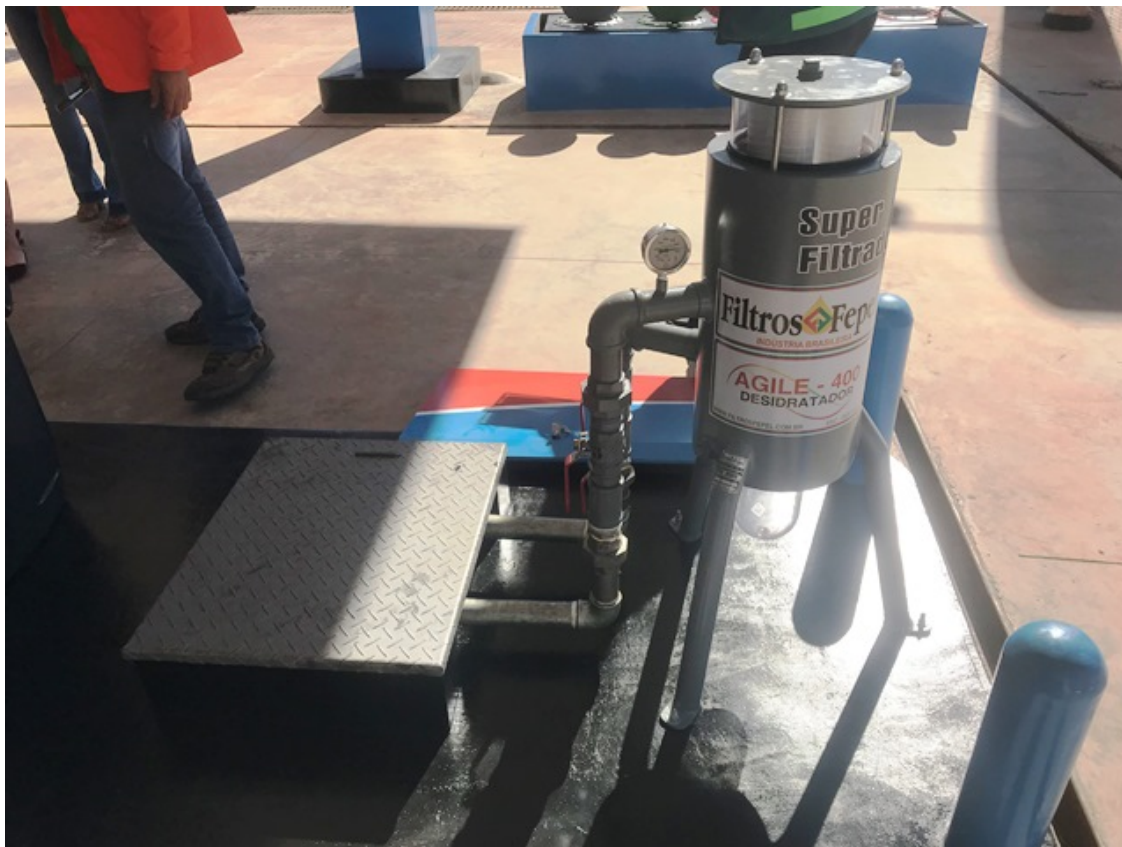
Figura 6 - Aspecto do Filtro desidratador .
