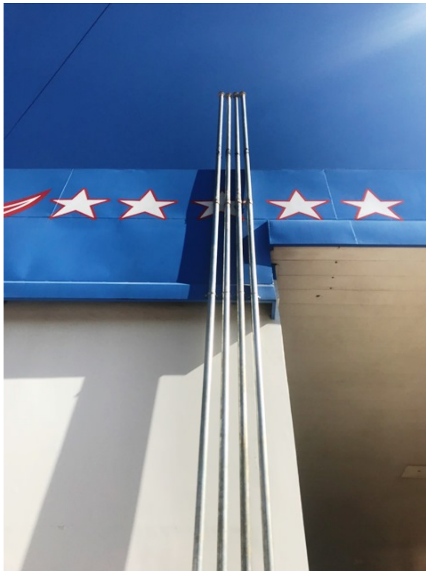
Figura 9 - Respiros com terminal corta chamas em conformidade com o que é exigido na ABNT NBR 13783:2014 item 8.3.4.
