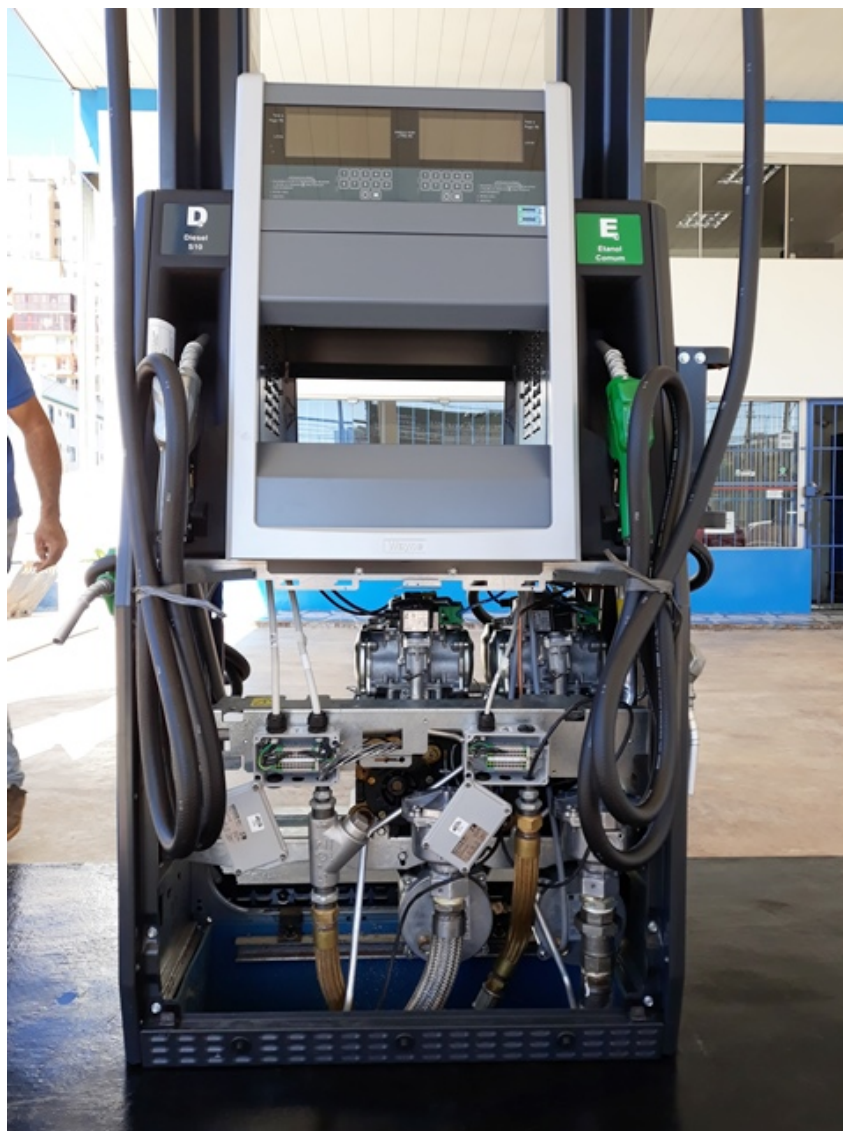
Figura 3 - Unidade abastecedora de Gasolina Comum, Diesel e Etanol com o dispositivo de segurança check-valve, observa-se que a tubulação está limpa e totalmente contida na câmara de contenção para unidade da bomba. A unidade necessita de manutenção operacional diária conforme exige a ABNT NBR 15594-3:200 tabela 1.
