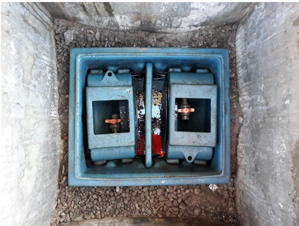
Figura 21: Caixa separadora de água e óleo do S.A.O.da pista de abastecimento.
