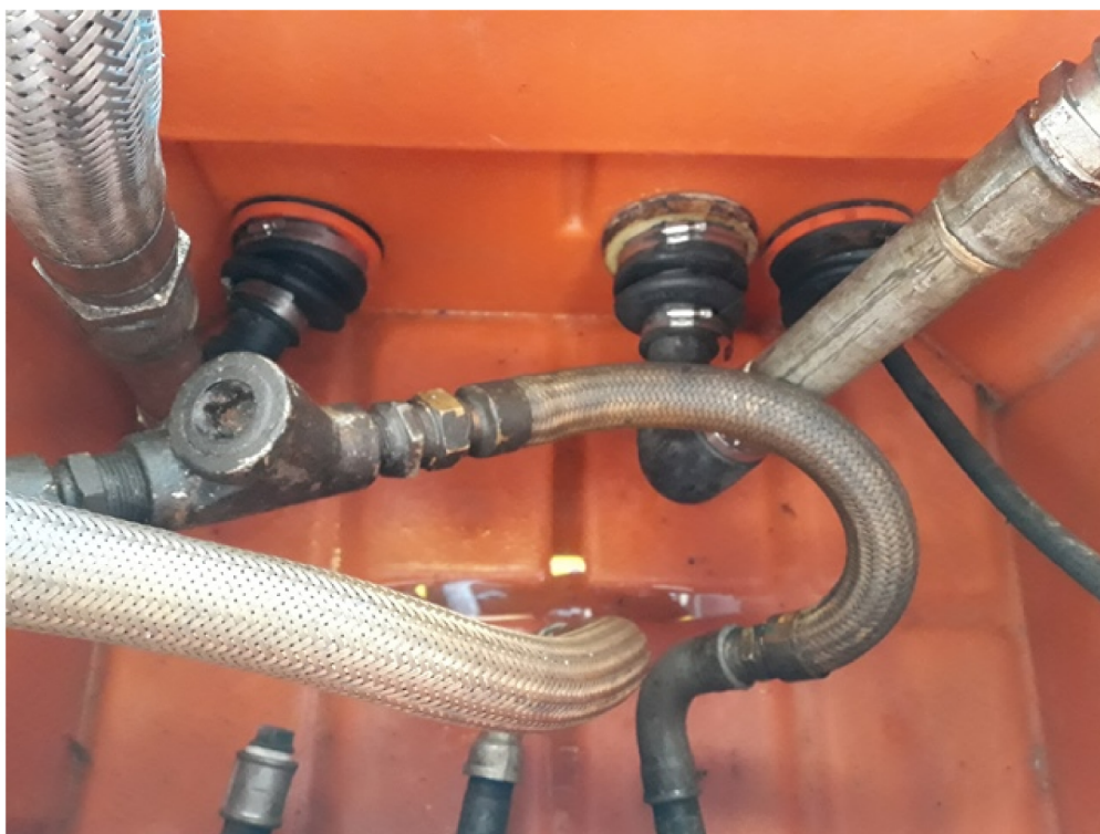
Figura 16: Câmara de contenção da unidade abastecedora com boa manutenção.
