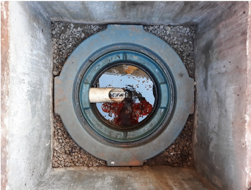
Figura 20: Caixa de areia do S.A.O. da pista de abastecimento com boa manutenção e com drenagem comprovada através do teste com corantes.
