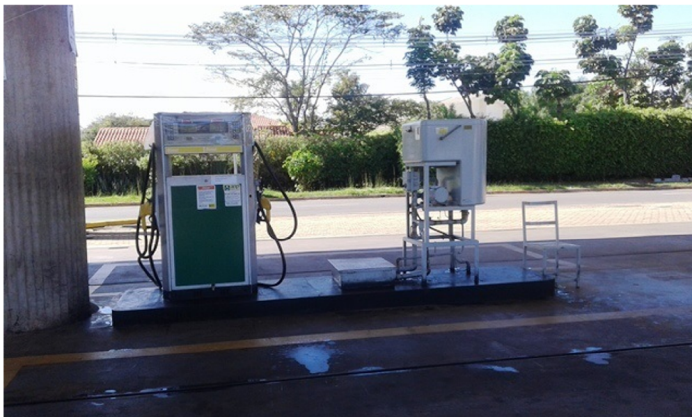
Figura 12: Ilha com unidade abastecedora de diesel, com unidade filtrante e sua câmara de contenção.
