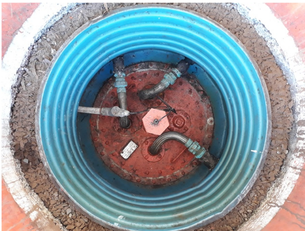
Figura 4: Aspecto da Boca de visita do tanque vistoriado, nota-se a boa manutenção e controle de estoque conforme exige a ABNT NBR 15594-3:200 tabela 1.
