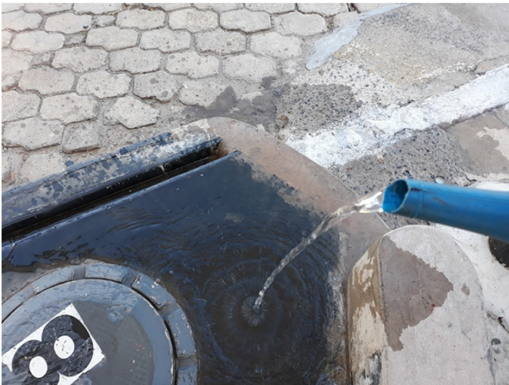
Figura 8: Aspecto da lateral da área da descarga selada à distância. Nota-se que os canaletes não contemplam toda a área.
