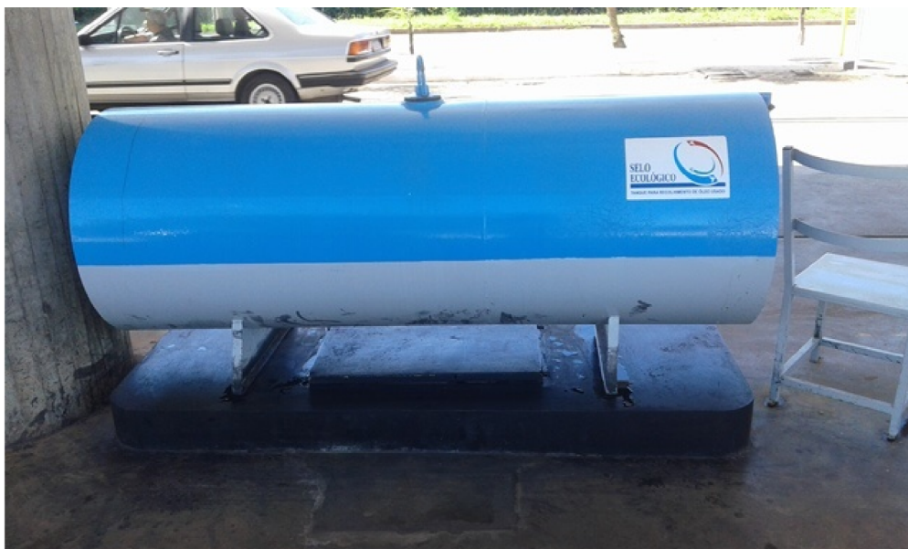
Figura 17: Ilha com Tanque de OLUC, em área coberta e contemplada por canaletas ligados ao S.A.O.
