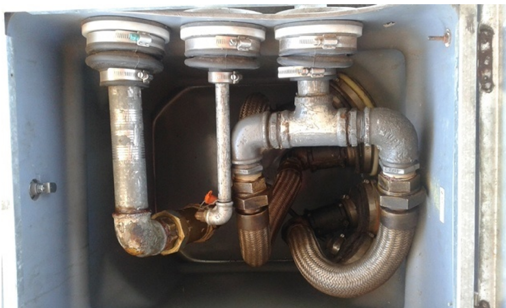
Figura 13: Câmara de contenção do filtro de diesel com boa manutenção.
