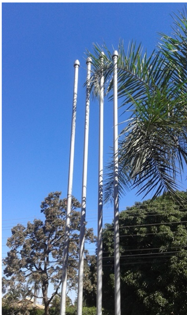
Figura 9: Conjunto A de respiros com terminal corta-chamas. Nota-se a presença de indivíduo arbóreo próximo aos terminais dos respiros, em desacordo com o item 8.3.3 da ABNT NBR 13783:2014.
