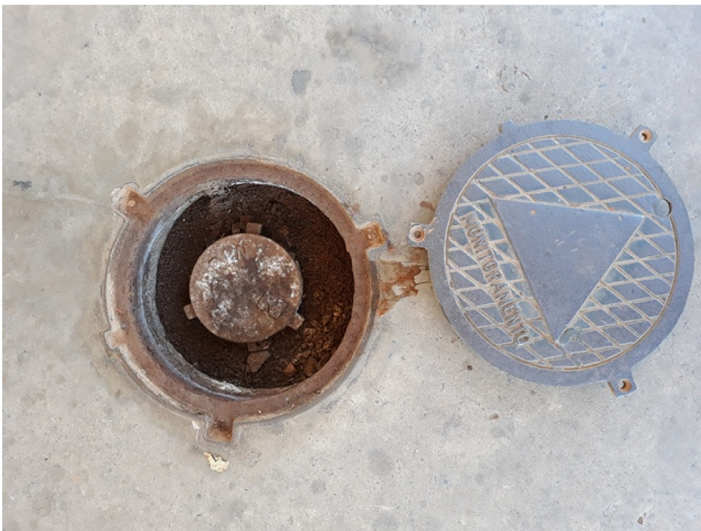
Figura 23: Detalhe de um Poço de monitoramento ambiental.
