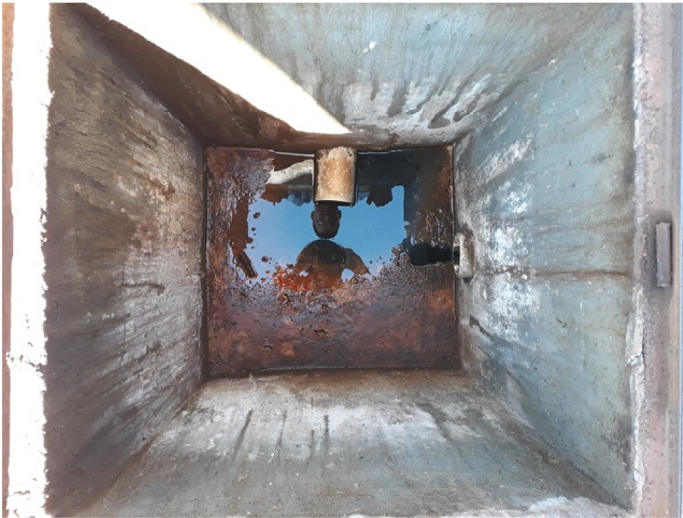
Figura 22: Aspecto da caixa de amostragem de efluentes. Observa-se a necessidade de manutenção periódica constante conforme exige a ABNT NBR 15594-3:200 tabela 1. .
