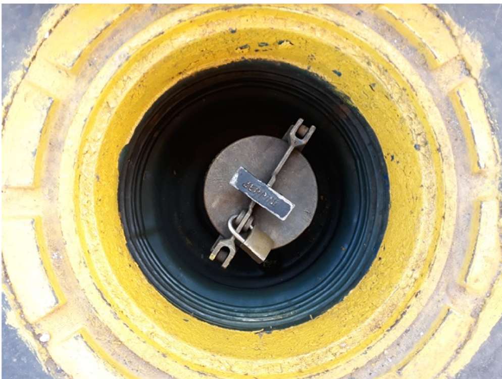
Figura 7: Aspecto de um dos 08 (oito) dispositivos da descarga selada à distância. Observa-se a manutenção adequada conforme exige a ABNT NBR 15594-3:200 tabela 1.
