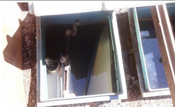
Foto 20 - Caixa separadora de água e óleo (SSAO área de lavagem).
