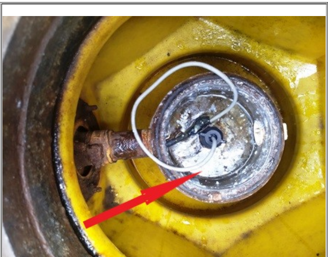
Foto 06 - Caixa de passagem do sensor intersticial com acúmulo de água.
