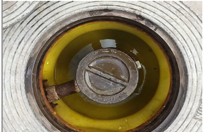
Foto 04 - Monitoramento intersticial. É notória a falta de manutenção.
