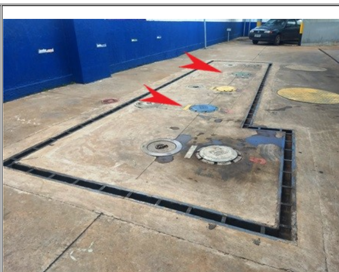
Foto 08 - Descargas seladas à distância (setas vermelhas). Área de descarga circundada com canaletes do SDO.
