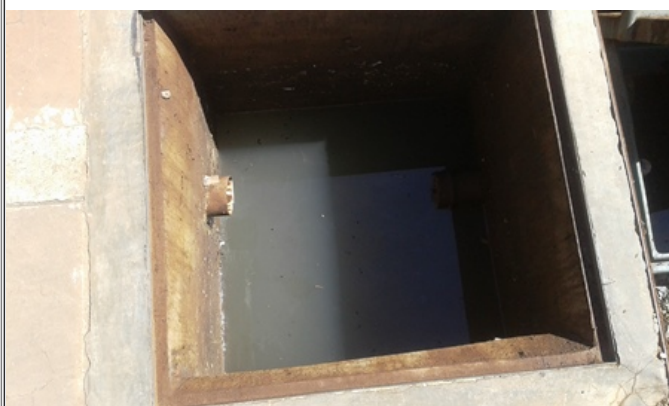
Foto 19 - Caixa de areia (SSAO área de lavagem).
