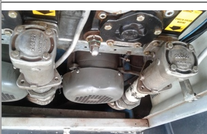
Foto 14 - Detalhe da unidade abastecedora. Nota-se que as tubulações não são contempladas pela câmara de contenção da unidade, estando em desacordo com norma vigente.
