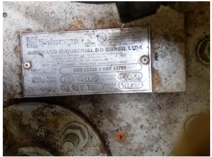
Foto 02 - Placa de identificação do tanque pleno de 15m 3 (03/2008).
