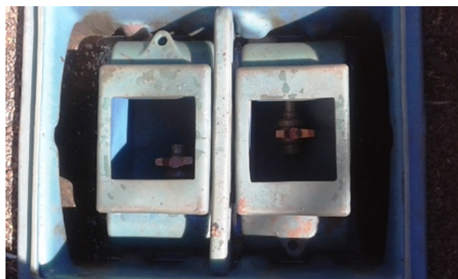
Foto 16 - Caixas de separação de água e óleo e de coleta de óleo (SSAO da pista de abastecimento).
