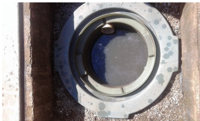
Foto 15 - Caixa de areia (SSAO da pista de abastecimento)
