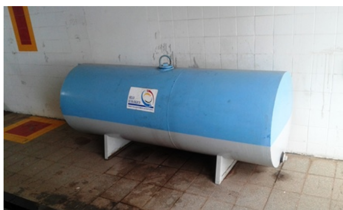
Foto 26 - Tanque aéreo de OLUC em local coberto e contemplado por canaletes.
