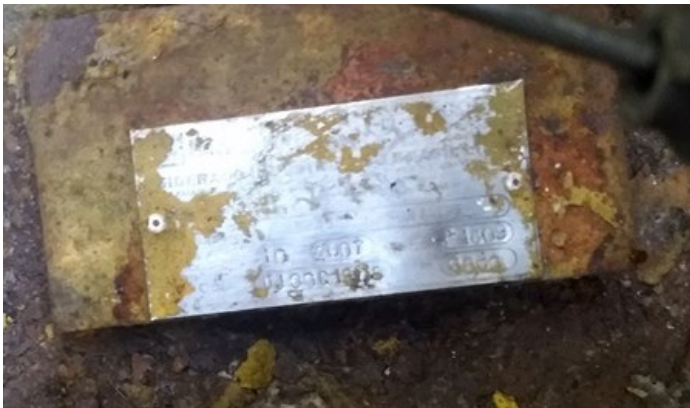
Foto 03 - Placa de identificação do tanque com ano de fabricação de 2007
