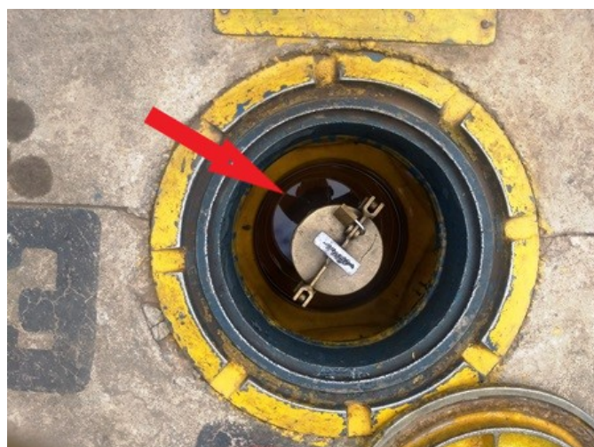
Foto 09 - Câmara de contenção da descarga selada sobre o tanque com acúmulo de efluente, indicando a falta de manutenção adequada.
