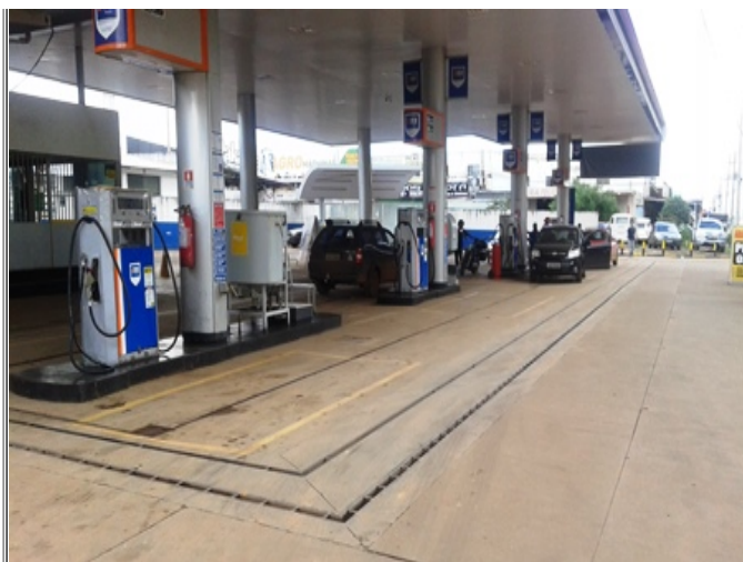
Foto 11 - Visão geral da pista de abastecimento.
