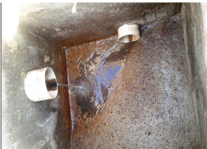
Foto 17- Caixa de amostragem (SSAO da pista de abastecimento).
