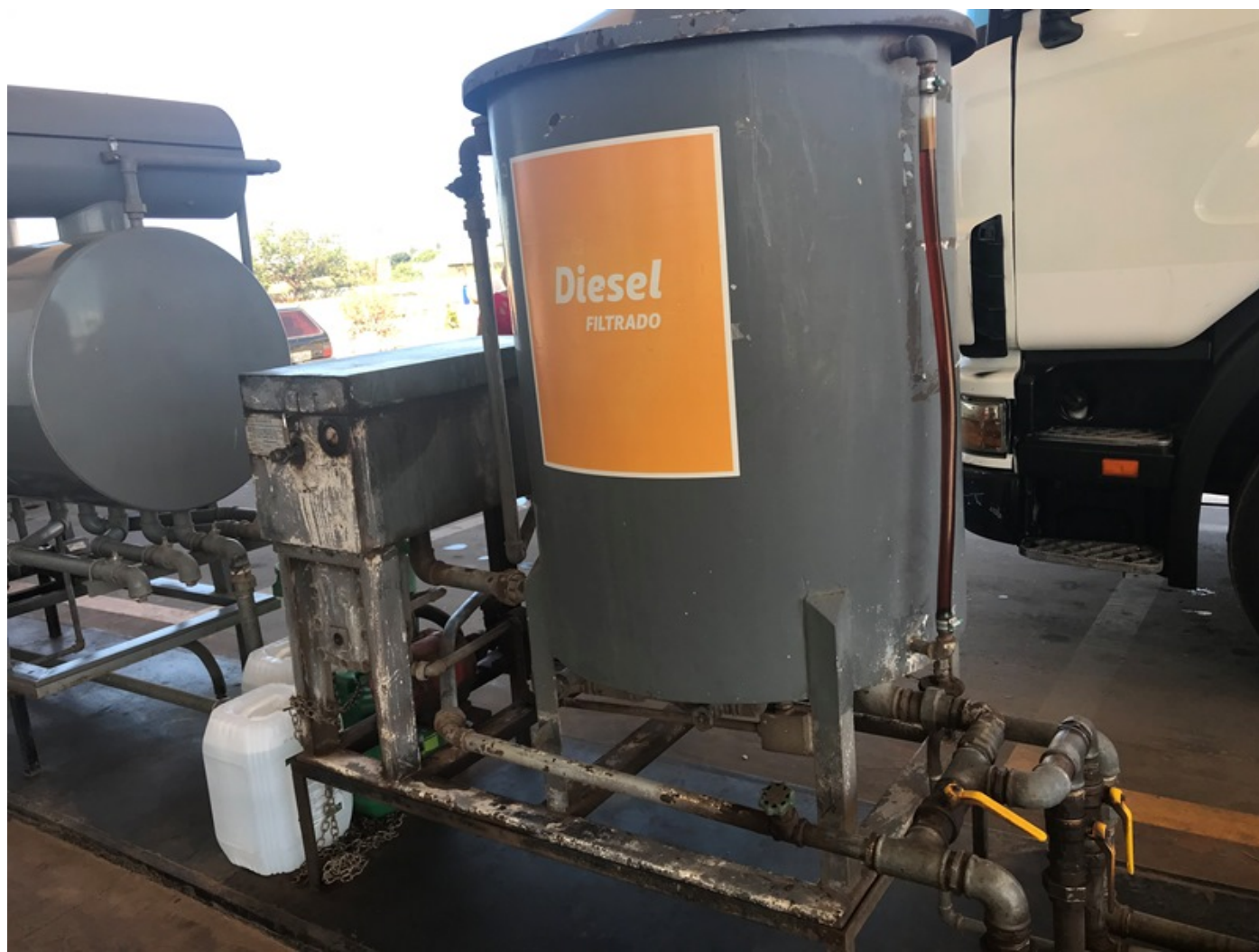
Figura 06 - Unidade de filtragem de diesel.
