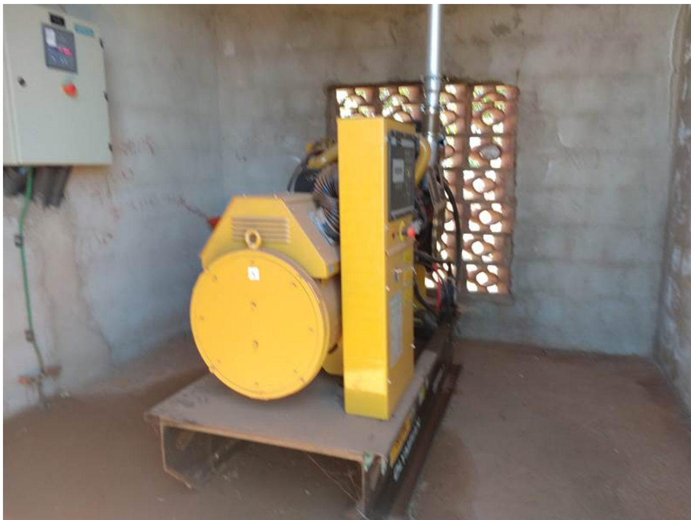
Figura 18 - Gerador de energia à diesel, segundo informações da responsável o abastecimento é realizado manualmente.
