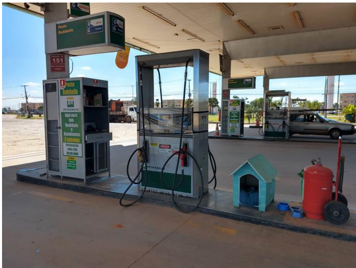
Figura 03 - Unidade de abastecimento.
