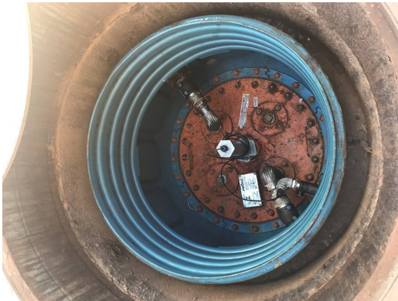
Figura 10 - Câmara de contenção da boca de acesso ao tanque, observa-se boa manutenção do equipamento.
