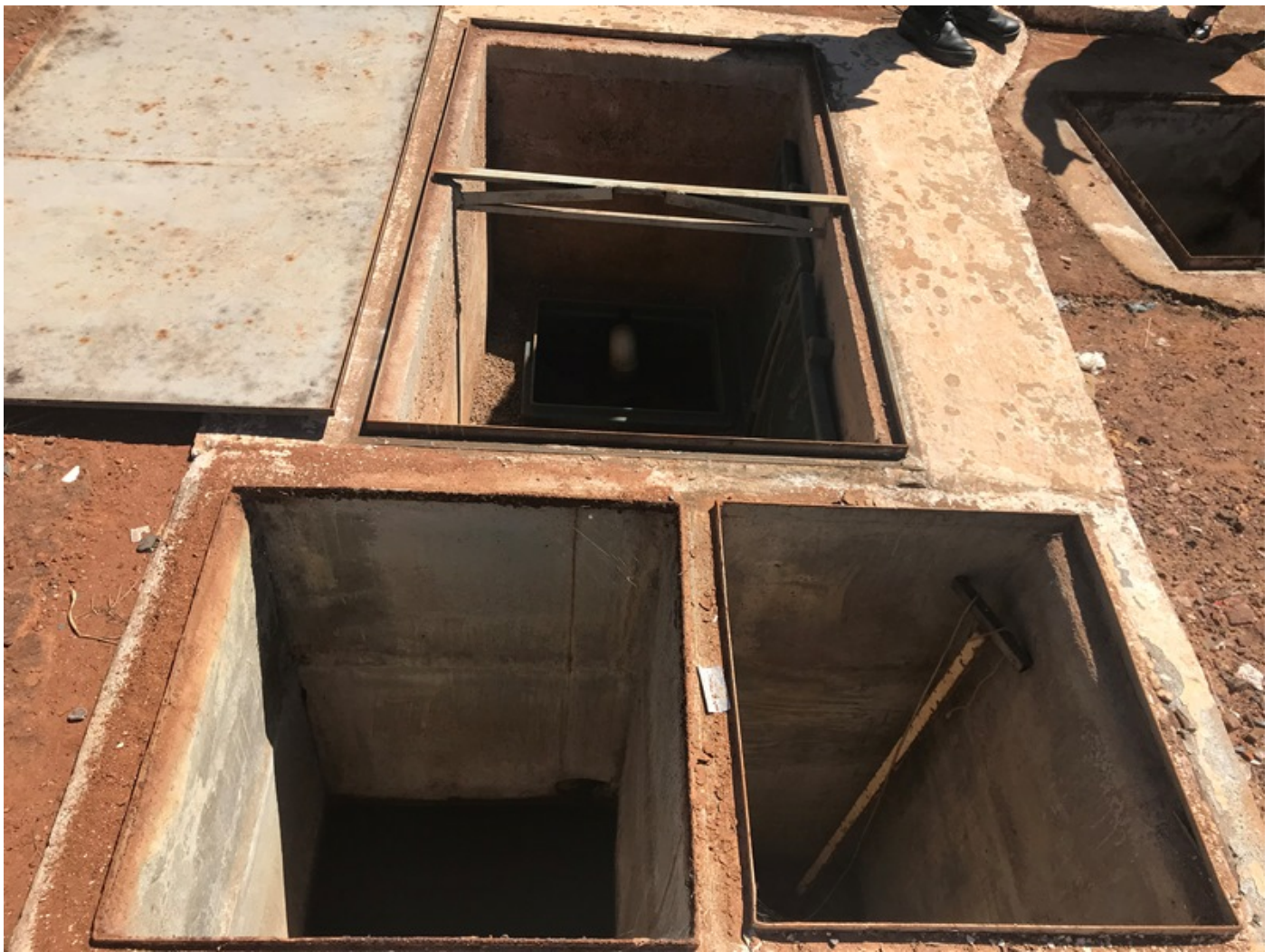
Figura 14 - Sistema separador de água e óleo.
