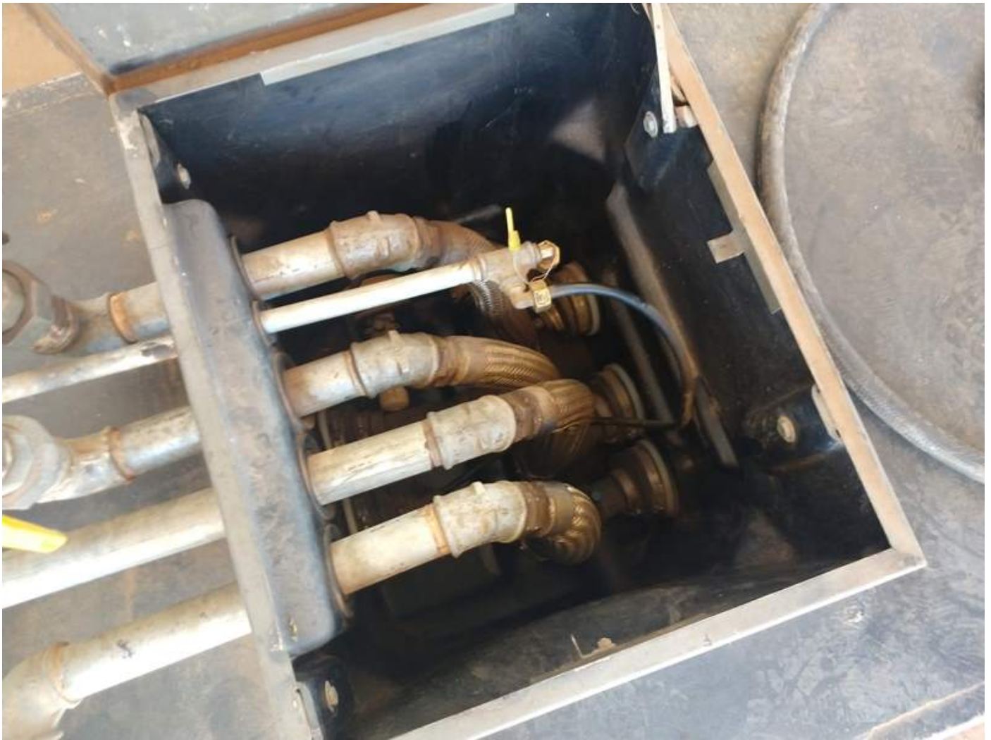
Figura 07 - Câmara de contenção da unidade de filtragem de diesel.
