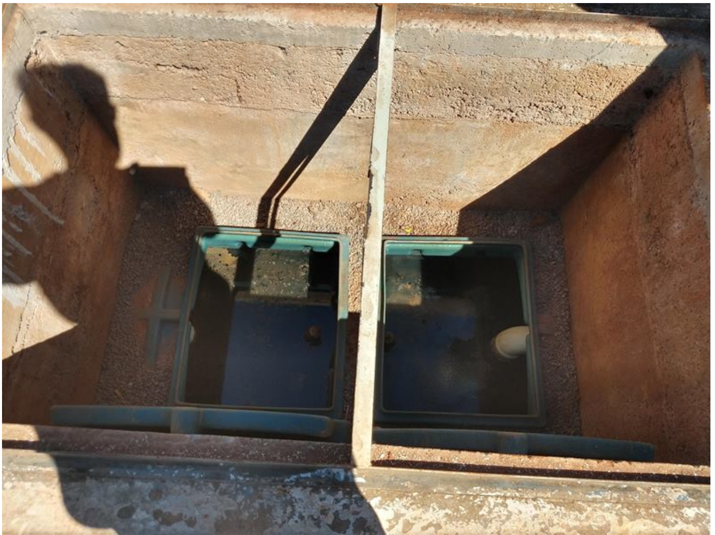
Figura 15 - Caixa separadora de água e óleo.
