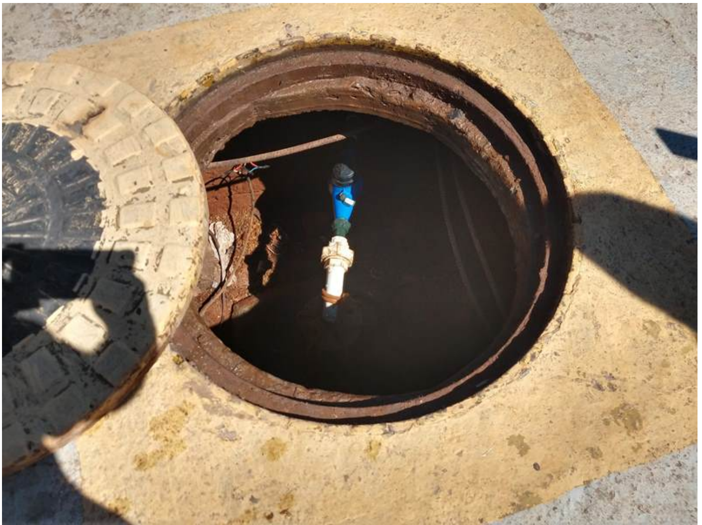
Figura 16 - Poço de captação de água subterrânea.
