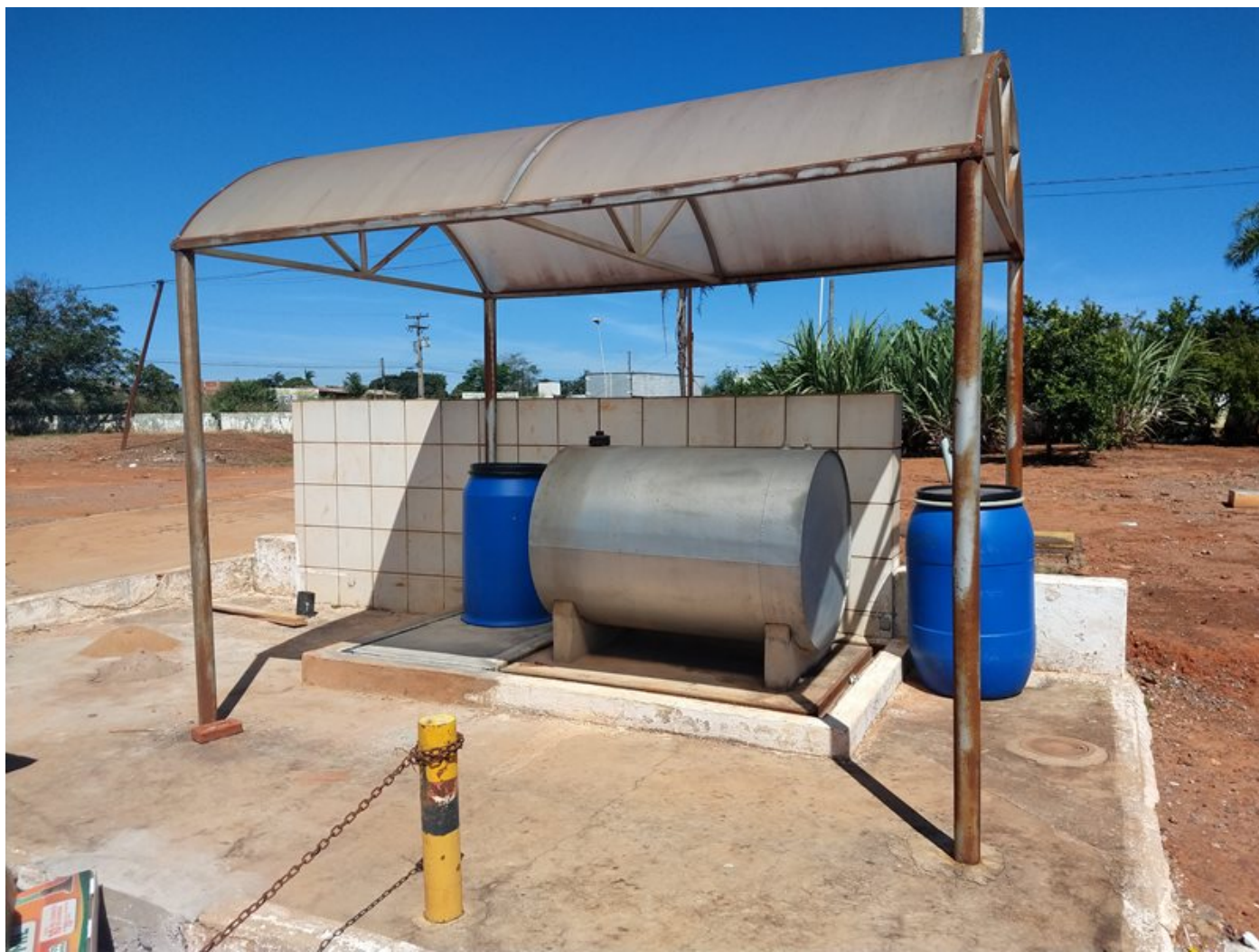
Figura 11 - Tanque aéreo destinado ao OLUC e armazenamento de resíduos perigosos - Classe I, em local coberto e cercado por canaletes direcionados ao sistema separador. Na ocasião foi observado que um dos compartimentos se encontrava fora da área destinada, sendo a responsável orientada pela equipe técnica para corrigir o posicionamento.
