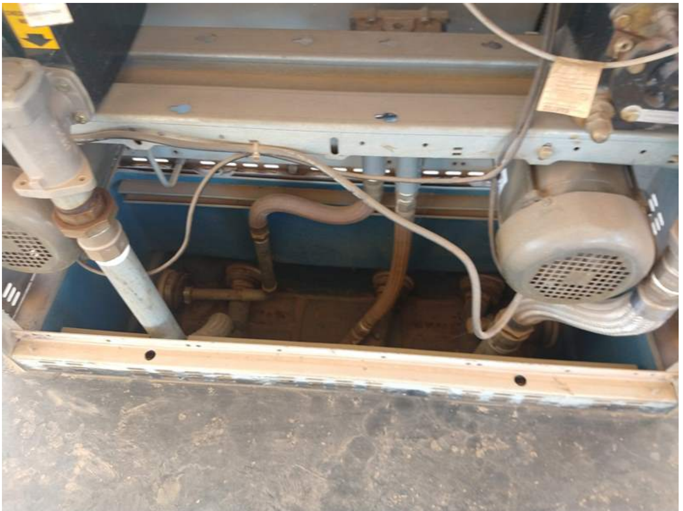
Figura 05 - Câmara de contenção da unidade de abastecimento, observa-se boa manutenção do equipamento.
