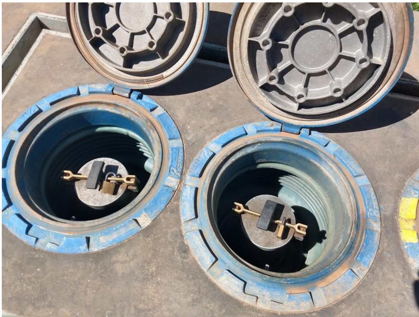
Figura 13 - Câmaras de contenção das descargas seladas a distância, observa-se boa manutenção dos equipamentos.
