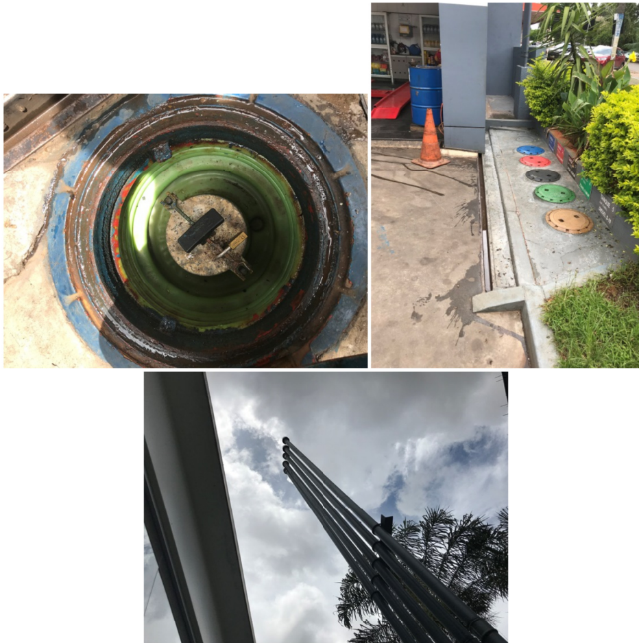
Foto 09 e 10: Descarga à distância com canaletas e boa manutenção.
