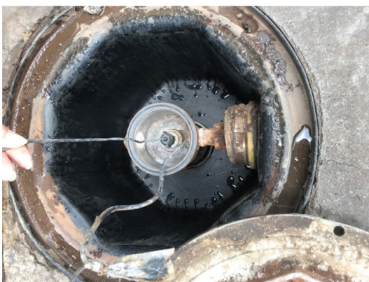
Foto 08: Monitoramento intersticial instalado.
