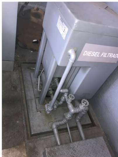
Foto 03: Filtro de diesel.
