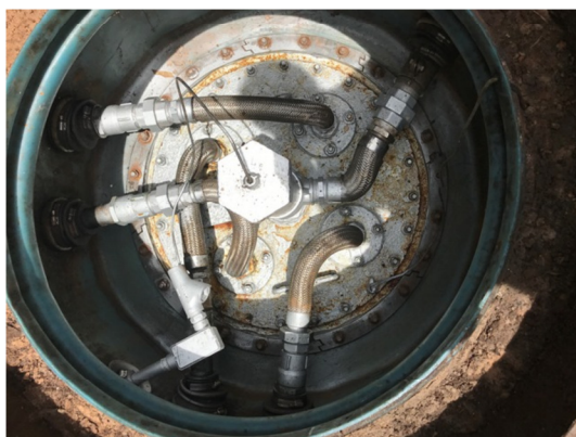
Foto 07: Câmara de contenção no acesso à boca de visita em bom estado.
