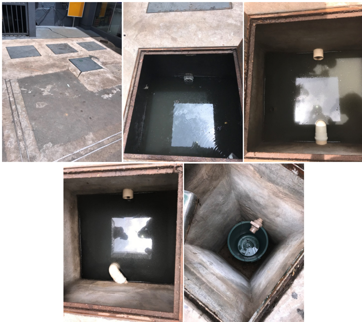
Foto 16: Vista geral do SAO. Sistema em alvenaria.
