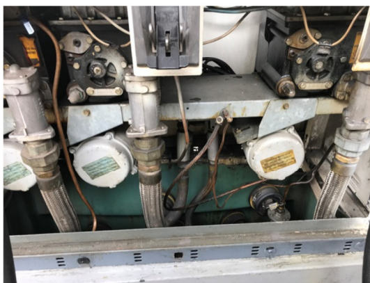
Foto 06: Sump de bomba em bom estado e check valve presente.
