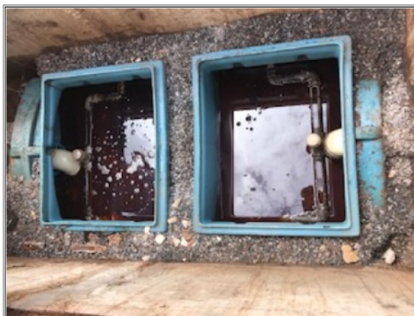
Foto 17. Caixa separadora de água e óleo (SAO 1)
