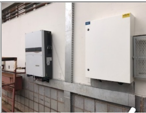
Foto 23. Quadro inversor de energia solar.
