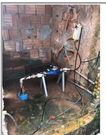
Foto 21. Captação de água subterrânea.
