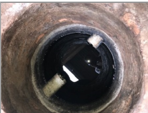
Foto 18. Caixa do SAO exclusivo da área de lubrificação.
