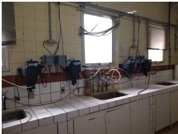
FOTO 1: Bombas dosadoras dos produtos químicos
