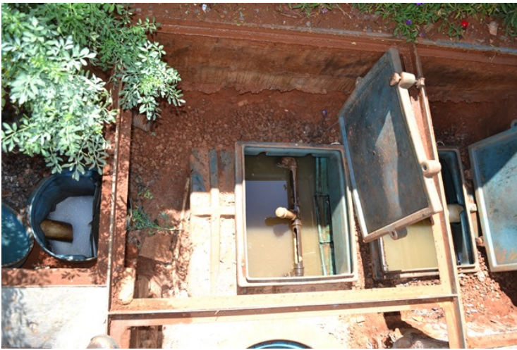
Foto 21 - Caixa separadora de água e óleo.
