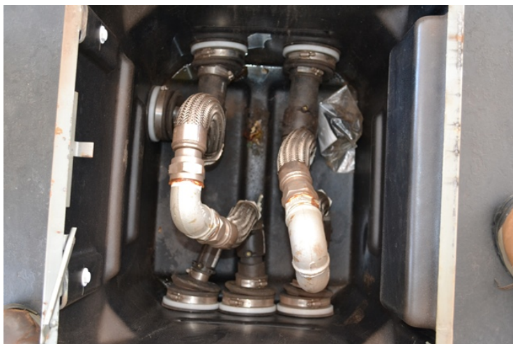
Foto 13 - Câmara de contenção do filtro de diesel, sem o filtro.
