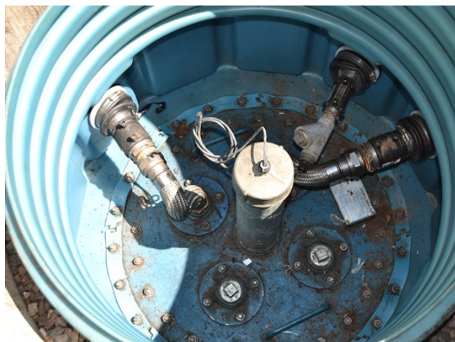
Foto 10 - Câmara de contenção do tanque subterrâneo, sem manutenção adequada.
