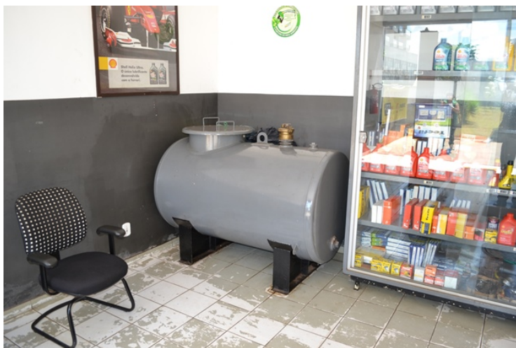
Foto 9 - tanque de OLUC em local adequado.
