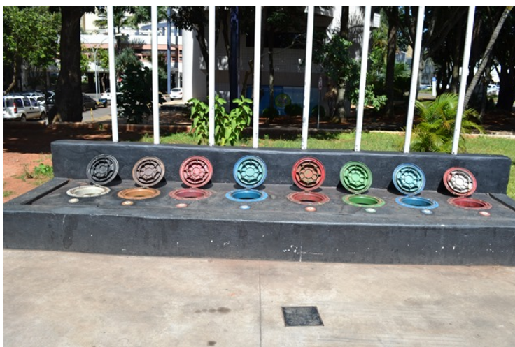
Figura 3 - Visão geral das descargas seladas à distância, todas com câmara de contenção.
