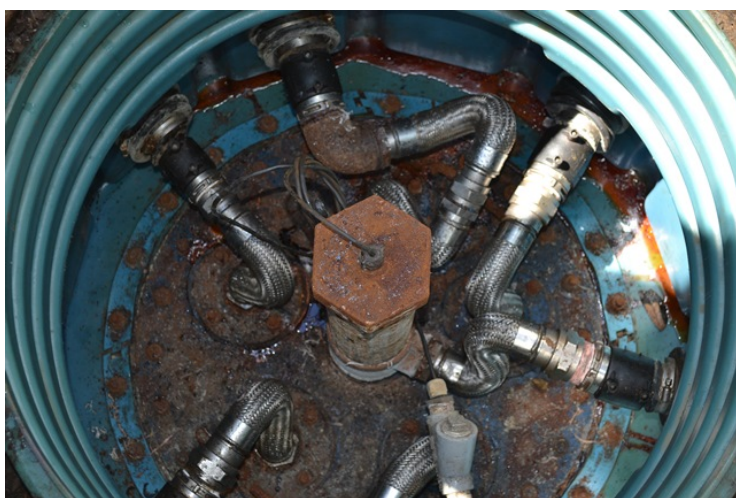
Figura 11 - Câmara de contenção do tanque subterrâneo, sem manutenção adequada.
