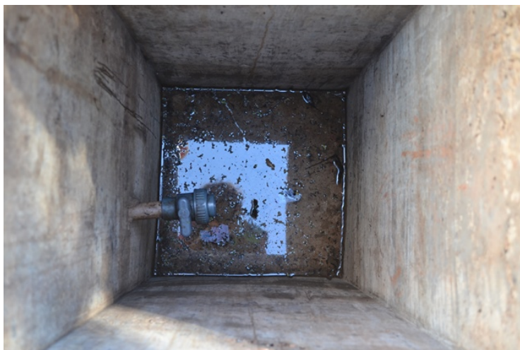
Foto 19 - Caixa coletora de óleo da área de abastecimento.
