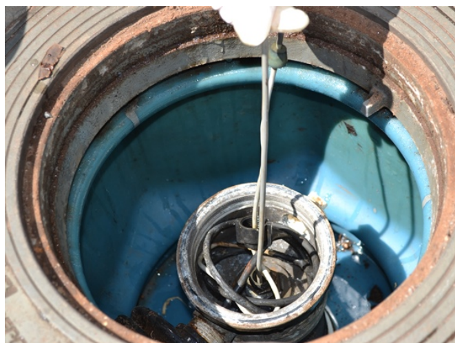
Figura 6 - Detalhe do monitoramento intersticial dos tanques.
