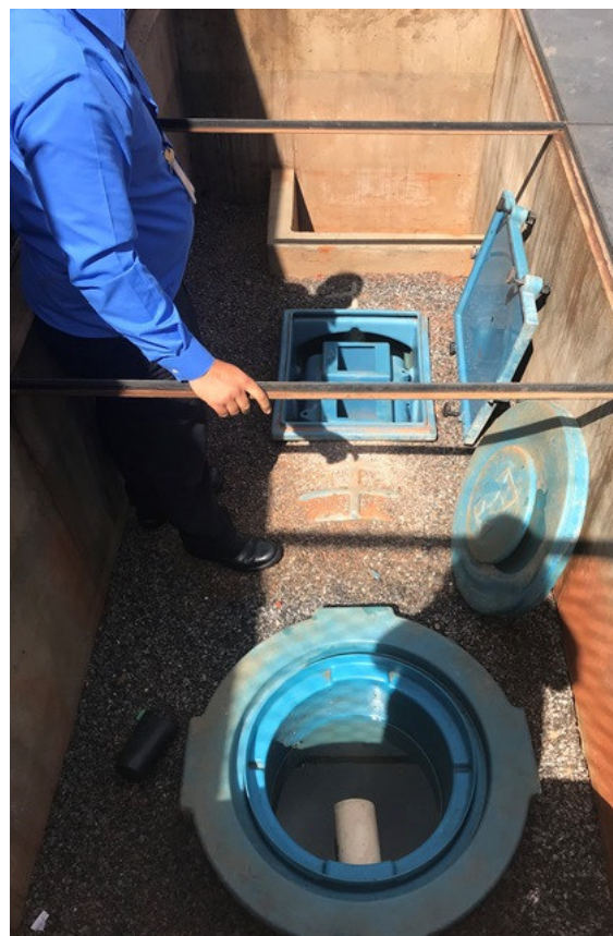
Foto 12. Visão geral do sistema separador de água e óleo da área.
