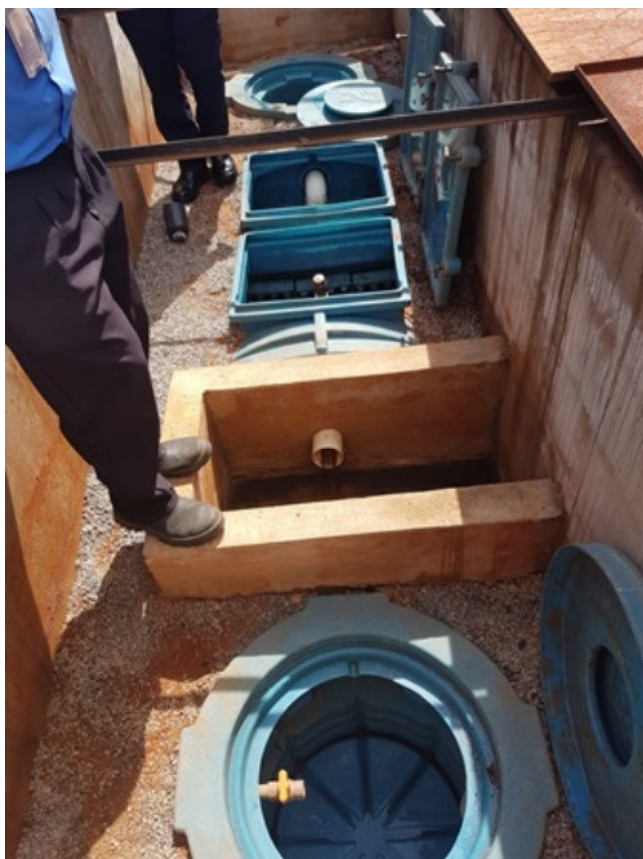
Foto 11. Visão geral do sistema separador de água e óleo da pista de abastecimento.
