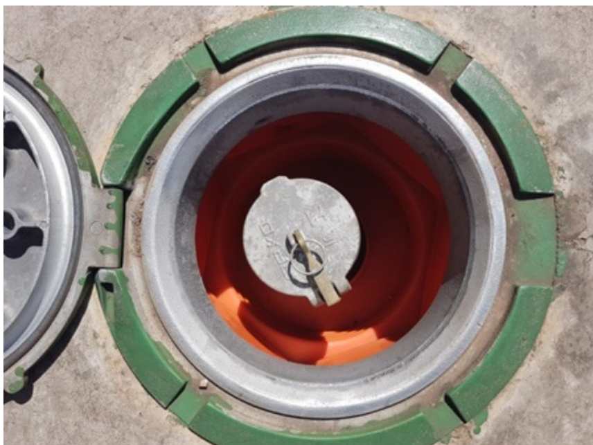
Foto 7. Detalhe da descarga selada sobre o tanque.
