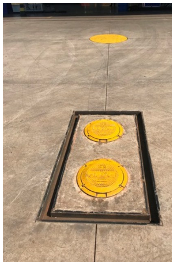
Foto 6. Detalhe da descarga selada sobre o tanque e monitoramen
