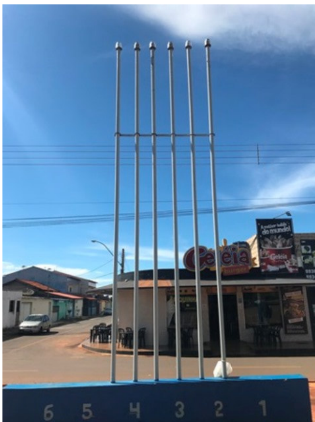
Foto 9. Visão geral dos respiros com terminal corta chamas.
