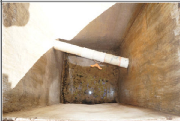
Figura 22 - Sistema separador de Água e Óleo da lavagem - Caixa de amostragem
