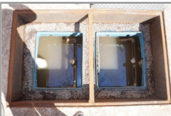
Figura 24 - Sistema separador de Água e Óleo da pista de abastecimento - caixa separadora de água/óleo
