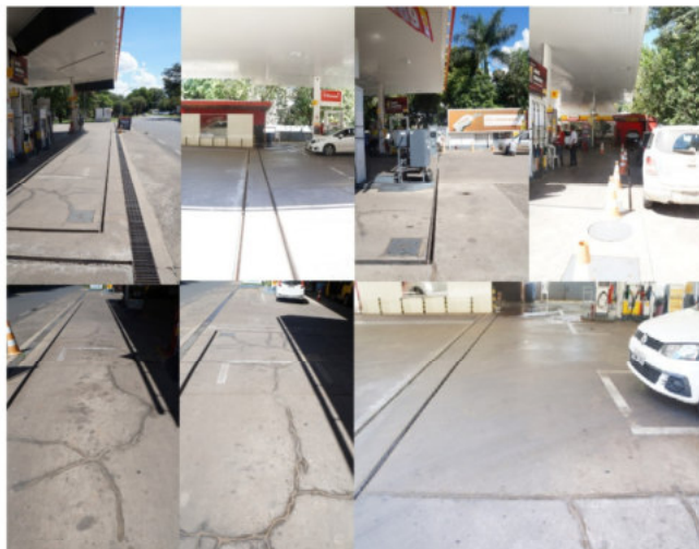
Figura 11: Pista de Abastecimento - Canais recuados a 50 centímetros para dentro da borda da cobertura do posto e Pista de concreto sem apresentar fissuras
