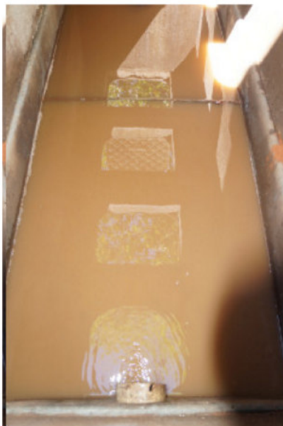
Figura 19 - Sistema separador de Água e Óleo da lavagem - Caixa de areia e caixa separadora de água/óleo conjunta - entrada do efluente
