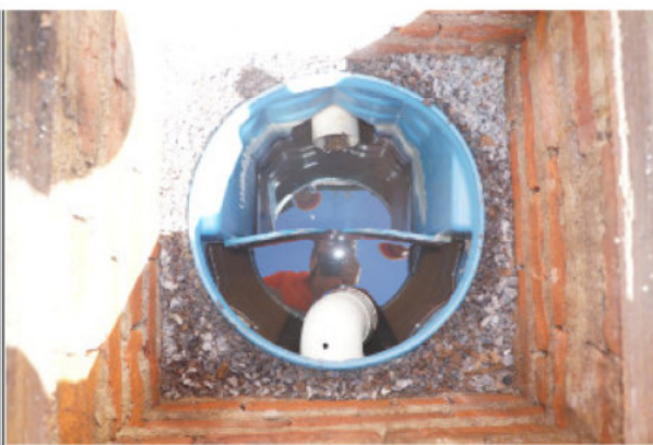
Figura 26 - Sistema separador de Água e Óleo da pista de abastecimento - Caixa de amostragem
