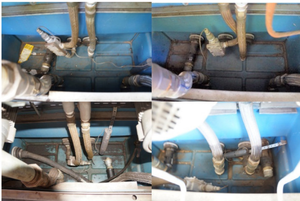
Figura 10: Pista de Abastecimento - Câmara de contenção sob as ilhas de abastecimento
