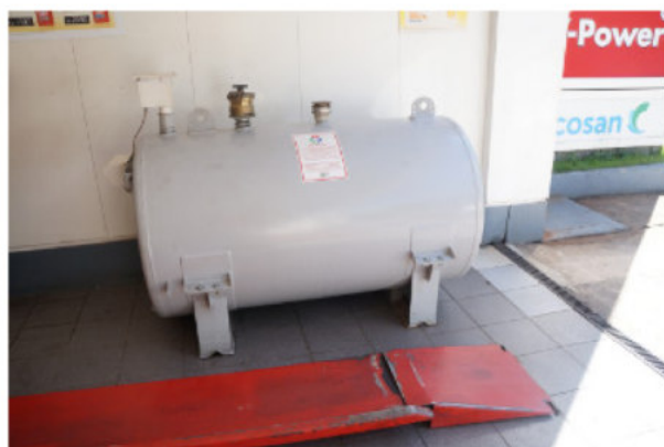
Figura 15: Área de Lubrificação e estocagem de óleo lubrificante usado - Reservatório de óleo usado circundada por canaleta, conectado ao SAO
