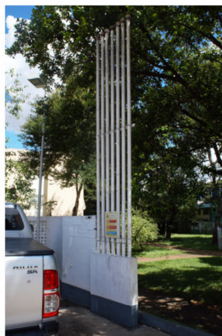
Figura 5: Tanques de combustível e dispositivos de segurança - Respiro com
