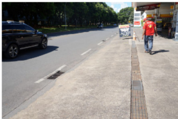
Figura 27- Sistema de drenagem pluvial - Rede de drenagem desconectada dos canaletos da pista de abastecimento
