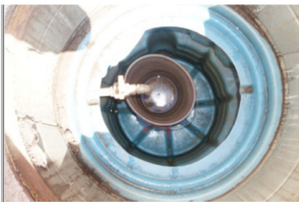
Figura 25 - Sistema separador de Água e Óleo da pista de abastecimento - Caixa coletora de óleo
