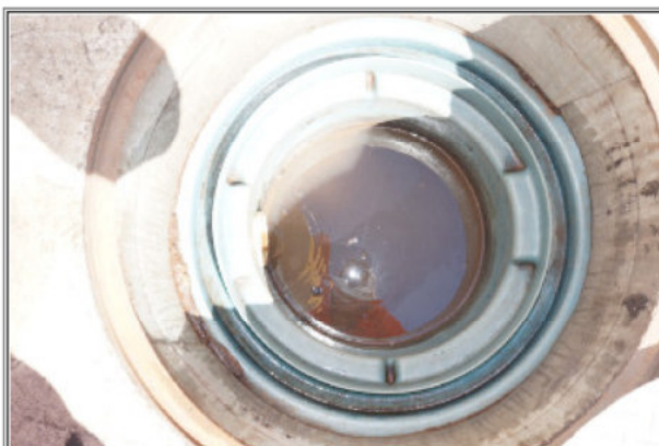
Figura 23 - Sistema separador de Água e Óleo da pista de abastecimento - Caixa de areia
