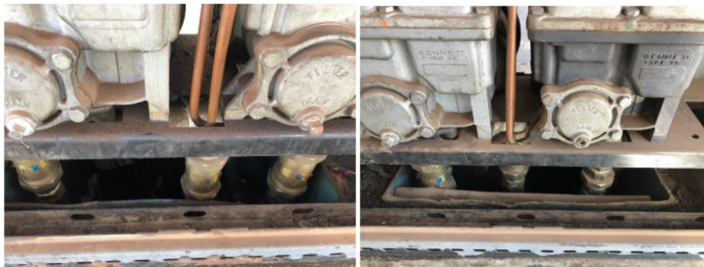
Câmara de contenção sob duas unidades abastecedoras, com visualização do checkvalve
