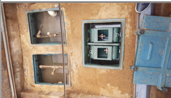
Figura 12: Caixas separadoras de água e óleo (esquerda) e caixa coletora de óleo (direita). SÃO da lavagem separado do SÃO da área de abastecimento
