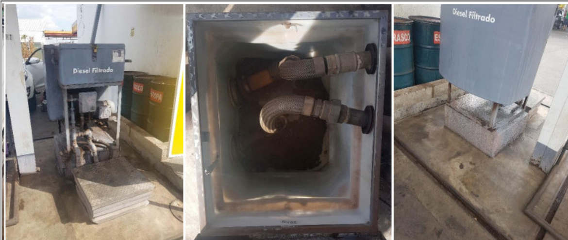
Figura 16: Filtro de DIESEL S500, sump do filtro e canaleta da área do filtro, respectivamente
