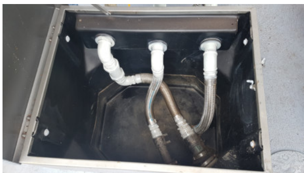
Figura 14: Sump do filtro de DIESEL S10
