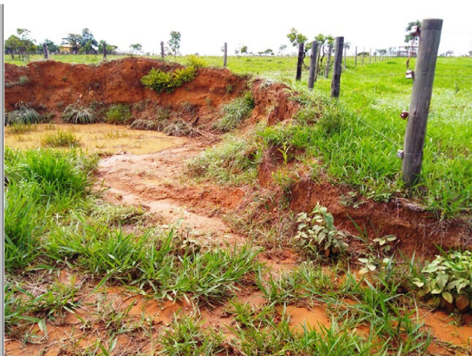
Foto 3: Sistema de drenagem sem manutenção.
