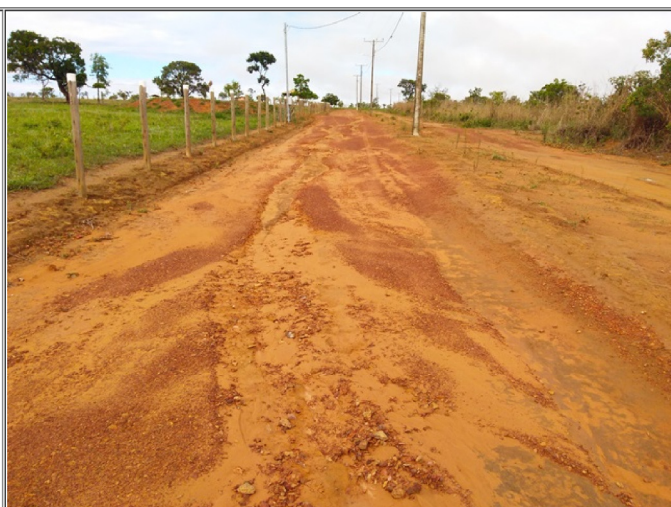
Foto 2: Sistema de drenagem sem manutenção.
