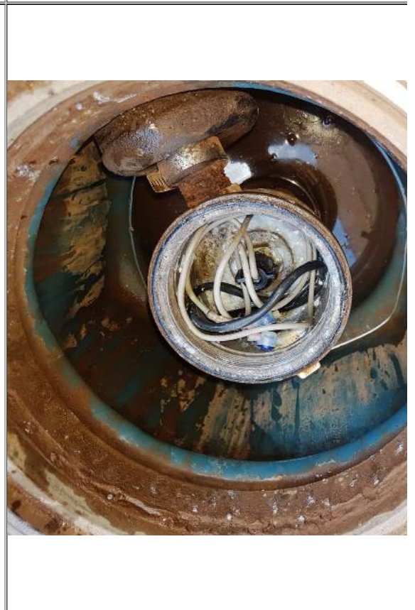
FOTO 8: monitoramento intersticial, não estava devidamente instalado
