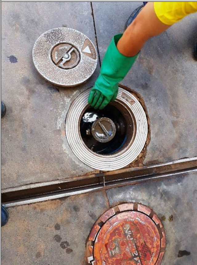
FOTO 7: Abertura do monitoramento intersticial com excesso de água na parte externa necessitando limpeza e drenagem.
