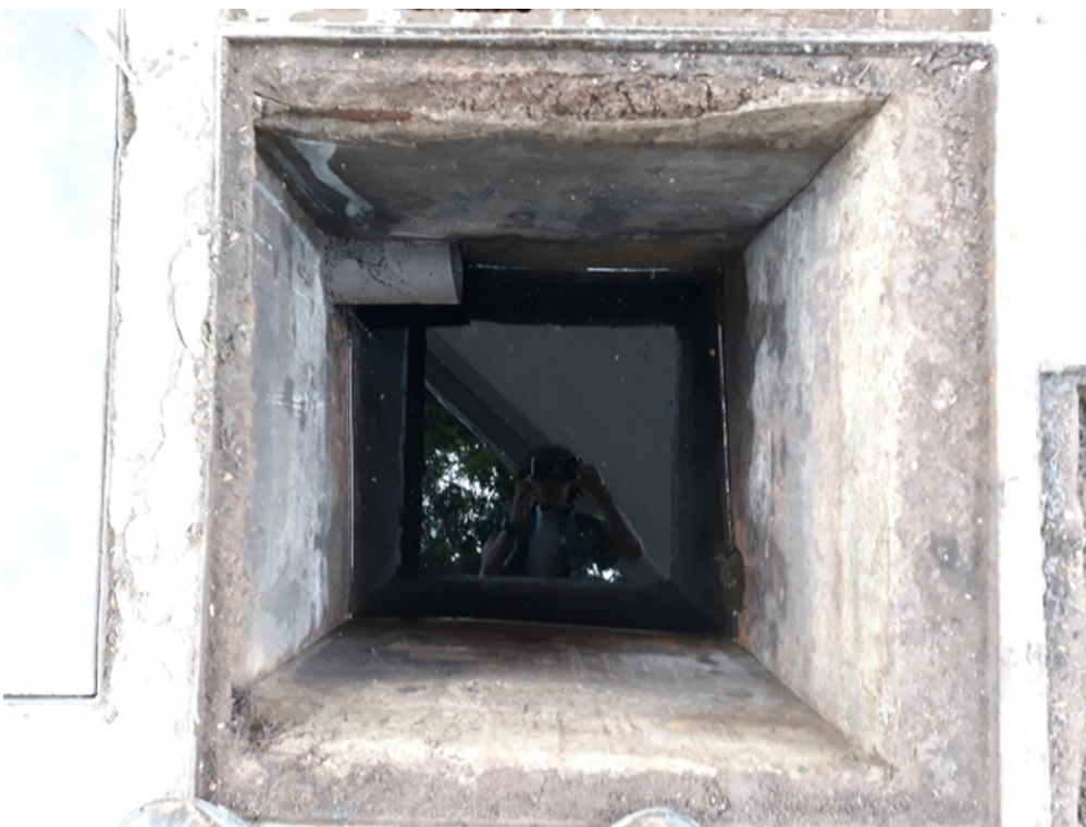
Figura 12: Caixa de areia do S.A.O., em alvenaria, da pista de abastecimento e área de lubrificação.
