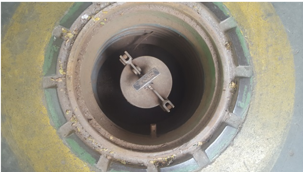
Figura 10: Descarga selada sobre o tanque apresentando manutenção adequada.
