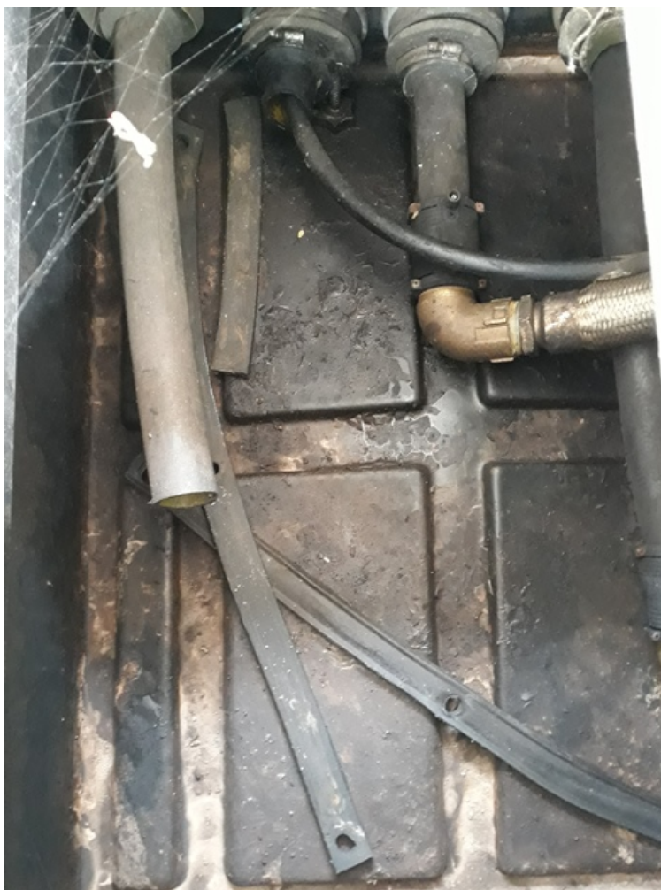
Figura 5: Câmara de contenção do filtro de diesel. Uma das tubulações aparenta não possuir vedação. O documento 14671464 comprova a adequação através de relatório fotográfico.
