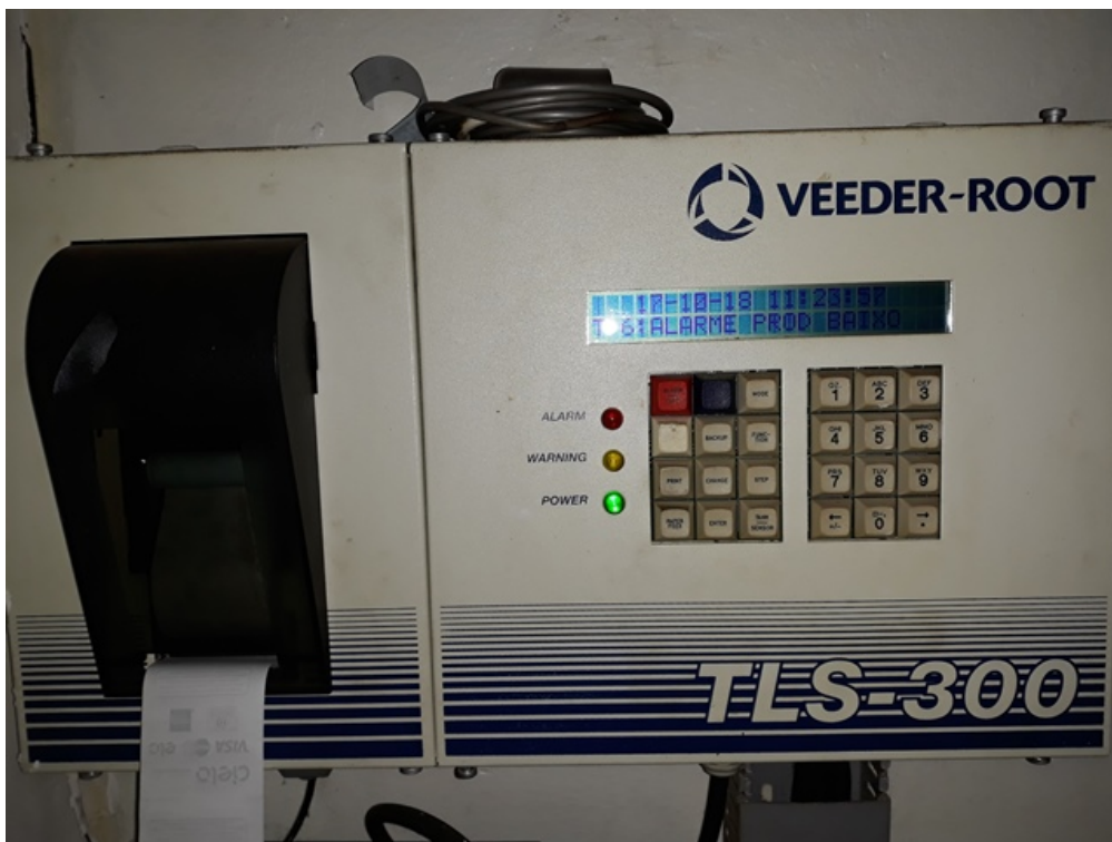
Figura 11: Aparelho de monitoramento ambiental e de controle de estoque. O documento 14671464 possui relatório do estado do sistema comprovando o funcionamento do interstício de quatro dos cinco tanques.
