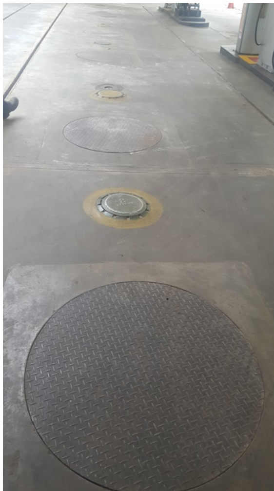
Figura 7: Área de tancagem contendo cinco tanques, sendo quatro de parede dupla e um de parede simples. Esta área é contemplada por canais direcionados ao S.A.O.
