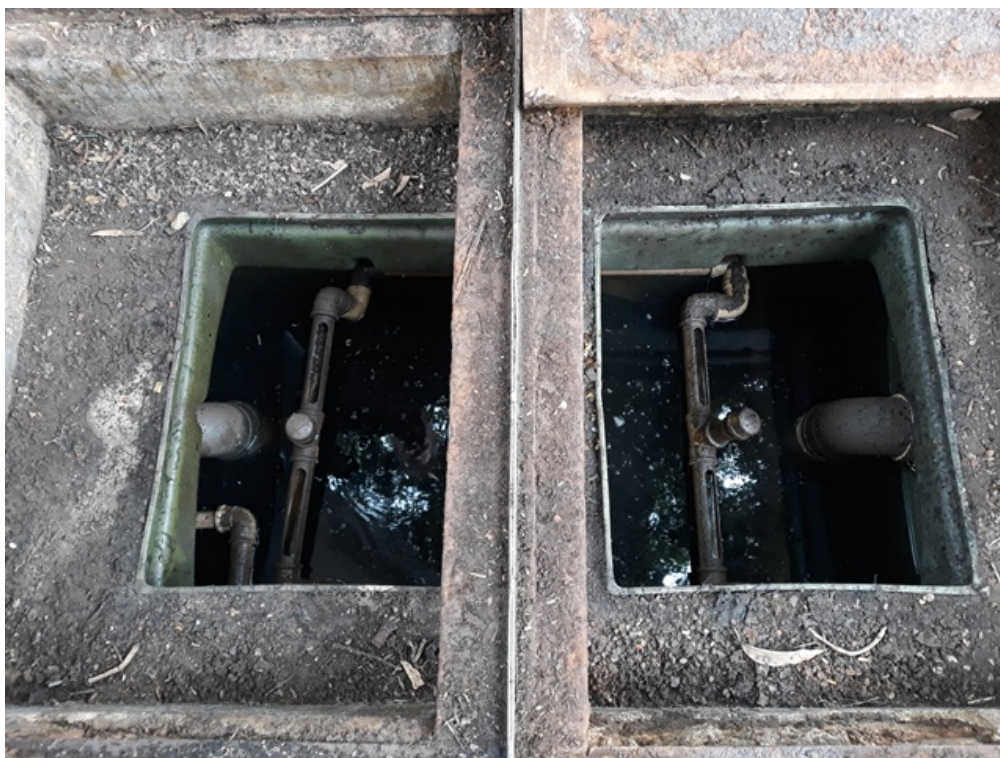
Figura 13: Caixa separadora de água e óleo pré-moldada com manutenção inadequada devido ao fato do posto não está operando.
