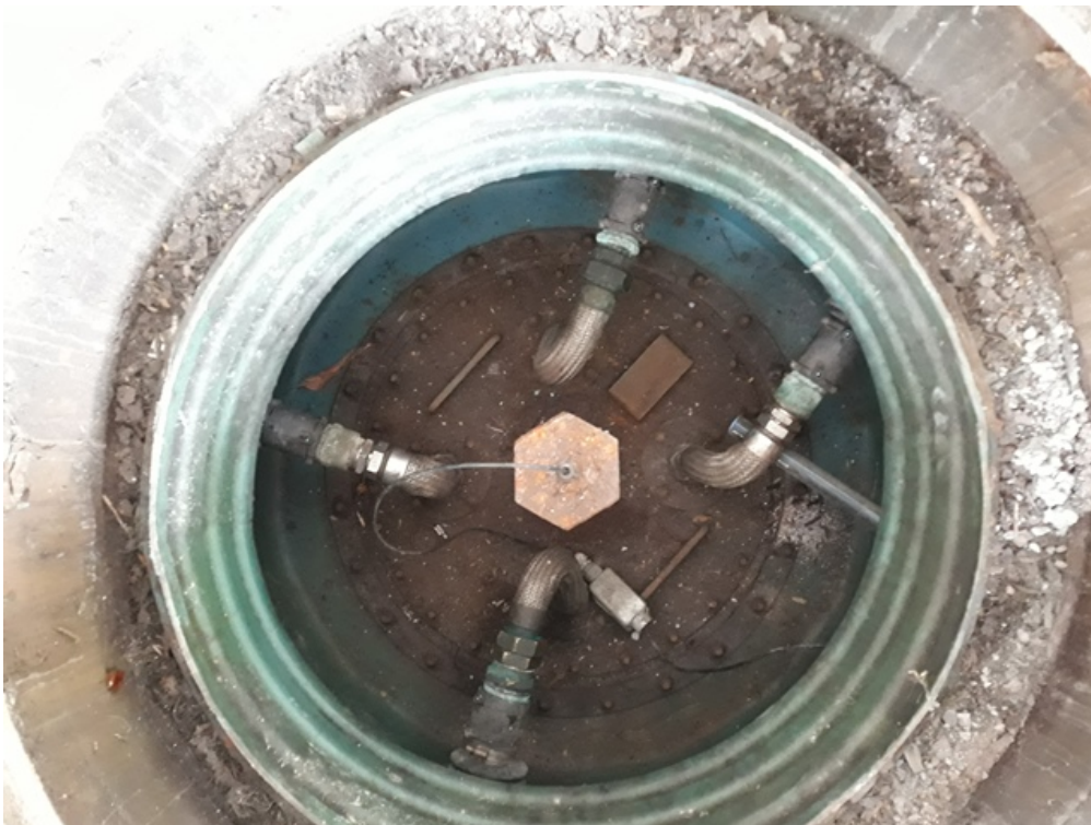
Figura 8: Boca de visita do tanque de combustível com monitoramento ambiental.
