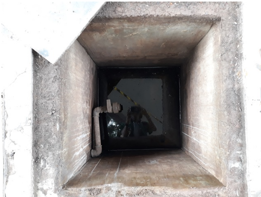
Figura 14: Caixa de amostragem do S.A.O., em alvenaria, da pista e da área de lubrificação.
