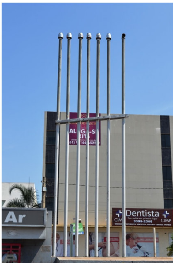
Figura 9 - Respirios com terminal corta chamas. Observa-se que um dos 7 (sete) respiros não possui corta-chamas e apresenta-se com terminal cotovelo oriundo do tanque Subterrâneo de Armazenamento de Óleo Usado e Contaminado - OLUC.
