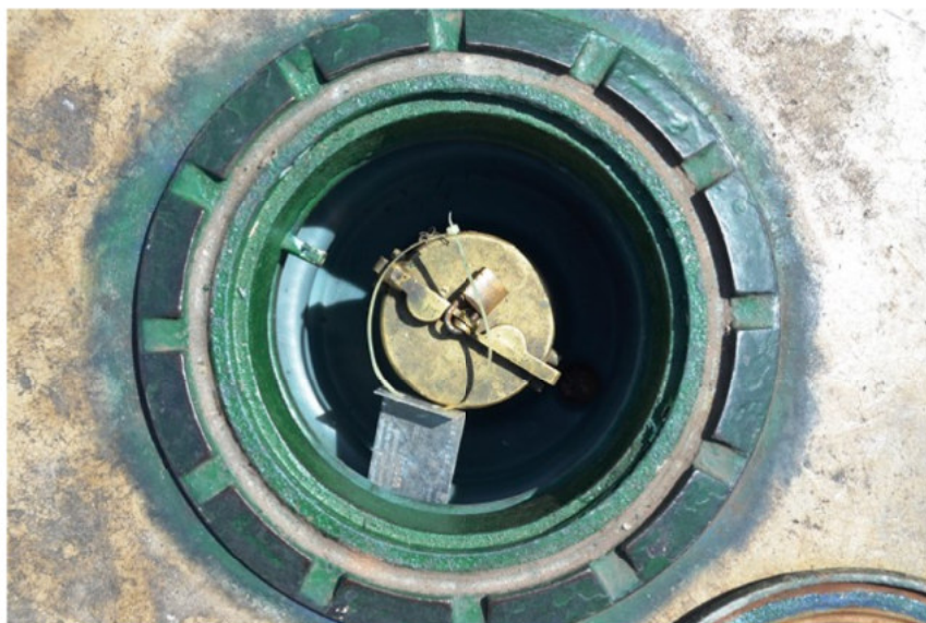
Figura 11 - Dispositivo de Descarga selada sobre o tanque com câmara de contenção ( Spill container ) e válvula anti-transbordamento. Observa-se a necessidade de manutenção operacional constante conforme exige a tabela 1 da ABNT NBR 15594-3:2008.
