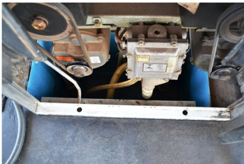
Figura 4 - Aspecto externo da Câmara de contenção de uma das Unidades Abastecedoras do SASC. Observa-se que a tubulação está totalmente contida no sump da câmara de contenção do dispositivo de segurança. Os sumps das demais unidades necessitam de manutenção operacional diária conforme exige a tabela 1 da ABNT NBR 15594-3:2008.
