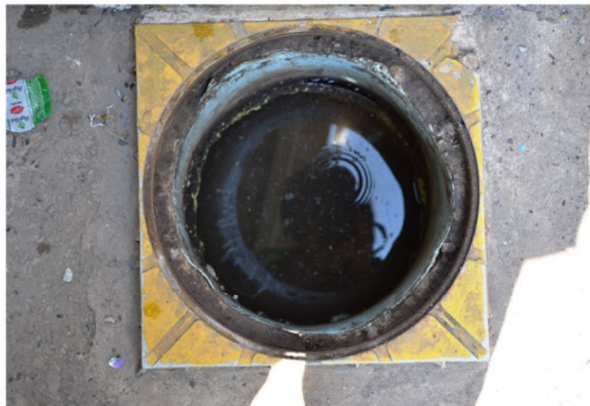
Figura 21 - Aspecto da caixa de areia do Separador de Água e Óleo da área do lava jato. Observa-se a necessidade de adequação conforme exige a ABNT NBR 14605-2:2009.
