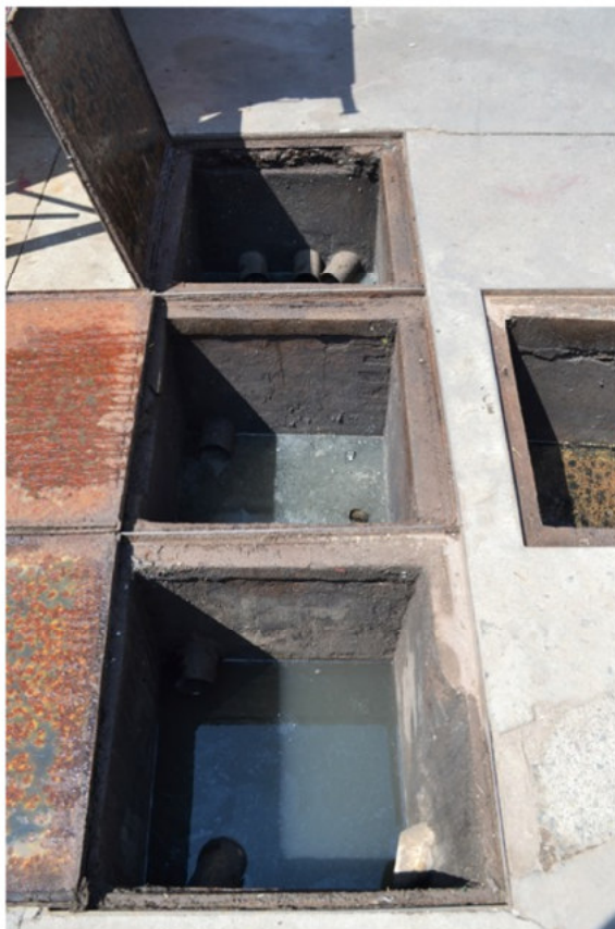
Figura 19 - Aspecto geral do Separador de Água e Óleo da área do Lava Jato. O sistema possui Caixa de areia, Caixa separadora de água de óleo, caixa coletora de óleo e caixa de amostragem de efluentes da área do lava jato. Observa-se que o sistema necessita realizar manutenção operacional semanal conforme exige a tabela 1 da ABNT NBR 155943:2008.
