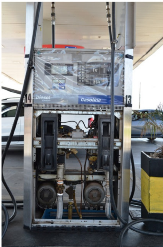
Figura 3 - Unidade abastecedora de Gasolina Comum e Diesel Comum com o dispositivo de segurança check-valve , observa-se que a tubulação está limpa e totalmente contida na câmara de contenção para unidade da bomba. A unidade necessita de manutenção operacional diária conforme exige a tabela 1 da ABNT NBR 15594-3:2008
