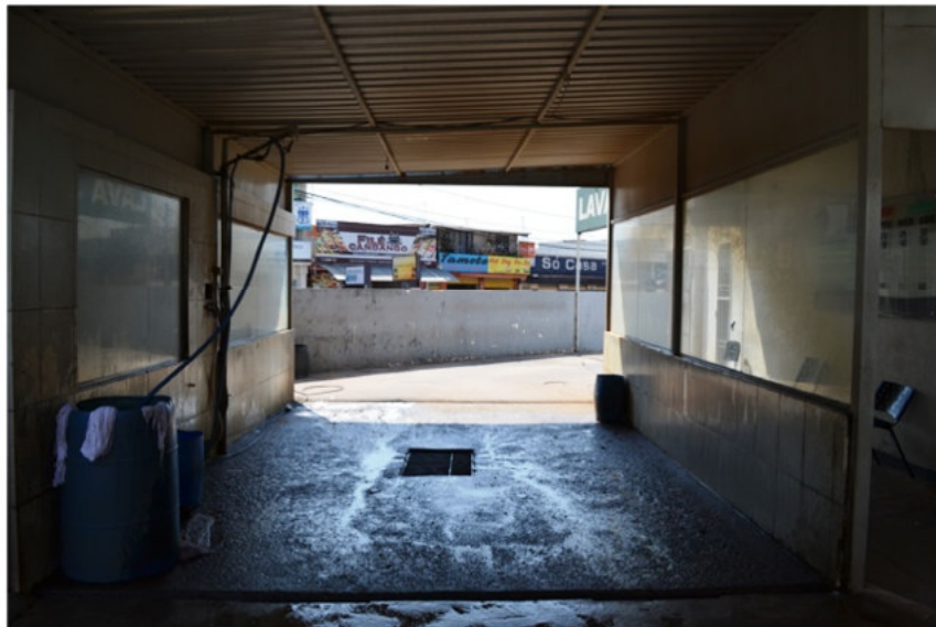
Figura 18 - Aspecto da Área de lavagem de Veículos. Observa-se que a área está em funcionamento e possui canaletes, cobertura e aparenta não ter o caimento na caixa de areia o que pode haver transbordamento da água utilizada para lavagem de veículos.
