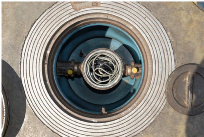
Figura 14 - Detalhe da câmara de contenção interna do Monitoramento do Interstício. Observa-se que o dispositivo necessita de manutenção operacional constante conforme exige a tabela 1 da ABNT NBR 15594-3:2008.
