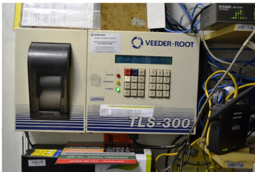
Figura 15 - Sistema de medição e monitoramento ambiental Veeder-Root. O sistema está instalado e apresenta o status de operação dentro da normalidade conforme painel indicador com a luz verde.
