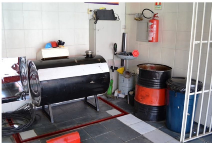
Figura 16 - Aspecto do tanque de OLU e dos tambores utilizados para o acondicionamento dos resíduos perigosos classe I. Observa-se que além dos canaletos externos à área de lubrificação a mesma possui um canaleta interno específico para o tanque de OLU.
