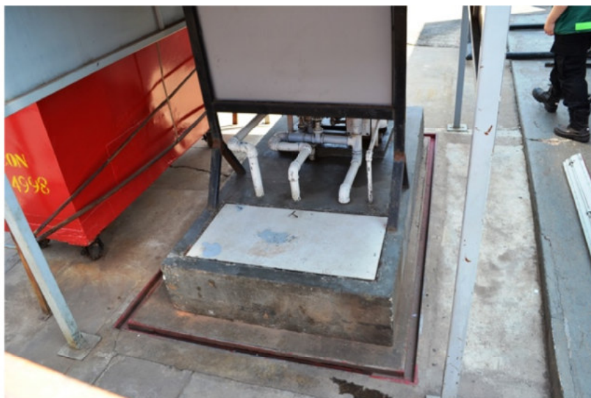
Figura 6 - Aspecto do filtro desidratador de Diesel com sump . Observa-se que a unidade é coberta e circundada por canaletas de proteção.
