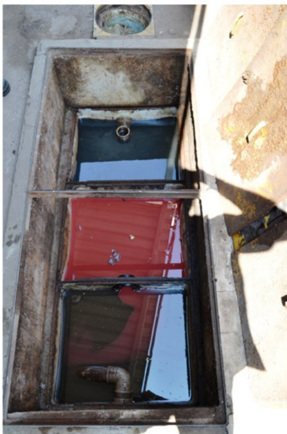
Figura 20 - Aspecto geral do Separador de Água e Óleo da área do Lava Jato. Observa-se que o sistema necessita realizar manutenção operacional semanal conforme exige a tabela 1 da ABNT NBR 155943:2008.
