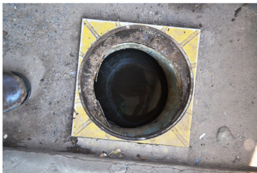
Figura 22 - Aspecto da caixa de amostragem de efluentes do Separador de Água e Óleo da área do lava jato. Observa-se a necessidade de adequação conforme exige a ABNT NBR 14605-2:2009.
