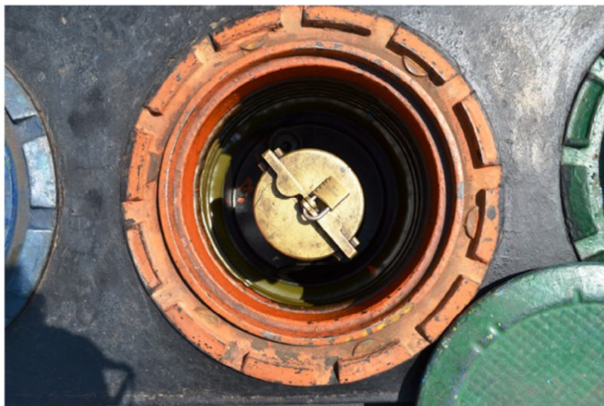
Figura 13 - Aspecto de um dos 6 (seis) dispositivos do conjunto da Descarga Selada à Distância com câmara de contenção ( Spill container ). Observa-se que o dispositivo está em bom estado de conservação. O dispositivo necessita de manutenção operacional constante conforme exige a tabela 1 da ABNT NBR 15594-3:2008.
