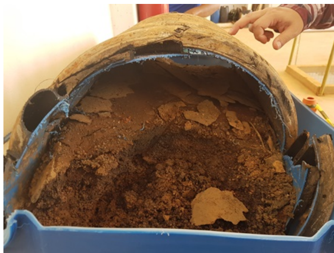
Foto 6: Corte da tubulação obstruída. Verifica-se a consistência terrosa do material acumulado.
