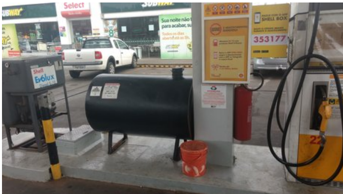
Figura 02 - Tanque de OLUC atual, em área abrangida por canaletes.
