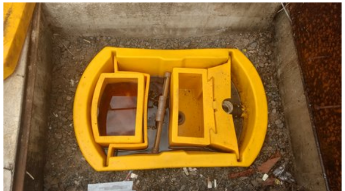
Figura 07 - SAO que atende à área de descargas seladas a distância.
