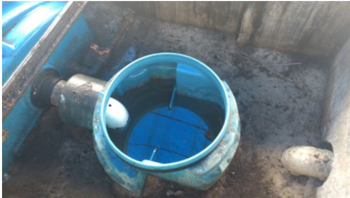
Figura 10 - Caixa de amostragem do SAO da área de lavagem de veículos submersa.
