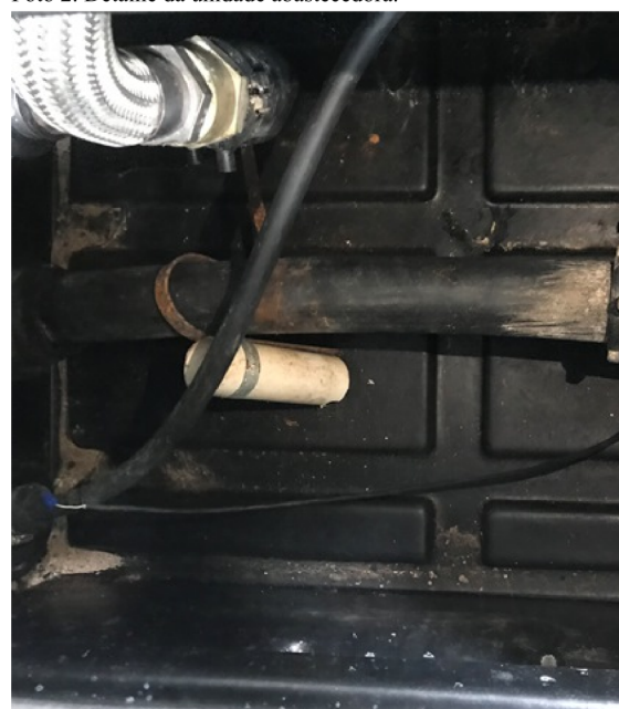
Foto 4. Detalhe da câmara de contenção do filtro de diesel.
