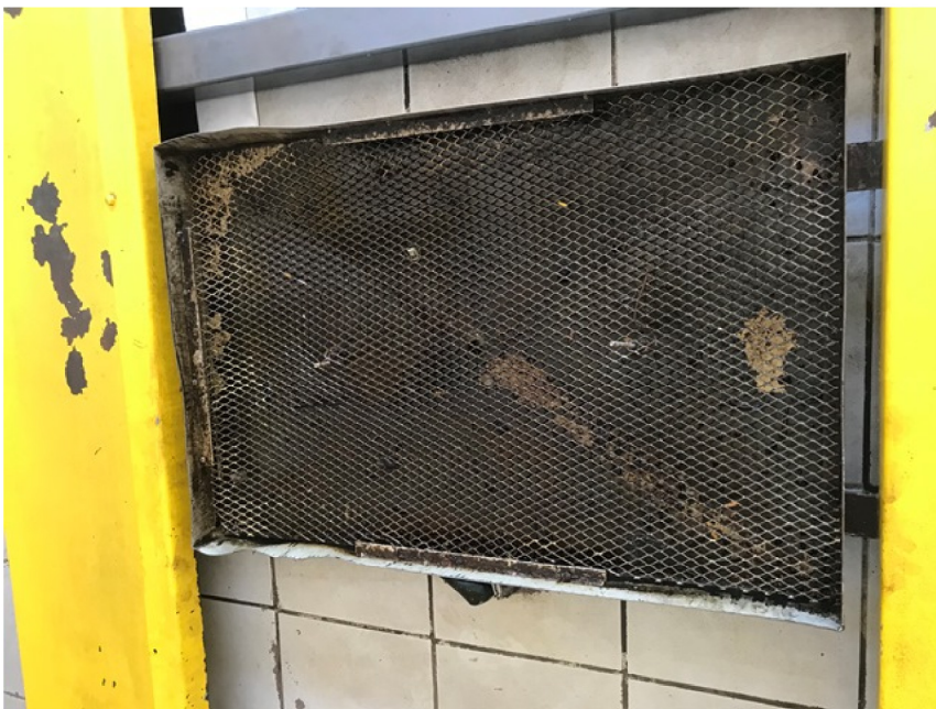
Foto 11. Caixa coletora de óleo na área de lubrificação.
