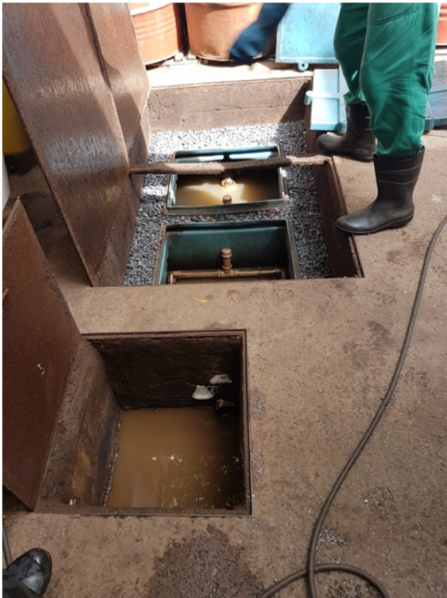
Foto 13. Caixa de areia e caixa separadora de água e óleo do SAO da lavagem.
