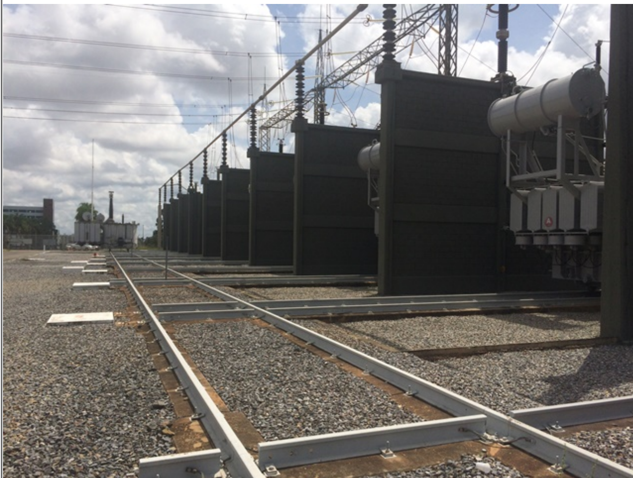
Pátio de Autotransformadores e Bacias de Contenção
