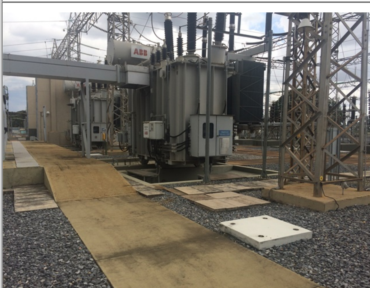
Pátio de Transformadores
