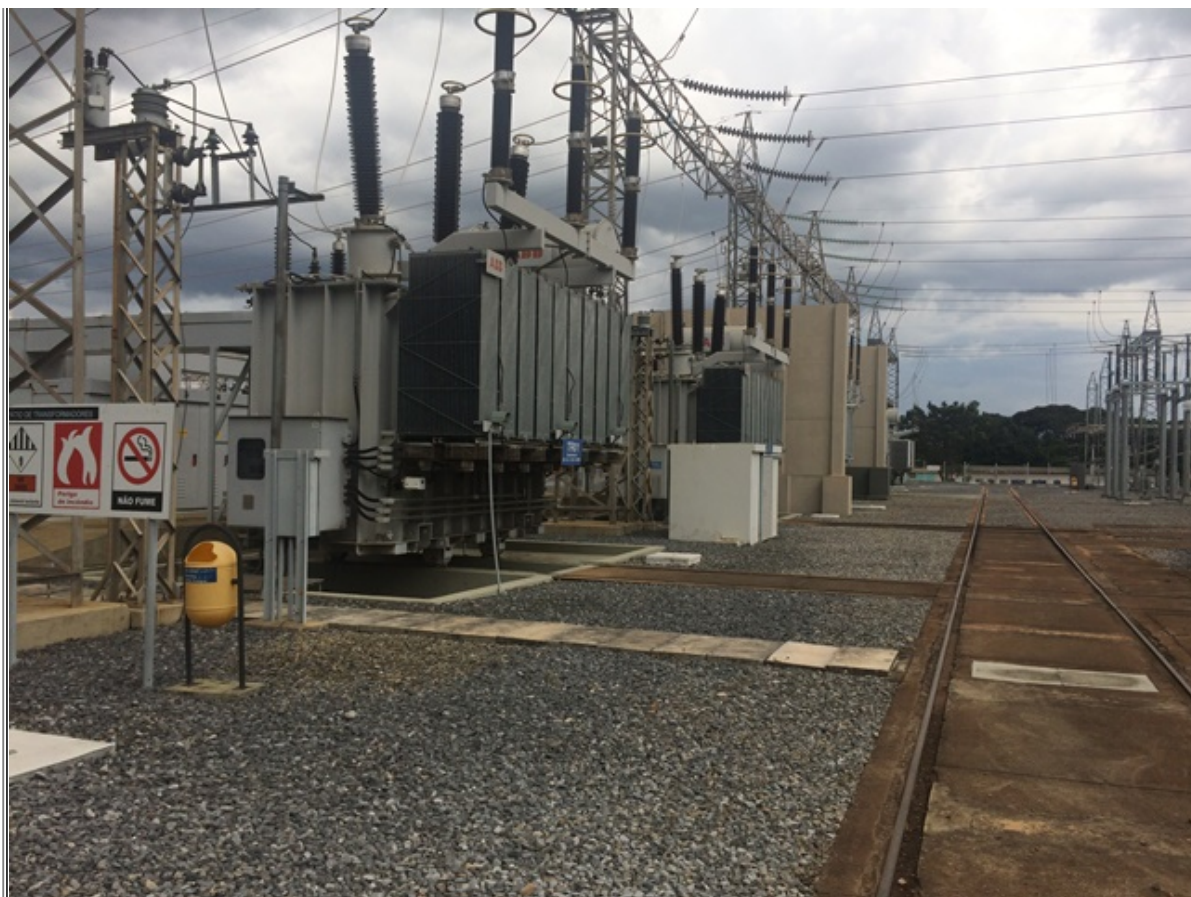
Pátio de Transformadores
