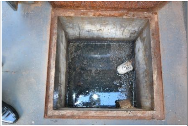
Foto 21 – Caixa de Areia do SAO da Pista de Abastecimento.
