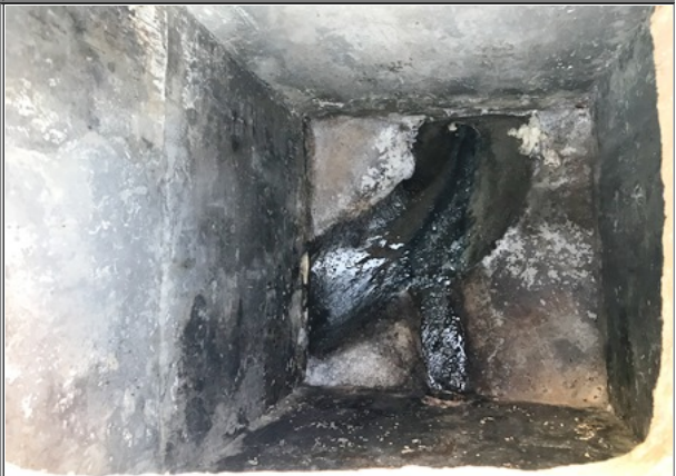
Foto 23 – Caixa de passagem sendo utilizada como de amostragem de efluentes.
