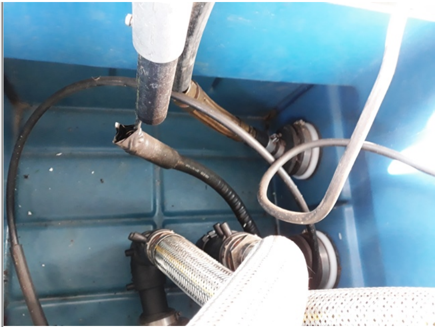
Foto 10 – Unidade abastecedora com sump e Check-valve
