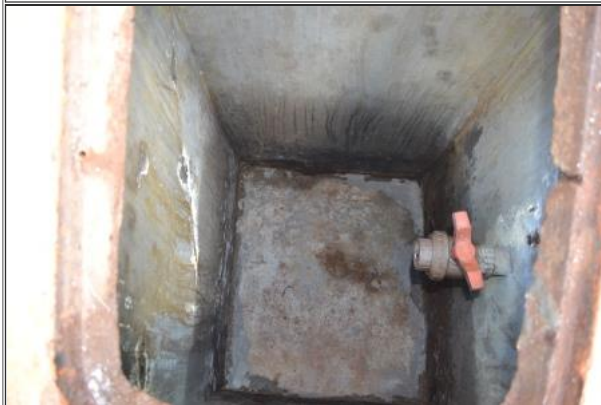
Foto 24 – Caixa coletora de óleo da pista de abastecimento.
