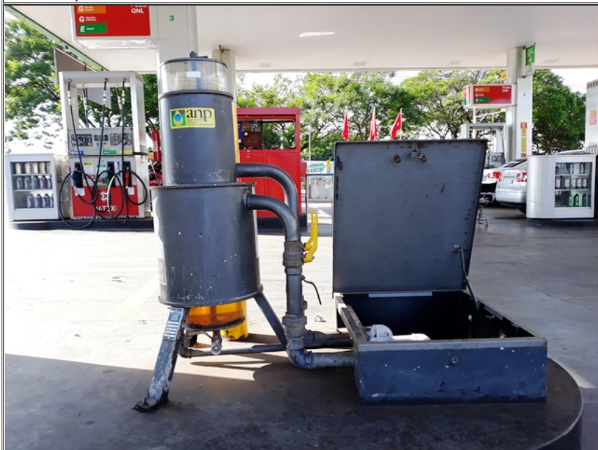
Foto 6 – Filtro de Diesel (S10) e câmara de contenção da unidade filtrante.
