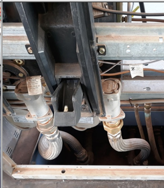
Foto 7 – Câmara de Contenção para Unidade de Filtragem, localizada na pista de abastecimento.
