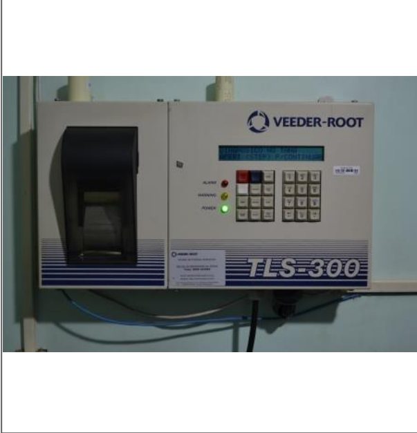
Foto 34 – Monitoramento Ambiental Veeder-Root
