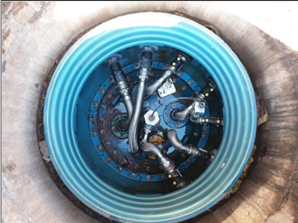
Foto 32 – Aspecto da Câmara de contenção (sump) na boca de visita do tanque com controle eletrônico de estoque, tubulação metálica flexível, tubulação subterrânea em PEAD e flanges de vedação.
