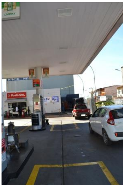
Foto 14 – Detalhe dos Canaletes da pista de Abastecimento.
