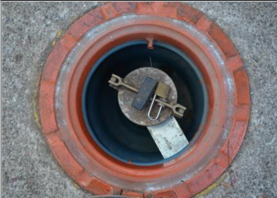
Foto 39 – Detalhe da Descarga Selada sobre o Tanque.
