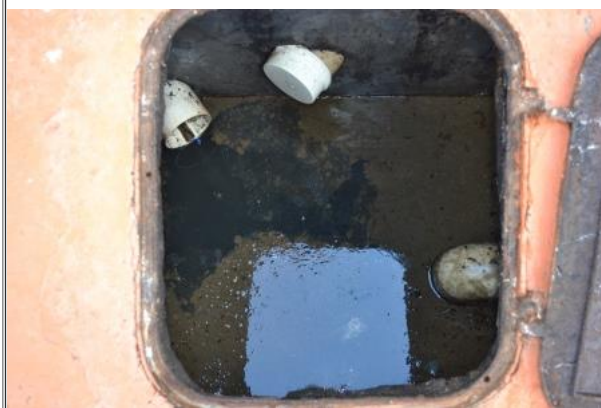
Foto 22 – Caixa Separadora do SAO da pista de abastecimento
