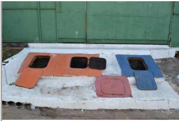
Foto 20 – Aspecto Geral dos Sistemas Separadores de Água e Óleo (SAO) da pista de abastecimento.
