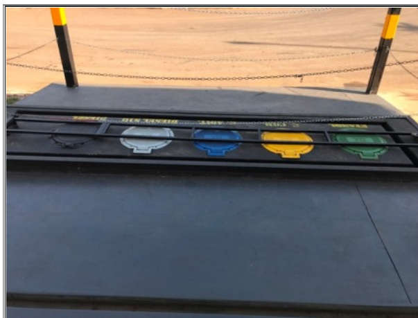
Foto 16 – Descarga Selada à distância circundada por Canaletos direcionados ao SAO da pista de abastecimento.
