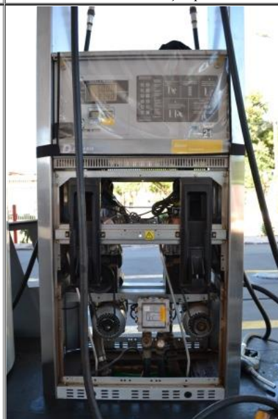
Foto 9 – Unidade abastecedora com sump e Check-valve
