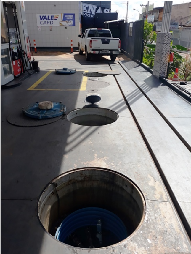
Foto 40 – Aspecto da área de tancagem com os tanques doSASC tripartido e pleno.
