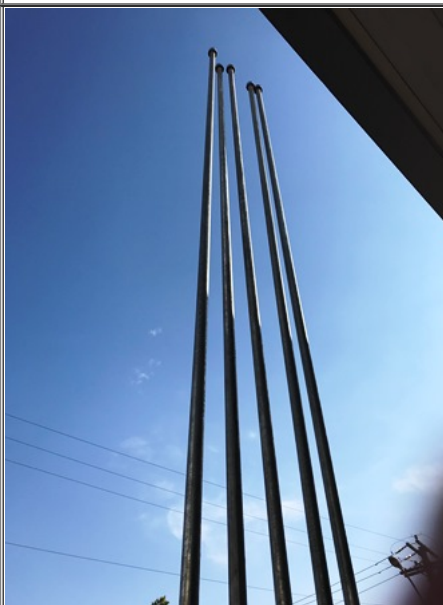
Foto 19 – Detalhe das 5 (cinco) unidades de respiros compostas por terminais corta-chamas.
