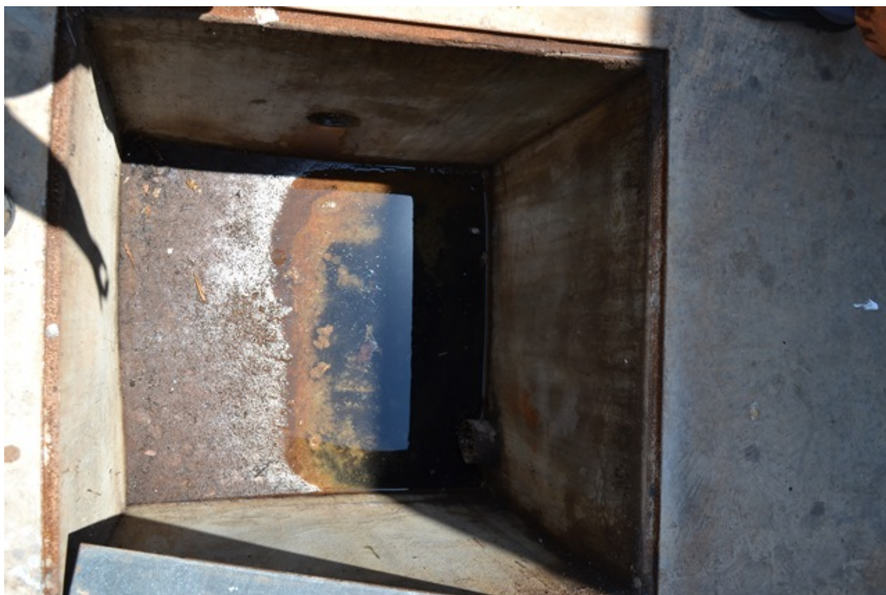
Figura 24: Caixa de amostragem de efluentes do S.A.O. do lava-jato. Esta área está desativada.
