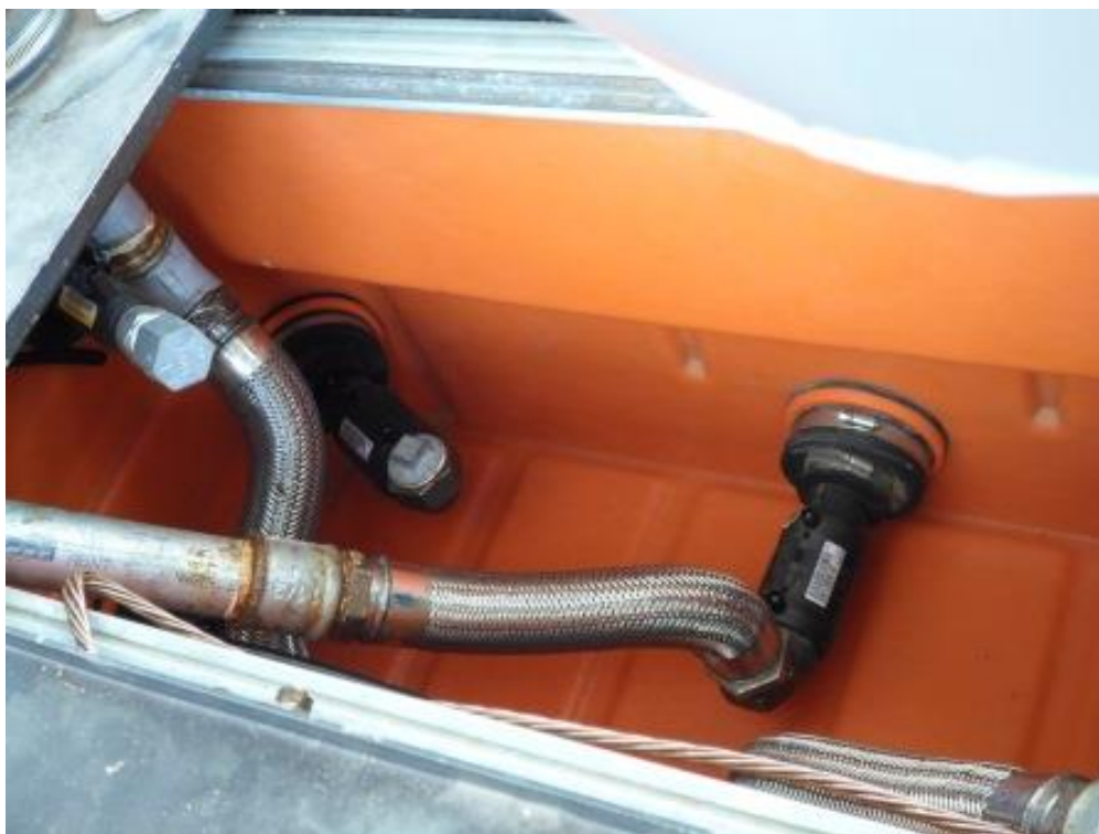
Figura 13: Câmara de Contenção para Unidade de Filtragem, localizada na pista de abastecimento 1.
