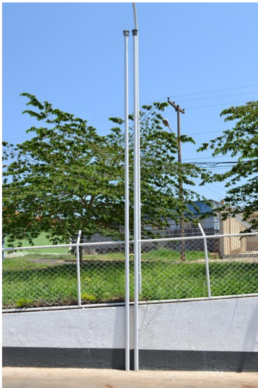
Figura 18: Respiros com terminal corta-chamas do tanque de diesel da pista 2.
