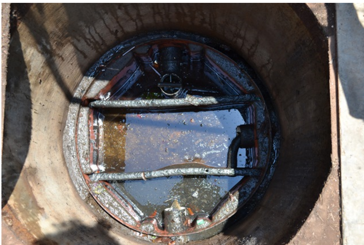
Figura 28: Caixa separadora de água e óleo da pista de abastecimento e área de lubrificação. Verifica-se a falta de manutenção do sistema.
