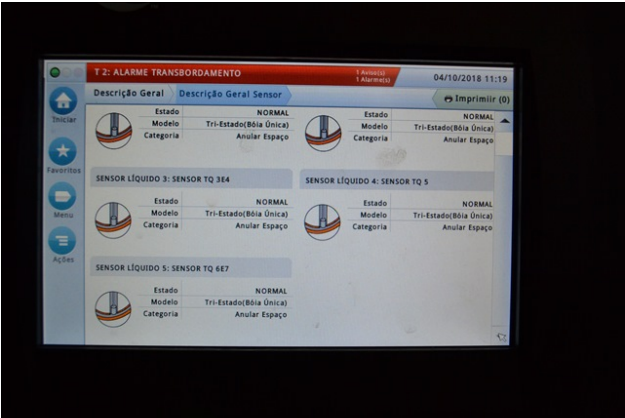
Figura 9: Monitoramento Ambiental - Tela indicadora do sensores intersticiais dos tanques.
