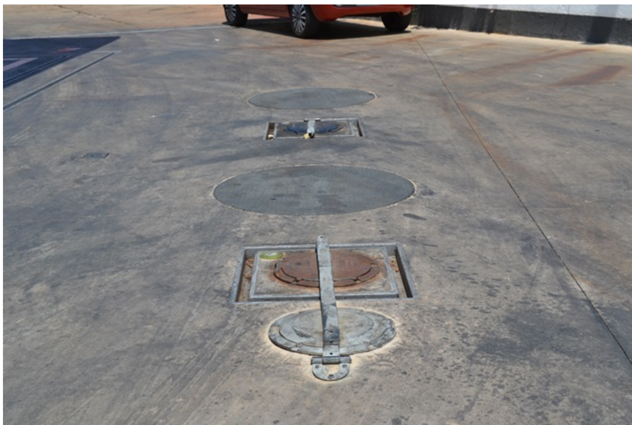
Figura 4 : Tanque bipartido para diesel da pista de abastecimento. Verifica-se que a descarga selada sobre o tanque é circundada por canaletos ligados ao S.A.O.
