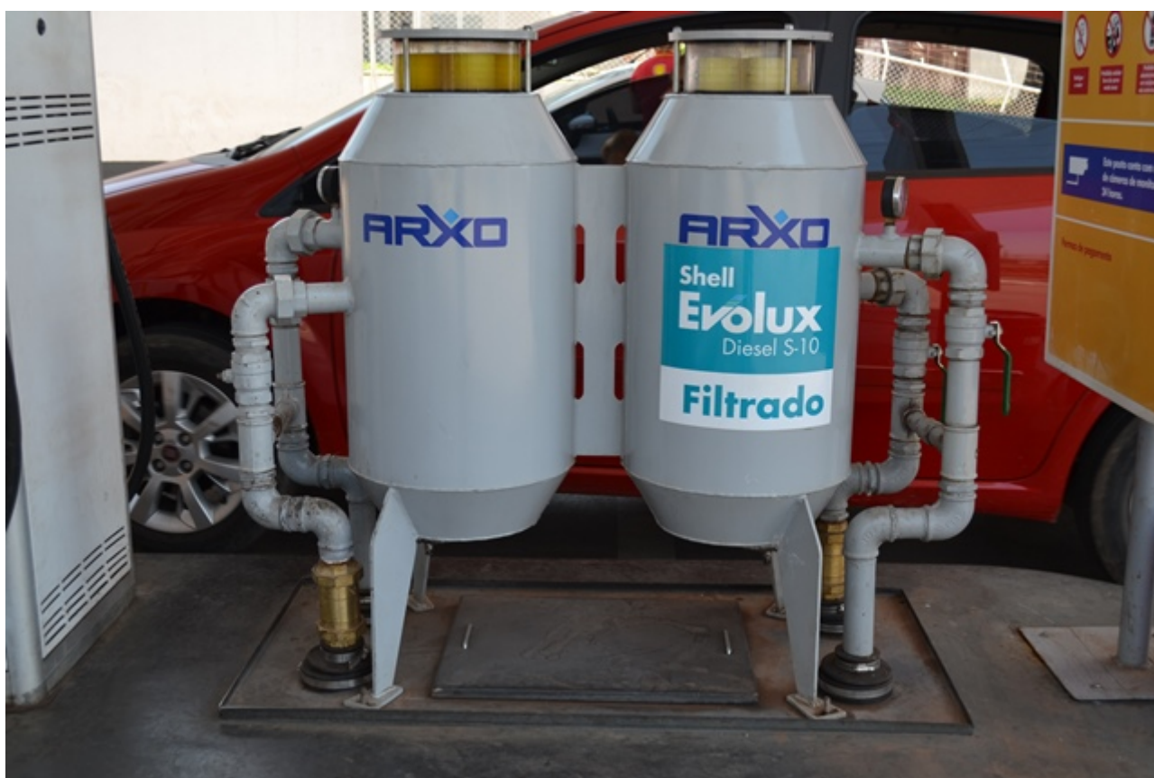
Figura 12: Filtros de Diesel na pista de abastecimento 2.
