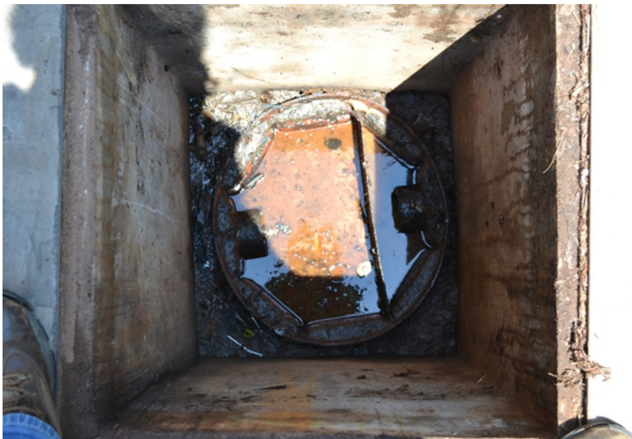
Figura 27: Caixa de areia do S.A.O. da pista de abastecimento e área de lubrificação. Verifica-se a falta de manutenção do sistema.
