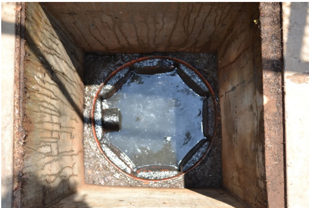
Figura 29 : Caixa de amostragem de efluentes do S.A.O. da pista de abastecimento e área de lubrificação. Verifica-se a falta de manutenção do sistema.
