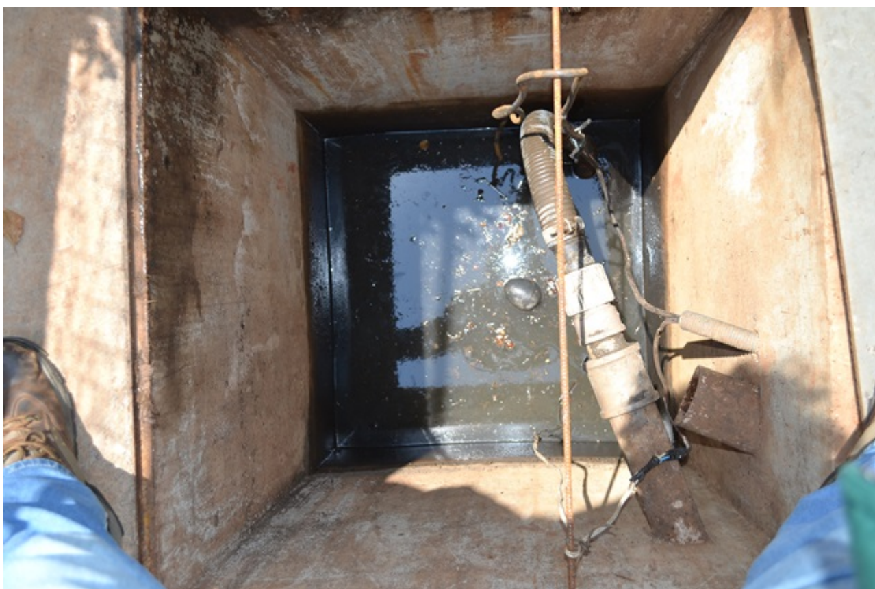
Figura 30 : Caixa coletora de óleo do S.A.O. da pista de abastecimento e área de lubrificação. Verifica-se tubulações e fiação elétrica e a falta de manutenção do sistema.
