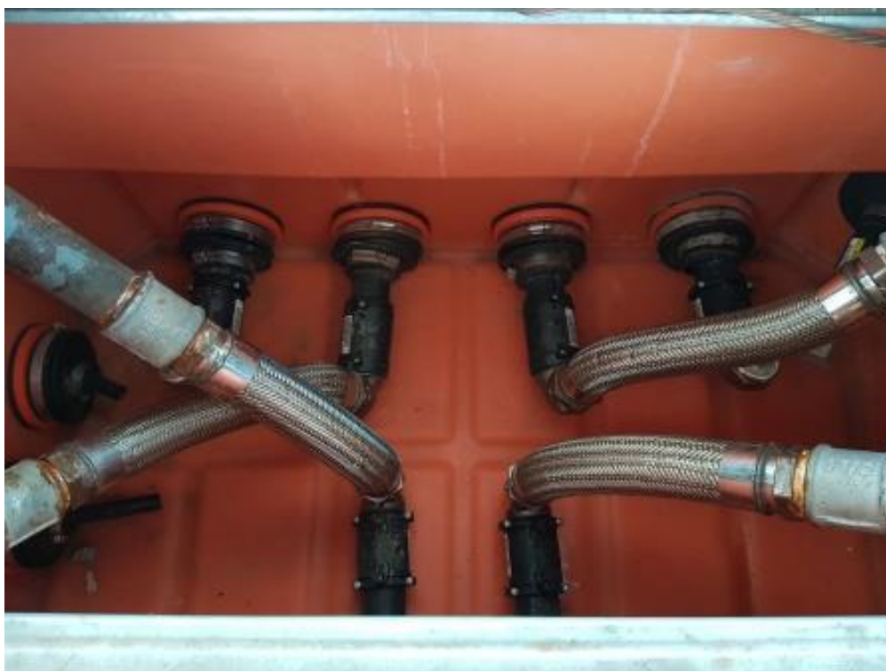
Figura 14 : Câmara de Contenção para Unidade de Filtragem, localizada na pista de abastecimento 2.
