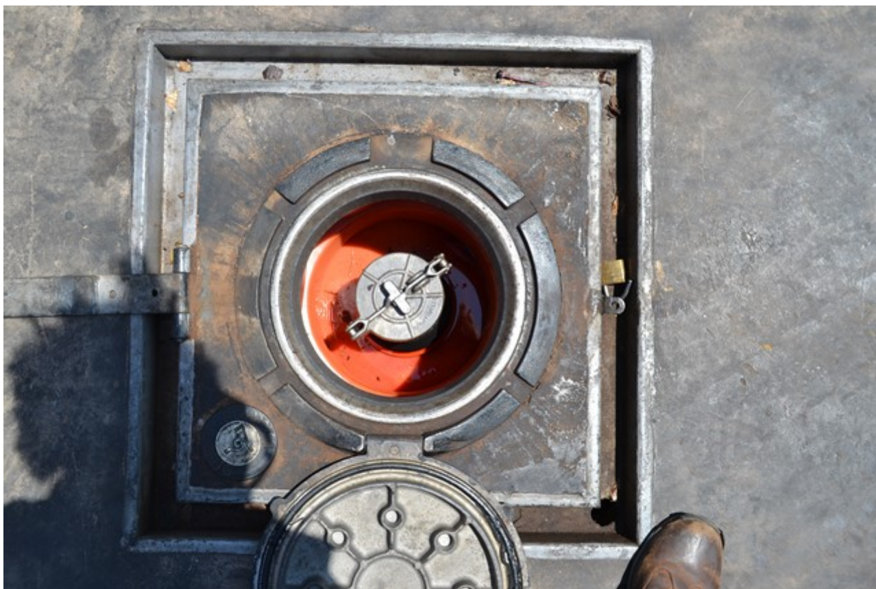
Figura 5 : Descarga selada sobre o tanque de diesel na pista 2.
