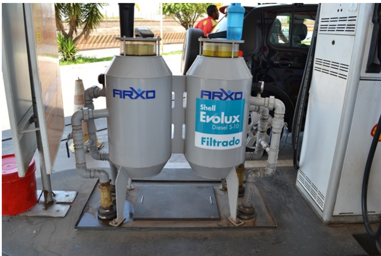
Figura 11: Filtros de Diesel na pista de abastecimento 1. Constatou-se vazamento em um dos filtros.
