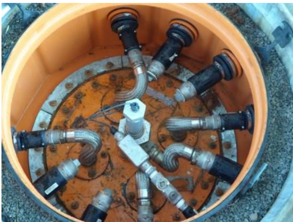
Figura 6: Boca de Visita do Tanque evidenciando controle eletrônico de estoque e tubulação subterrânea de PEAD.
