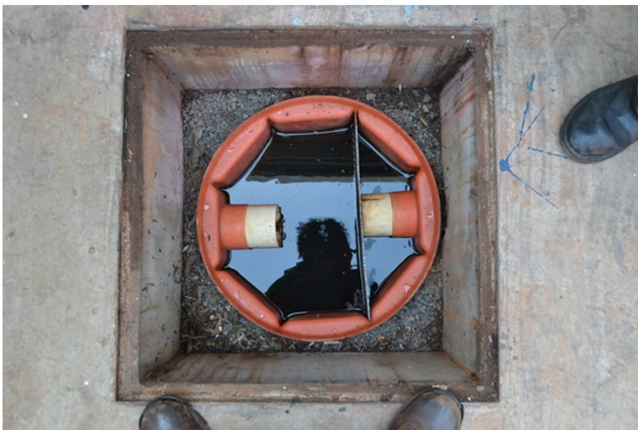
Figura 26: Caixa de areia do S.A.O. da área do lava-jato. Esta área está desativada.
