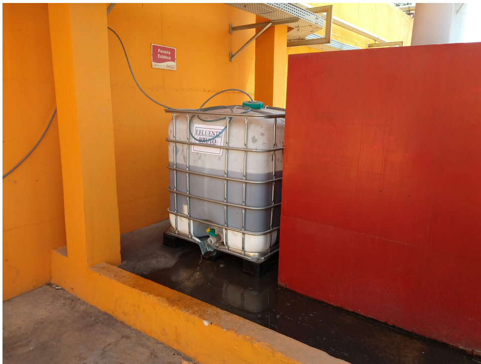
Figura 7 - Efluente bruto sendo despejado em área com contenção lateral.
