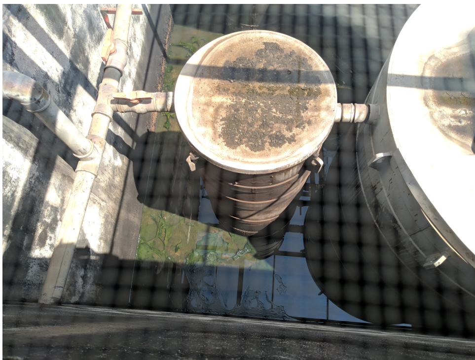
Figura 6 - Presença de lodo na área de contenção do SAO, a responsável pelo local informou que é realizada inspeção visual semanalmente.
