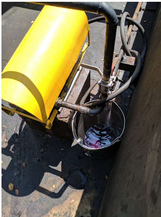
Figura 4 - Presença de vazamento de óleo diesel sendo contido por um balde dentro da área de contenção.
