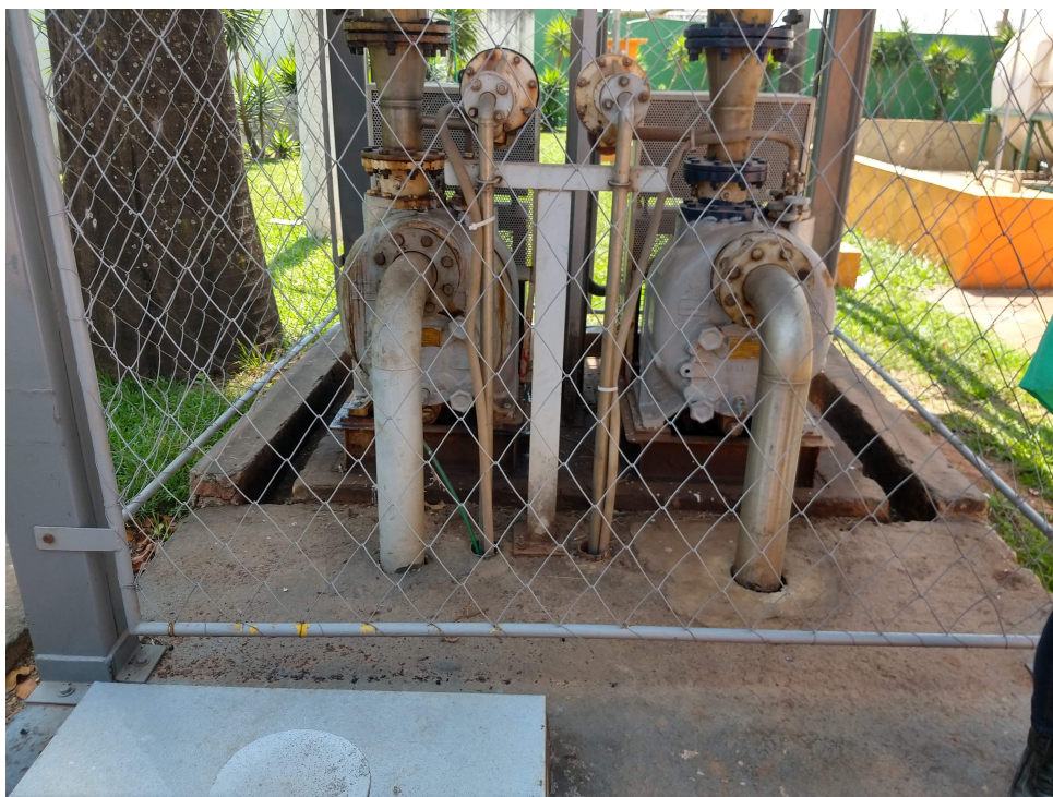
Figura 9 - Barreira de contenção apenas nas laterais no local de bombeamento do efluente tratado para a rede coletora da CAESB.
