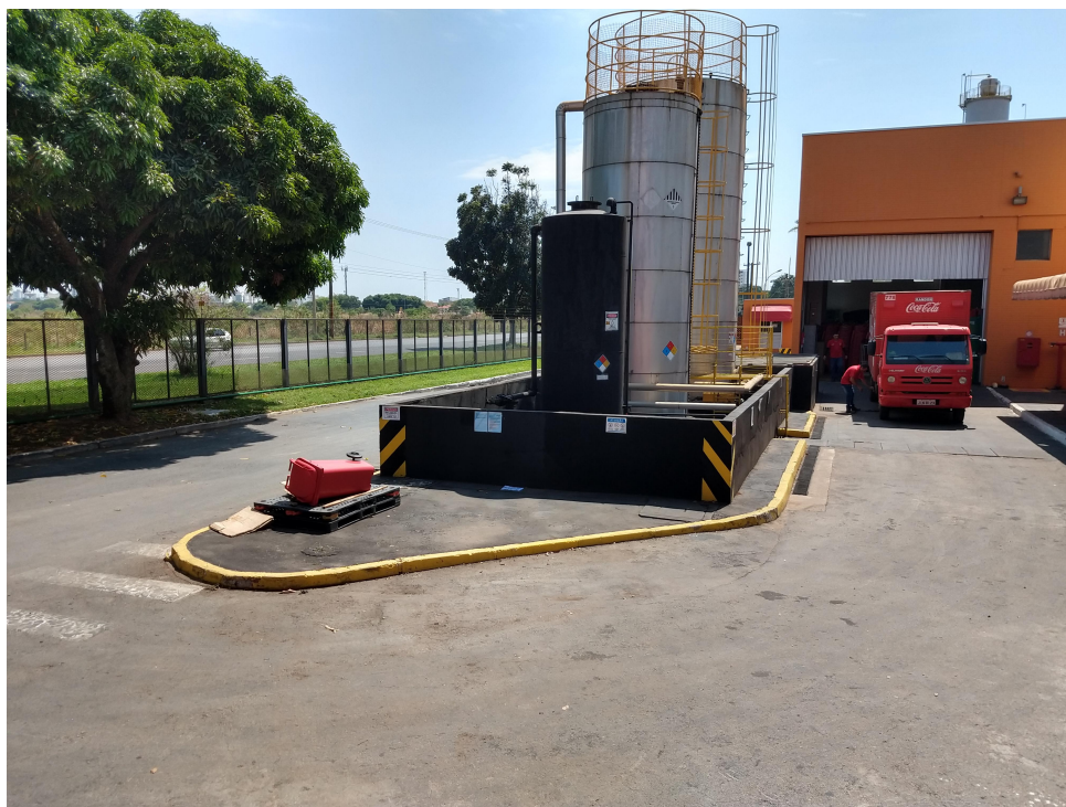
Figura 2 - Área de abastecimento do sistema aéreo realizada através de caminhões que abastecem em área sem a presença de canaletas.
