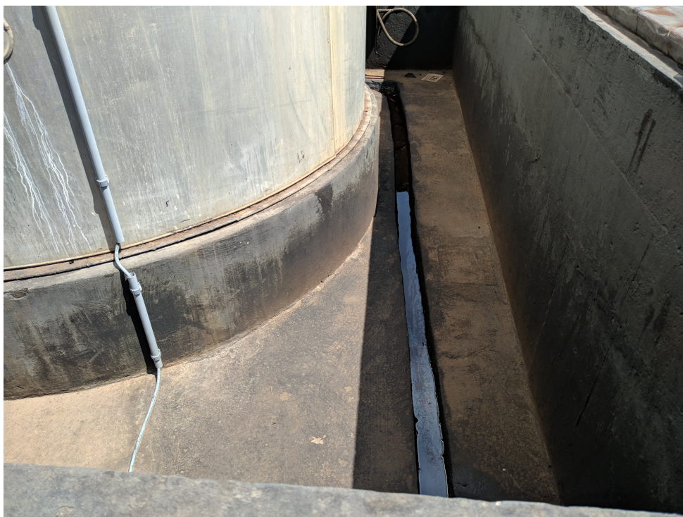
Figura 5 - Canaleta com a presença de substância líquida na área de combustíveis e óleos lubrificantes.
