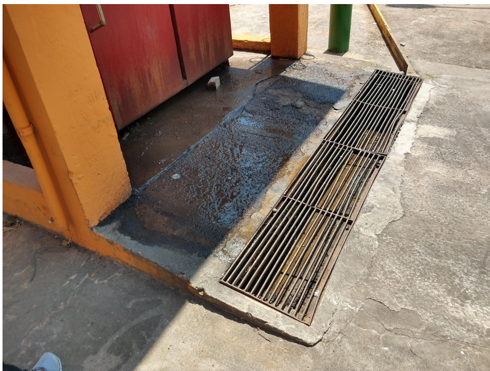
Figura 8 - Efluente bruto sendo despejado em canaleta sem barreiras de contenção lateral.
