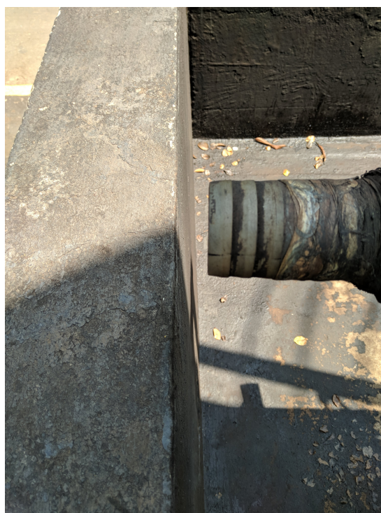
Figura 3 - Bocal para abastecimento de tanque aéreo.
