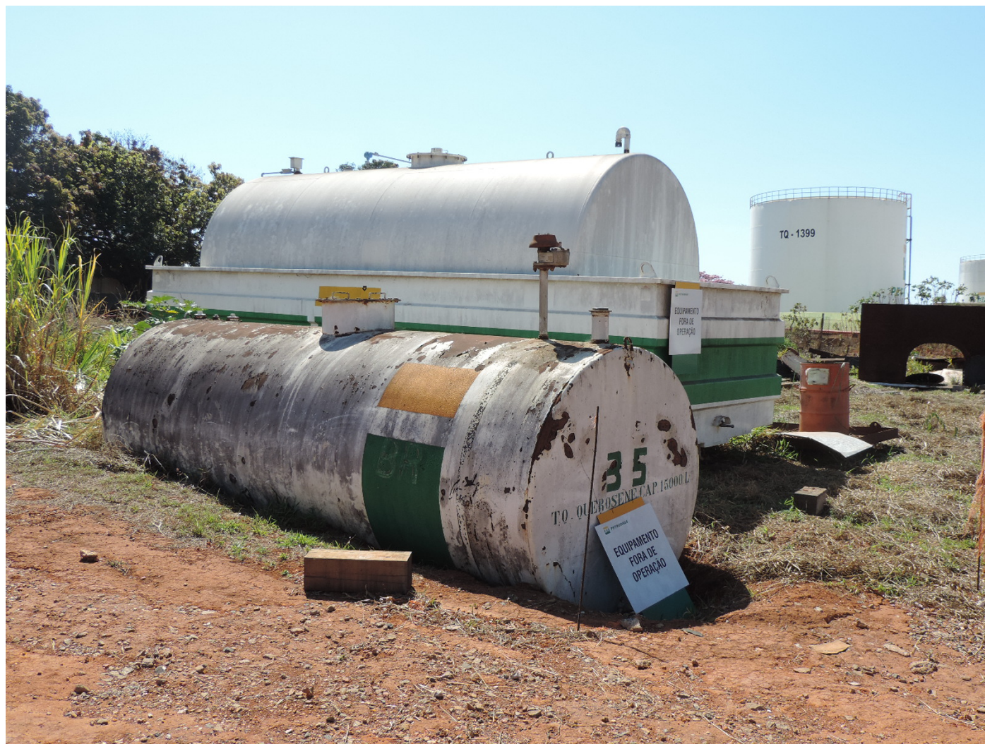
Figura 25 - Módulo de abastecimento e tanque fora de uso.
