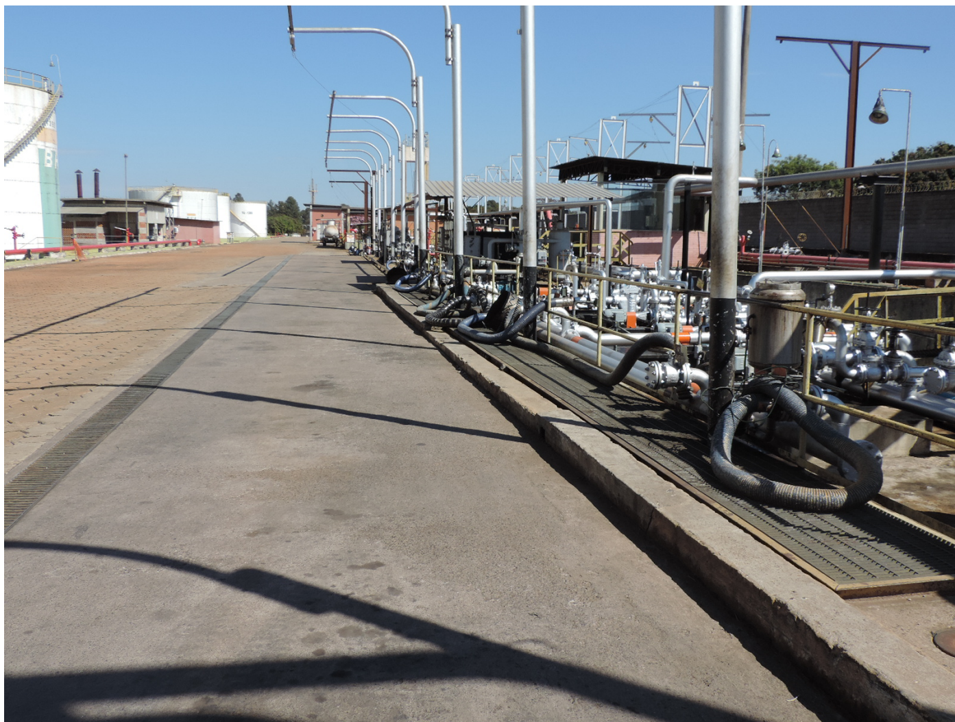
Figura 08 - Plataforma de descarga de caminhão tanque.
