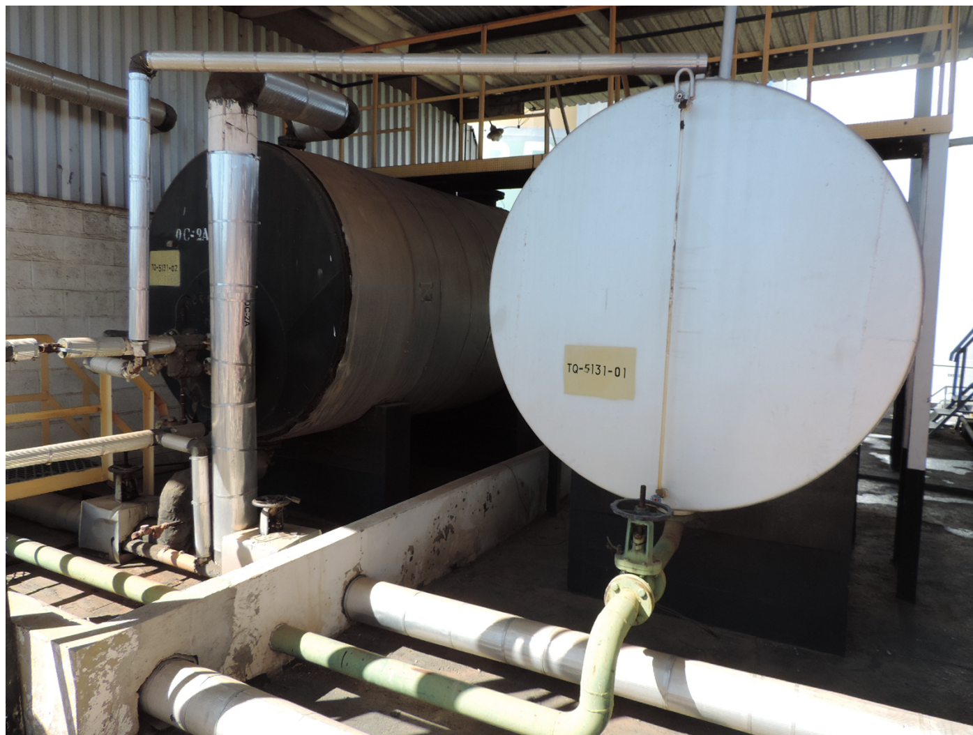
Figura 23 - Tanques de água e combustível das caldeiras desativadas.
