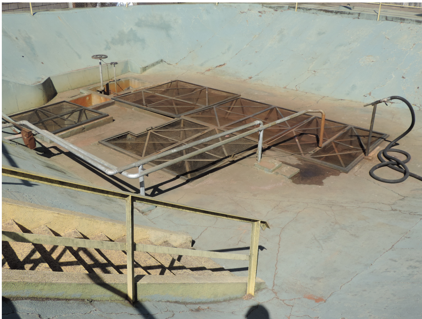
Figura 03 - Sistema Separador de água e óleo - SSAO (01).
