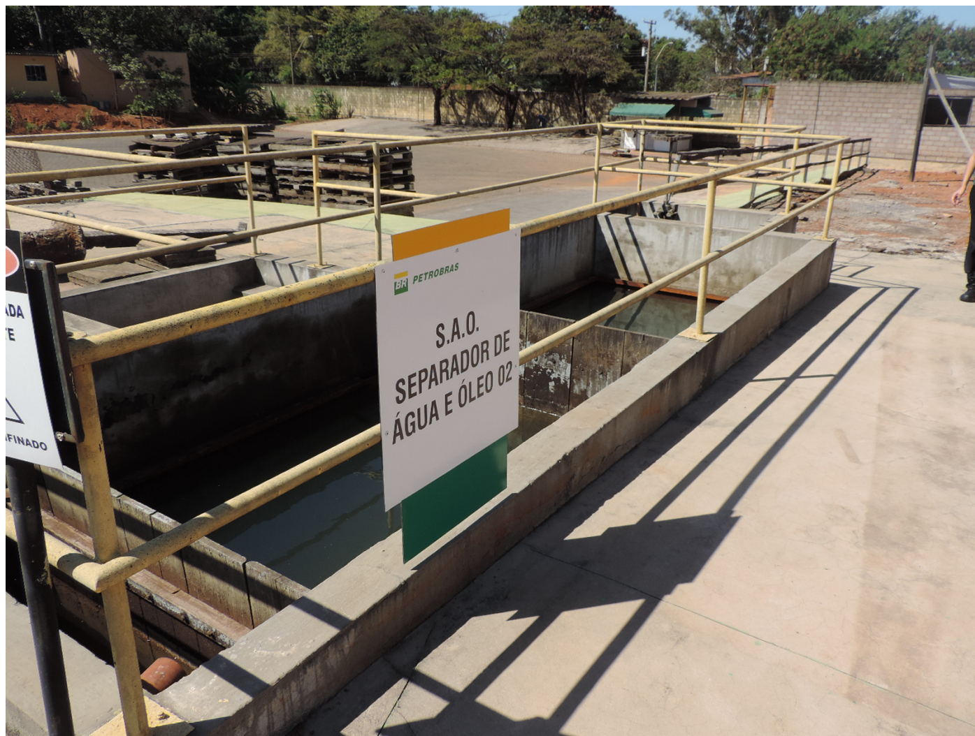
Figura 16 - Sistema separador de água e óleo - SSAO (02).
