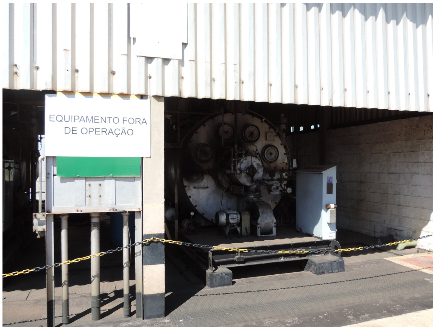
Figura 22 - Área de Caldeiras desativadas.
