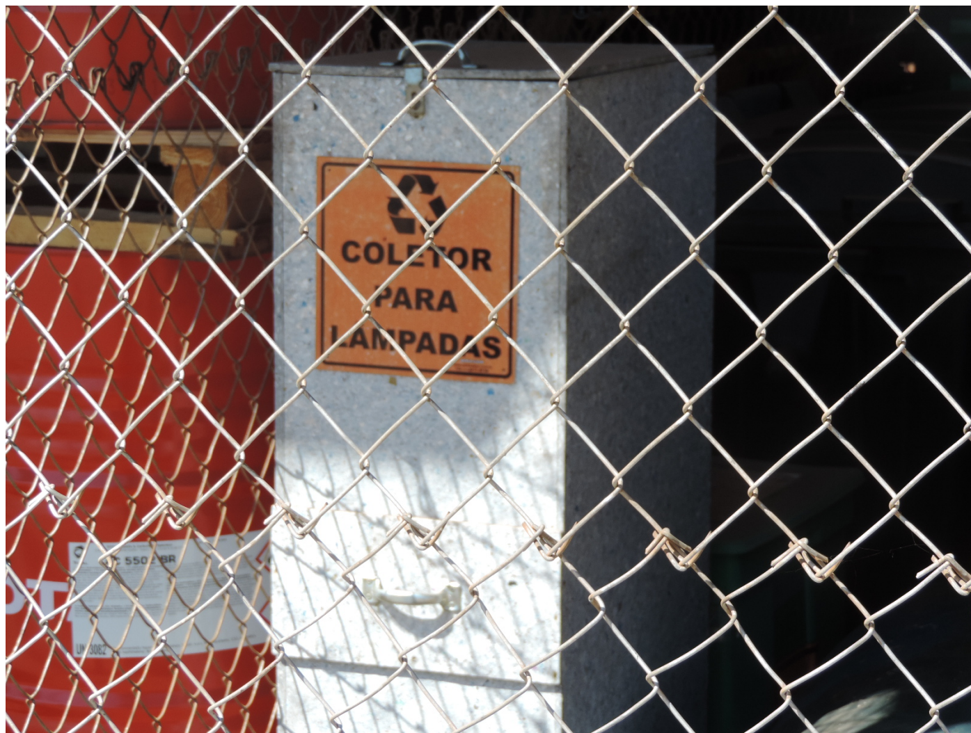
Figura 15 - Detalhe do coletor para lâmpadas dentro do armazém de resíduos.
