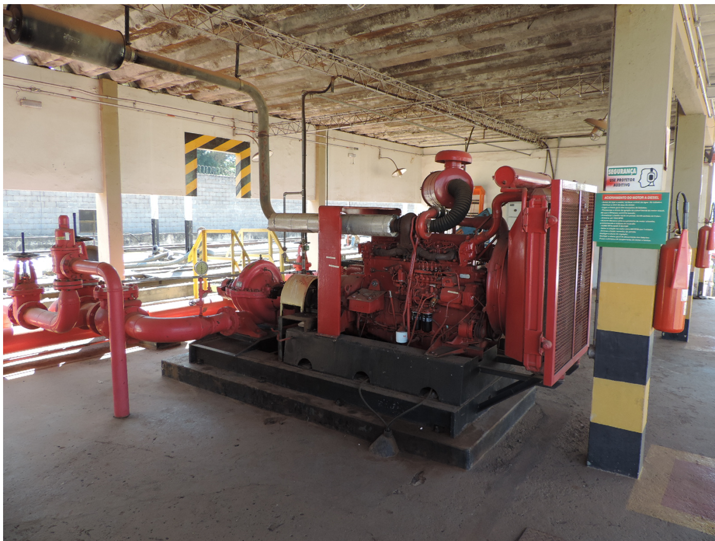
Figura 12 - Casa de bombas do sistema de combate a incêndio.
