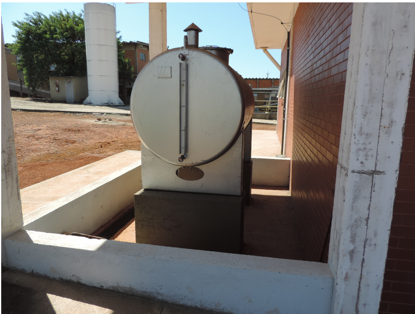
Figura 17 - Tanque para armazenamento de diesel da Subestação SE - III.
