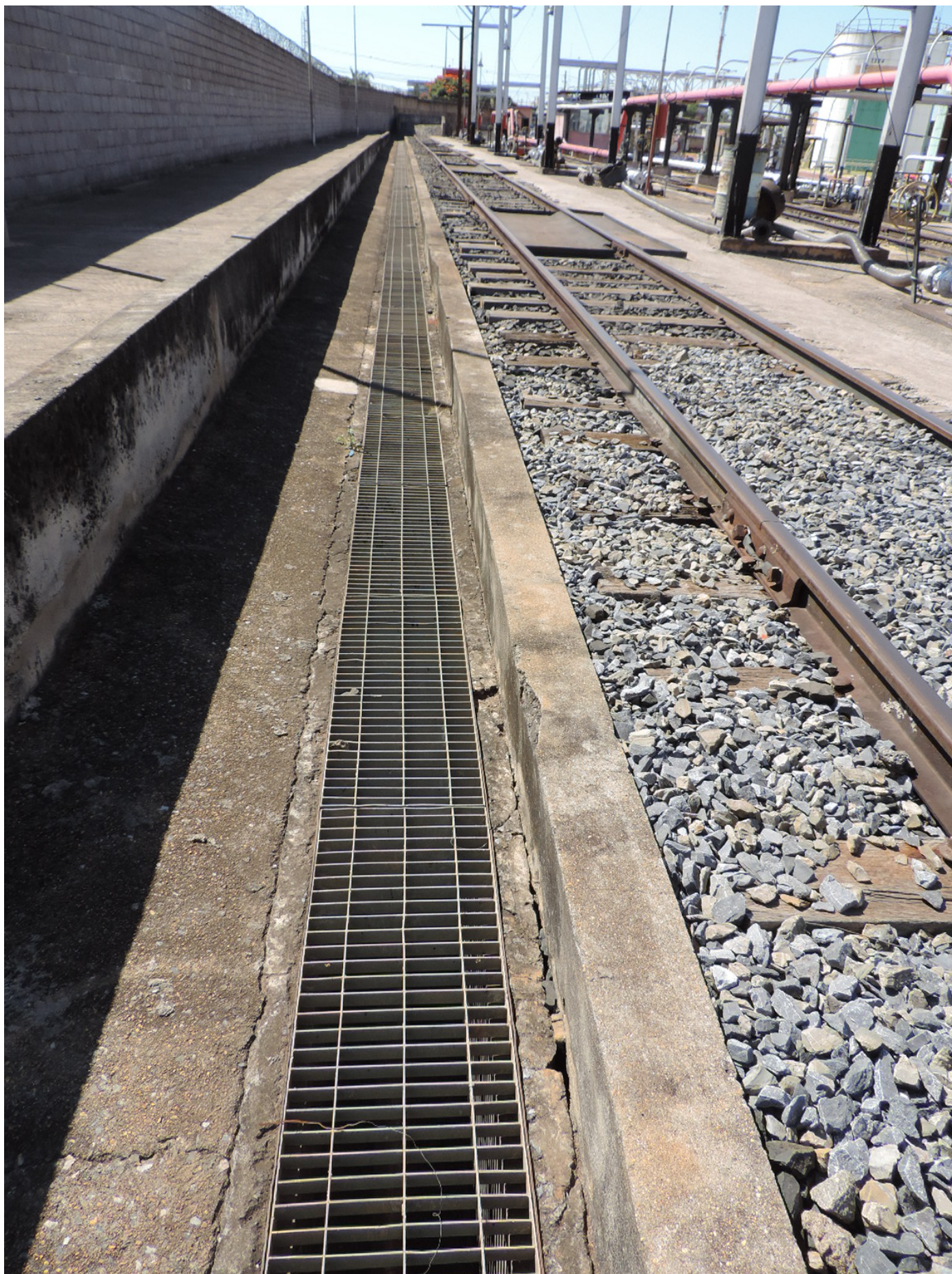
Figura 09 - Plataforma de descarga de vagões tanque, observa-se que a área é cercada por grelhas ligadas ao sistema separador de água e óleo e a presença de bacias de contenção nos locais onde ocorre a descarga dos vagões.
