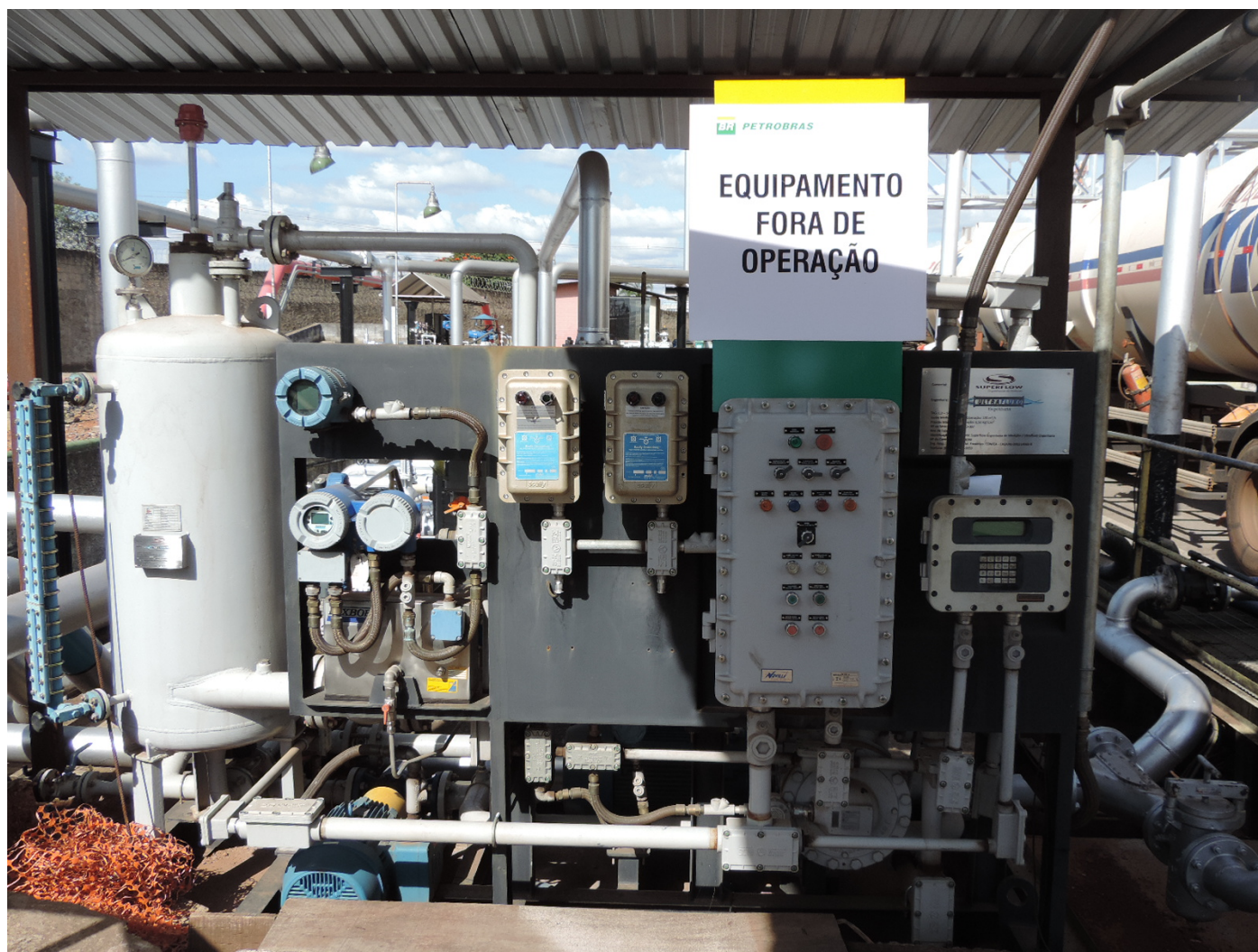
Figura 10 - SKID de descarga de caminhão tanque em instalação.
