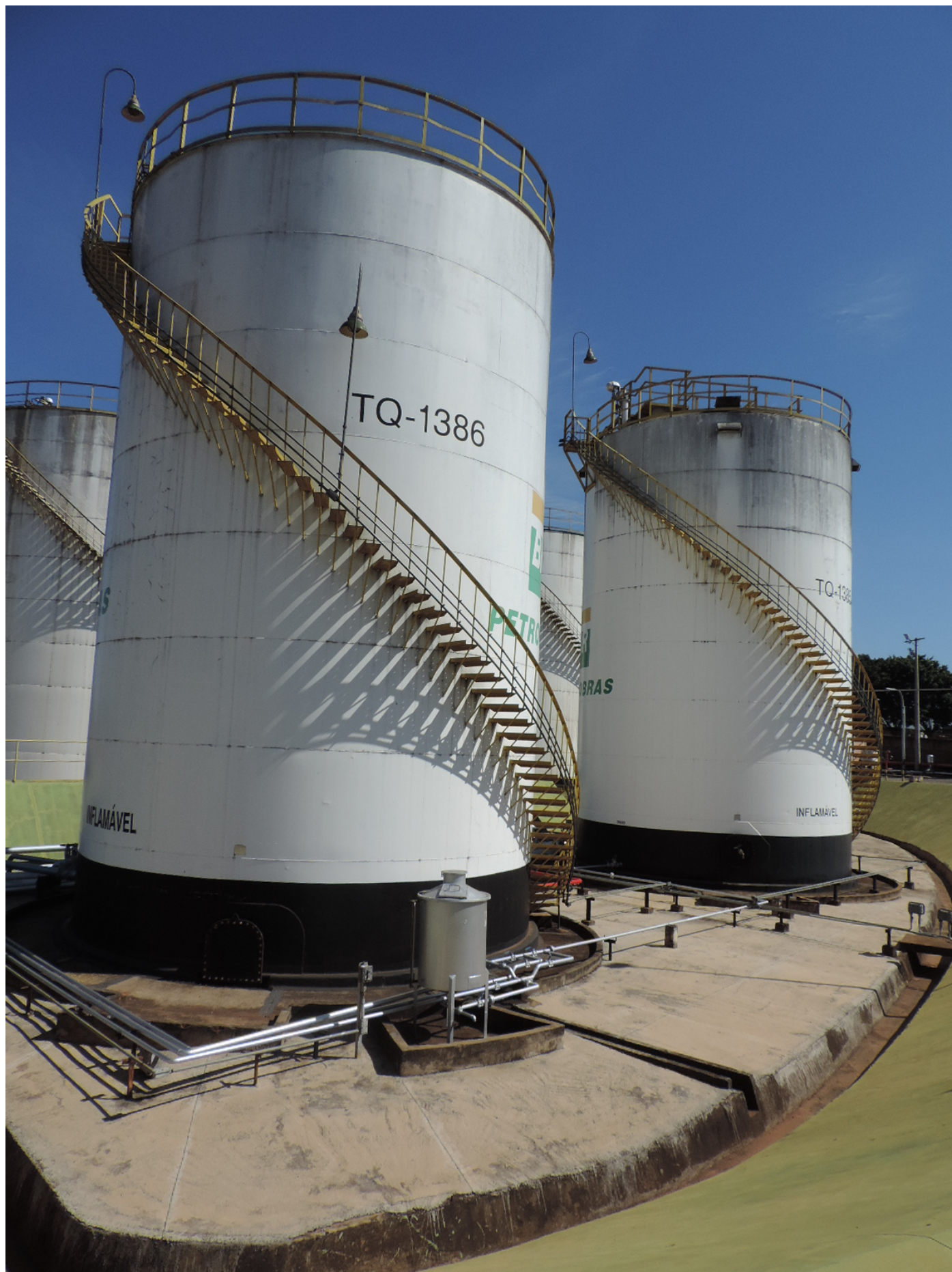
Figura 06 - Tanques verticais, localizados em bacias de contenção com piso em cimento e direcionadas ao SSAO (1), dotadas de válvulas que regulam a passagem do efluente somente quando necessário.
