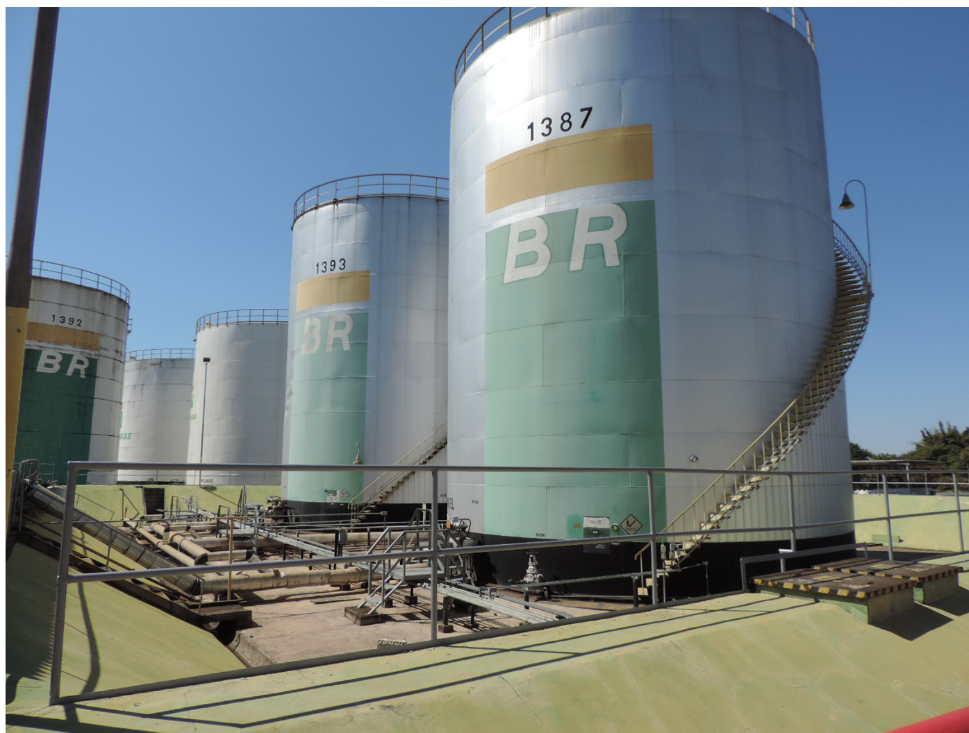
Figura 24 - Tanques de óleo combustível desativados.
