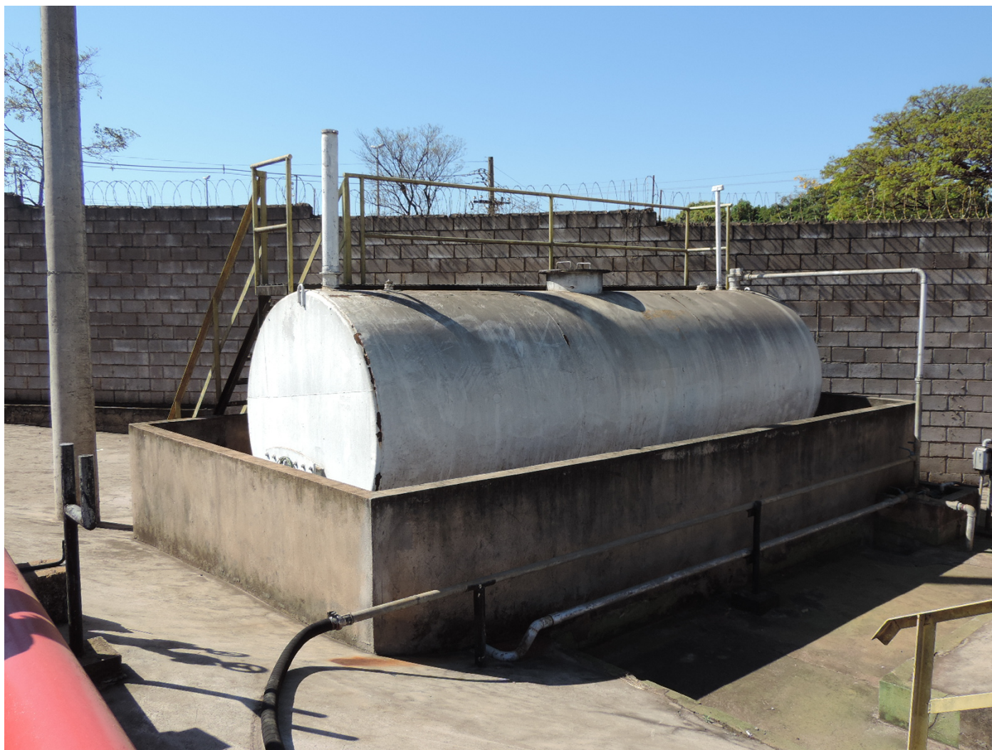
Figura 04 - Tanque para coleta dos resíduos do SSAO (01), cercado por bacia de contenção.
