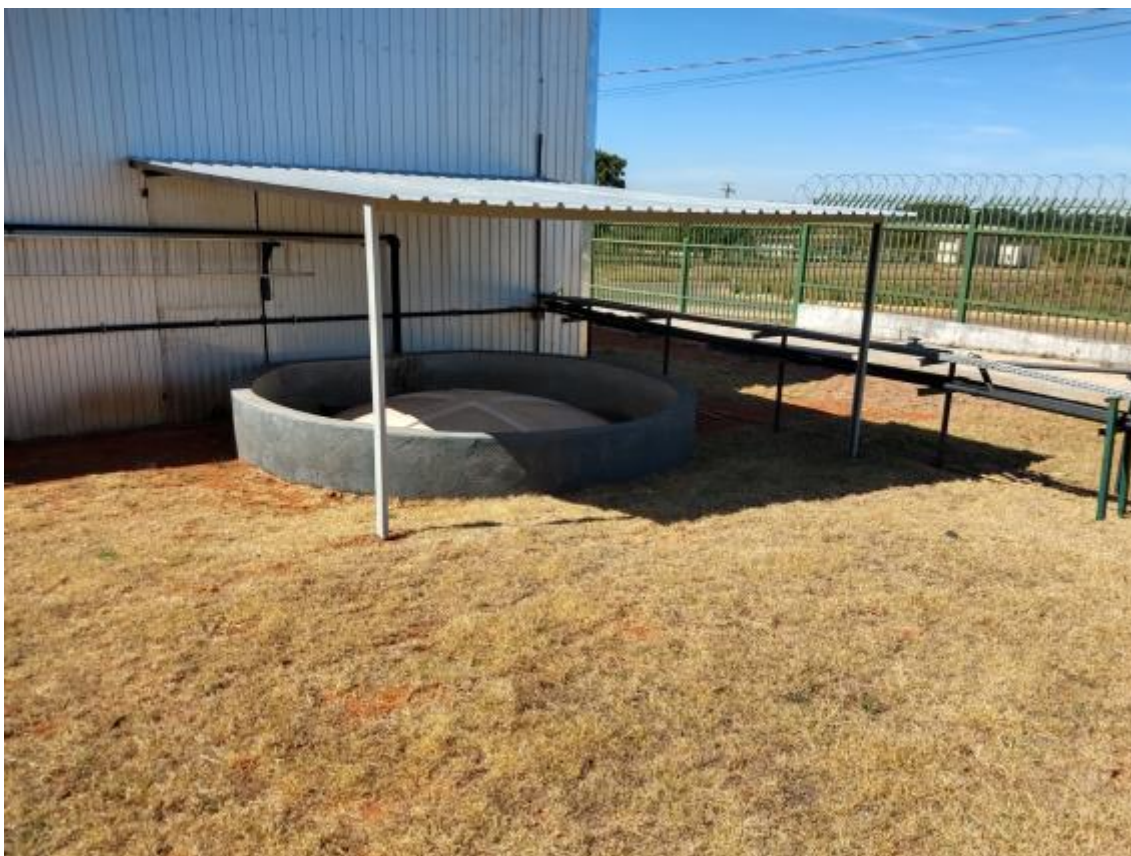
Figura 10 - Tanque de óleo do processo de decantação da ETEI.
