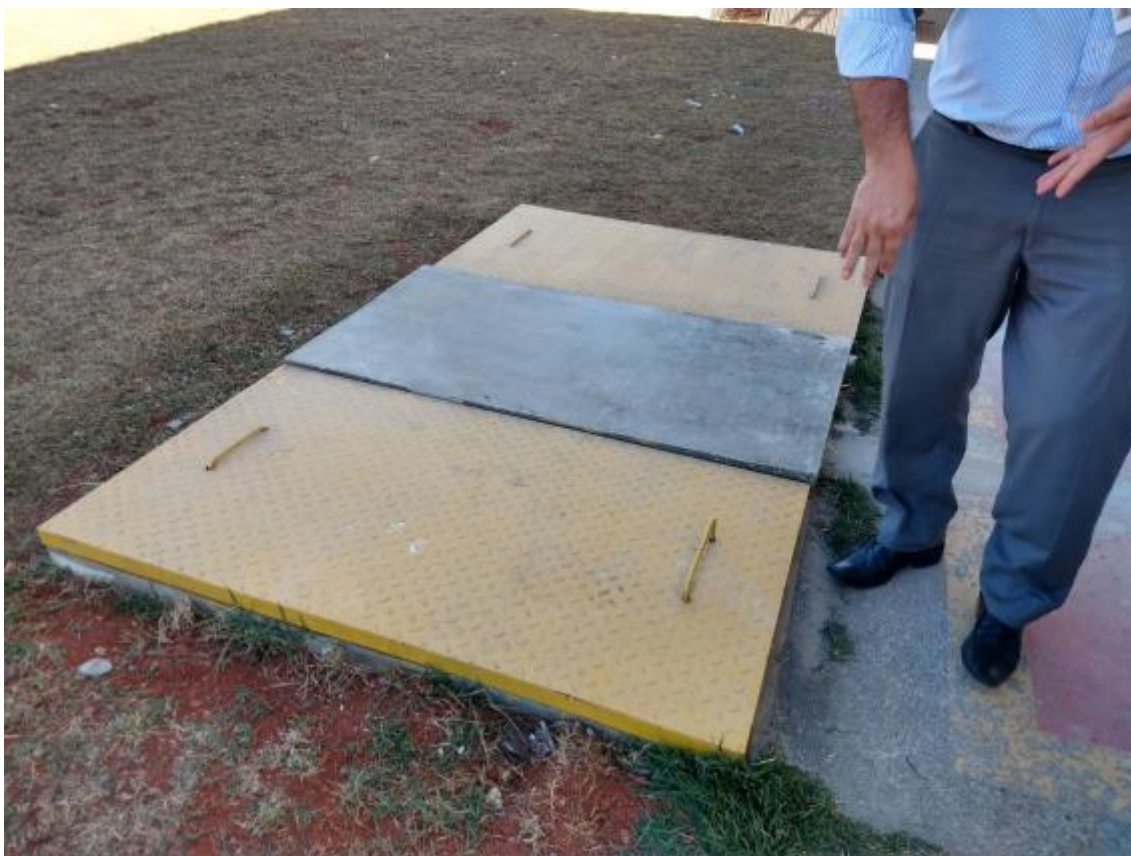
Figura 8 - Tanque de armazenamento dos produtos químicos.
