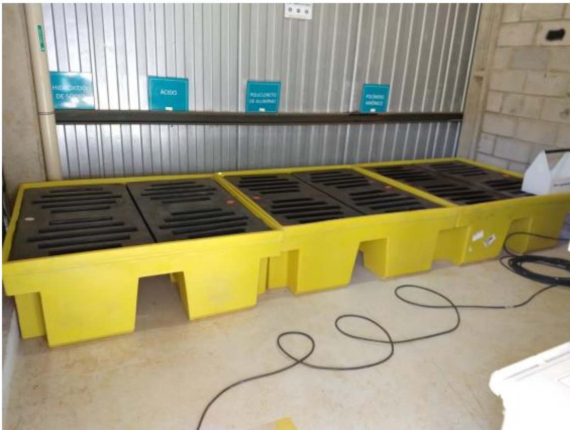
Figura 9 - Bacias de contenção dos produtos químicos da ETEI.
