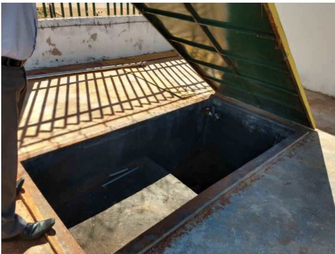
Figura 14 – Descarga à distância.
