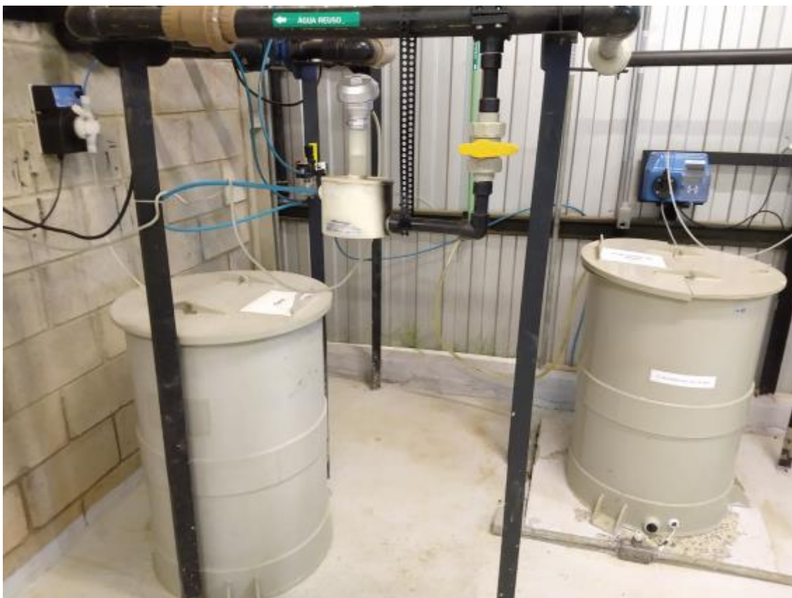
Figura 3 - Nova área do clorador dentro da ETEI.
