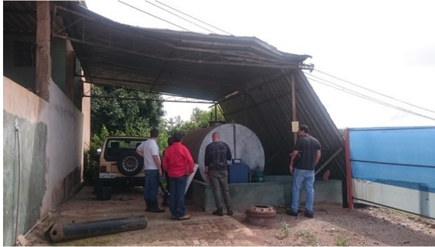
Figura 17: Posicionamento do tanque de combustível aéreo e da bacia de contenção e respiro abaixo da cobertura, de forma inadequada. Fonte: vistoria IBRAM, 15/12/2017.
