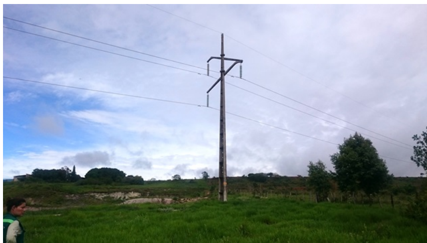
Figura 03: linhas de transmissão e faixa de segurança. Fonte: vistoria IBRAM, 15/12/2017.
