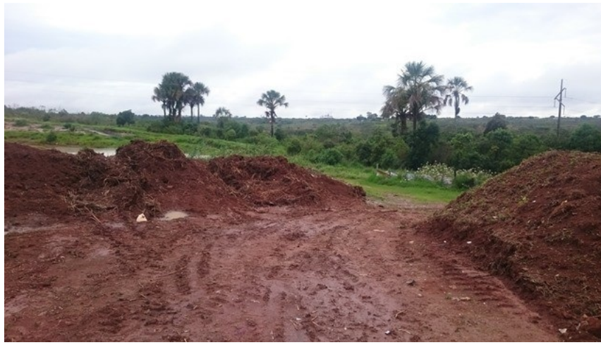
Figura 12: Leiras de solo fértil, na área da jazida. Fonte: vistoria IBRAM, 15/12/2017.
