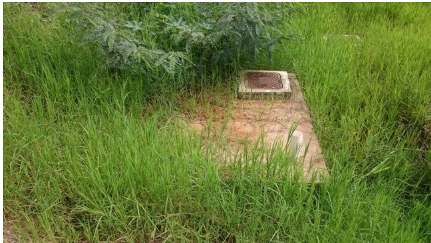
Figura 18: Sistema Separador de Água e Óleo - SAO, ao lado da área de manutenção e de abastecimento de veículo. Fonte: vistoria IBRAM, 15/12/2017.
