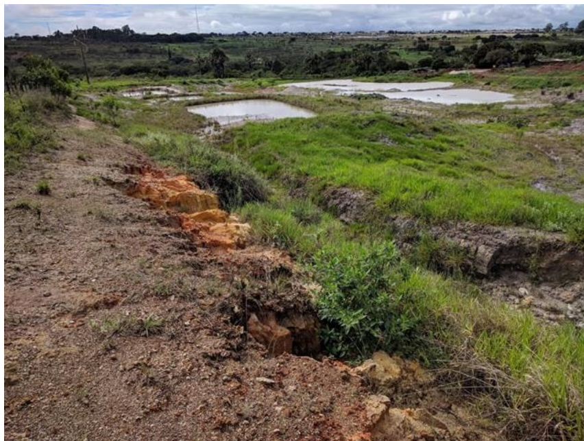
Figura 13: pontos com taludes sem cobertura vegetal e com focos erosivos. Fonte: vistoria IBRAM, 15/12/2017.
