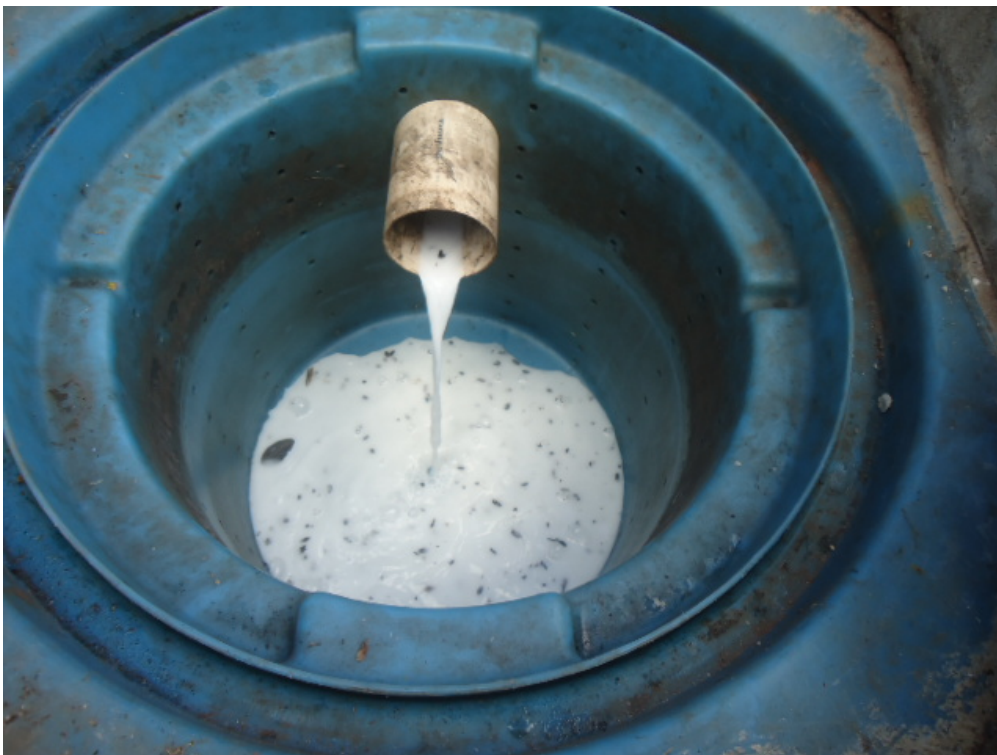
Figura 19 - Caixa de areia do Sistema Separador de Água e Óleo da pista de abastecimento. Observa-se que o sistema está em pleno funcionamento em função do teste que foi realizado com " corante branco " nas canaletas do sistema de drenagem oleosa - SDO da pista de abastecimento.
