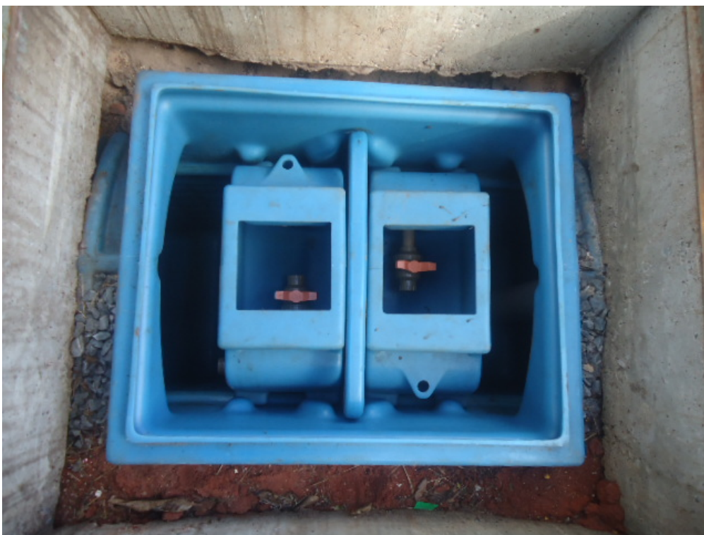
Figura 20 - Aspecto da Caixa Separadora de água e óleo do SAO da pista de abastecimento.
