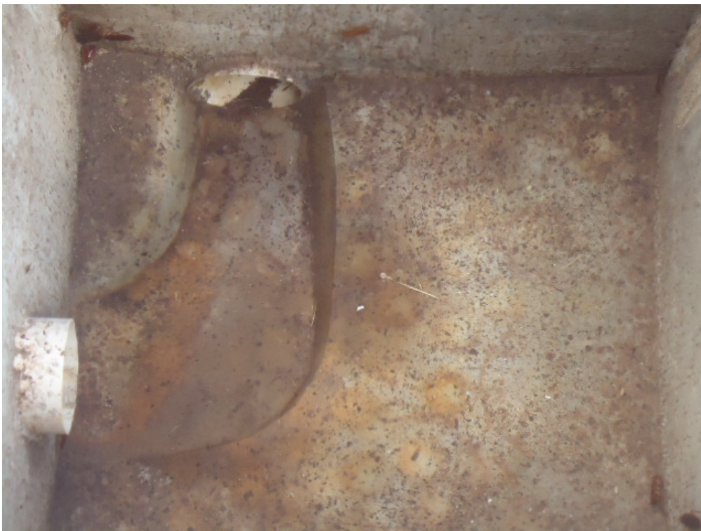
Figura 21 - Caixa de Amostragem de efluentes da pista de abastecimento
