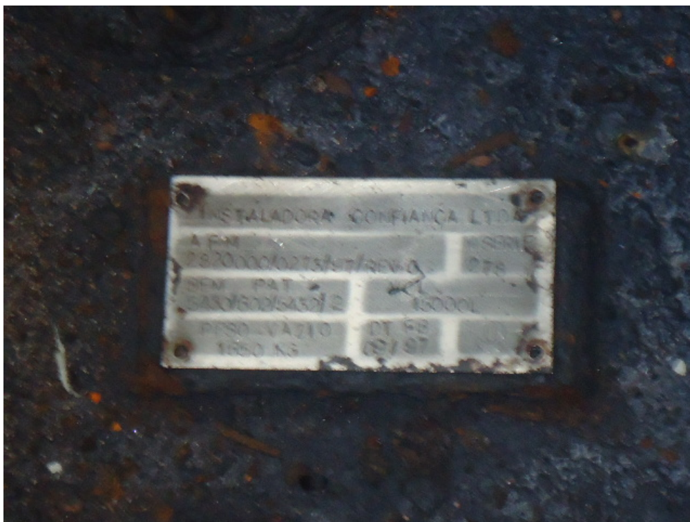
Figura 23 - Placa de identificação de um dos 6 (seis) conjuntos de tanque de parede simples do Sistema de Armazenamento Subterrâneo de Combustíveis - SASC. Observa-se a placa de identificação datando o período do ano de fabricação que é de 1997.
