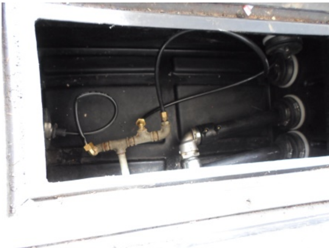
Figura 16 - Câmara de contenção do filtro de diesel, observa-se boa manutenção.
