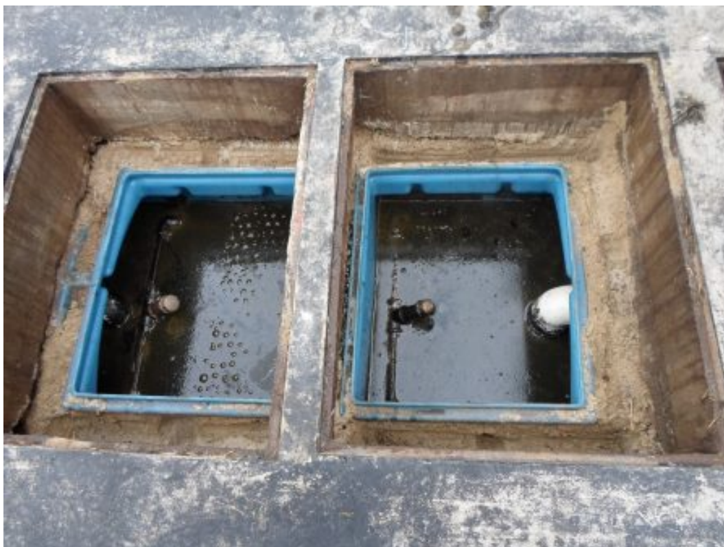
Figura 20 - Caixa separadora de água e óleo - Pista de Abastecimento.
