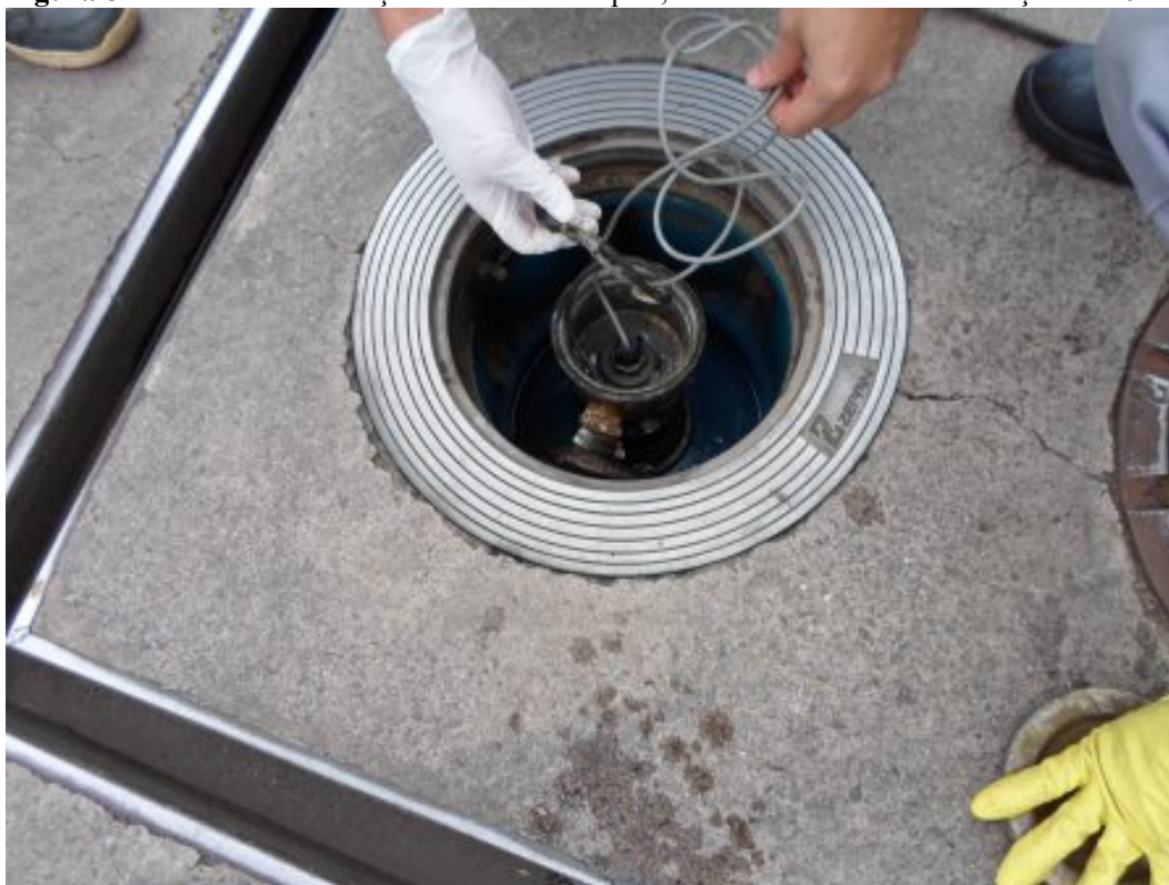
Figura 9 - Câmara do monitoramento intersticial, observa-se o sensor instalado.
