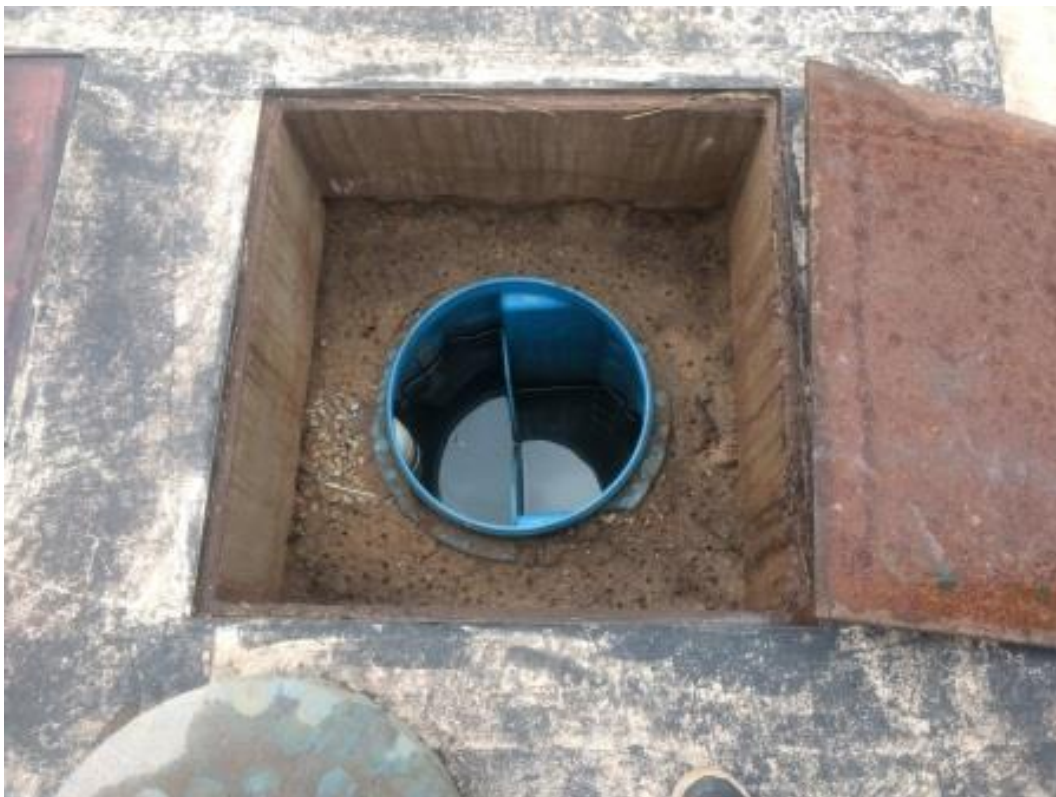
Figura 22 - Módulo medidor de vazão com coleta de amostras - Pista de Abastecimento.
