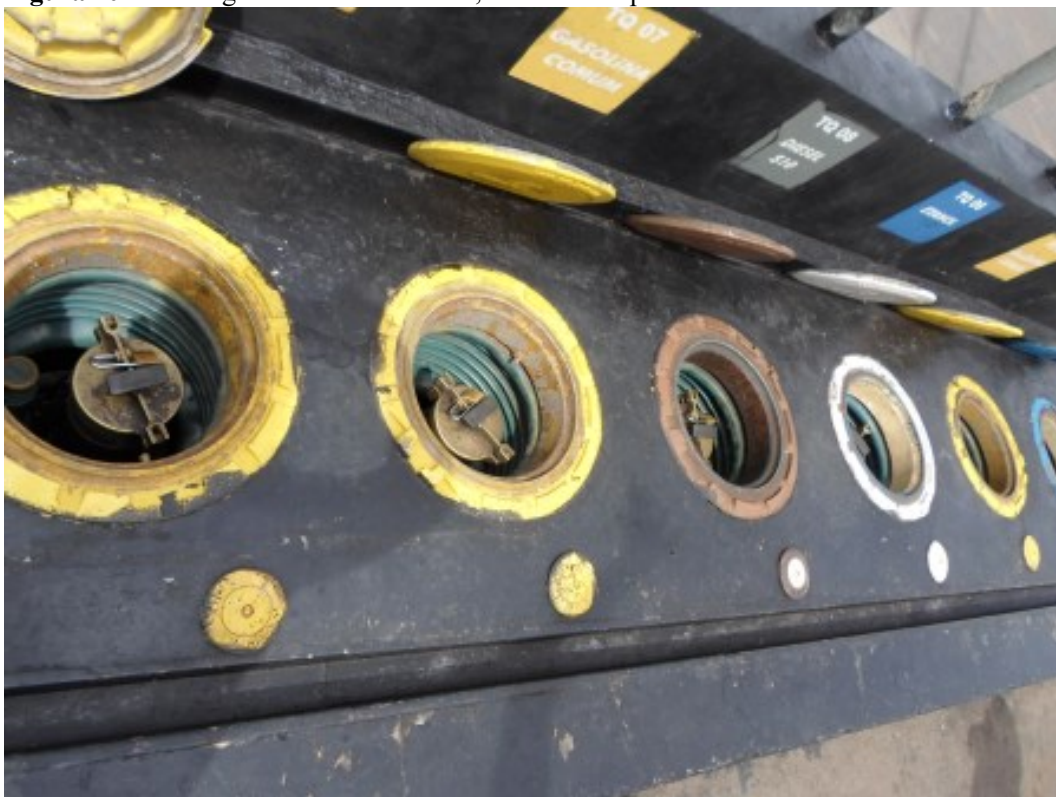
Figura 11 - Detalhe das descargas seladas a distância, boa manutenção do equipamento.
