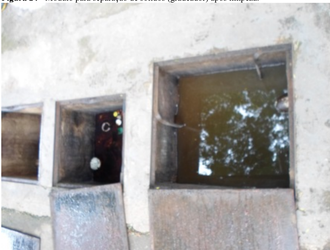
Figura 25 - Sistema Separador Água e Óleo da Área de Lavagem de Veículos.
