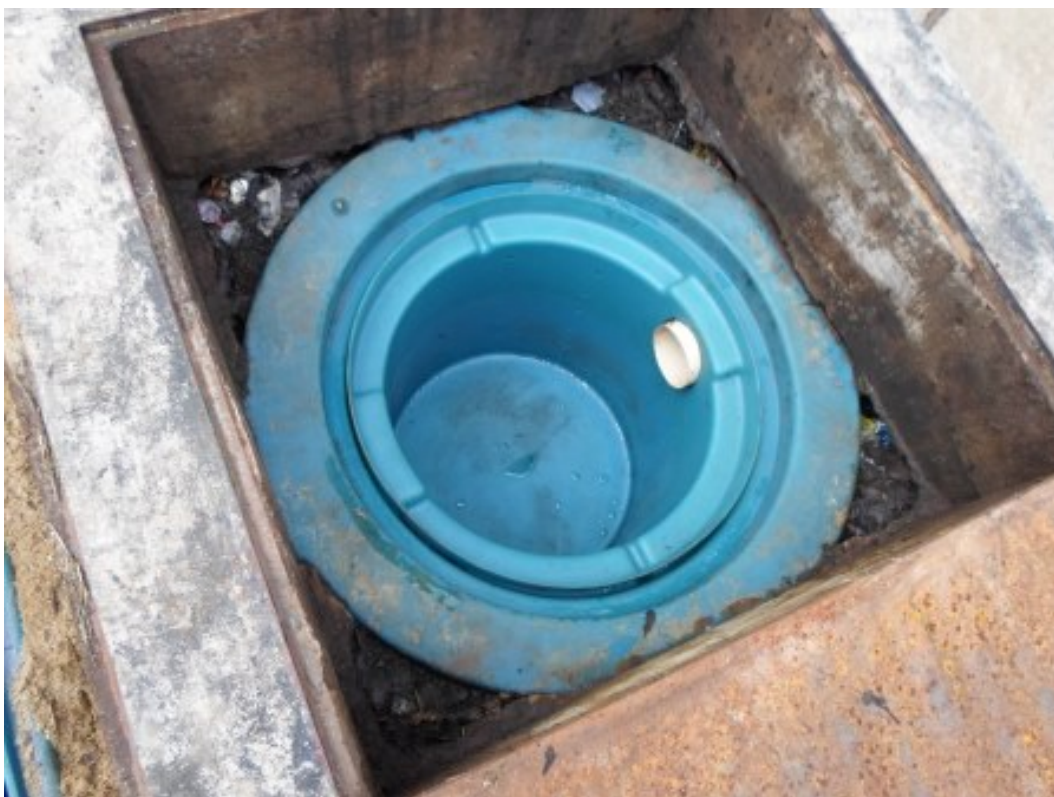
Figura 24 - Módulo para separação de sólidos (gradeador) após limpeza.
