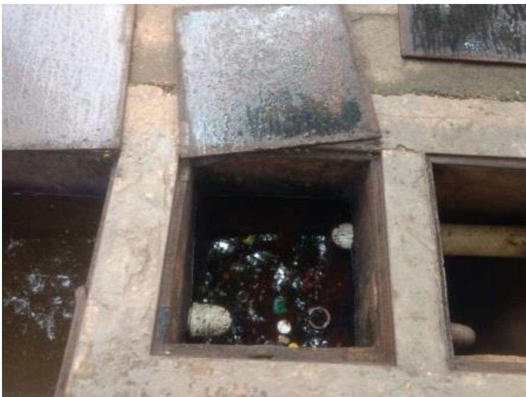
Figura 26 - Detalhe da caixa separadora com a presença de sólidos grosseiros.
