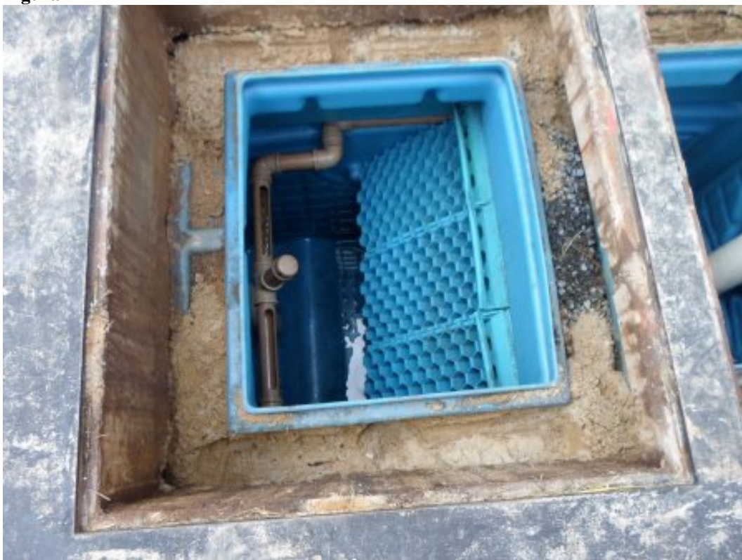
Figura 23 - Detalhe de caixa separadora de água e óleo após realização de limpeza por empresa especializada.
