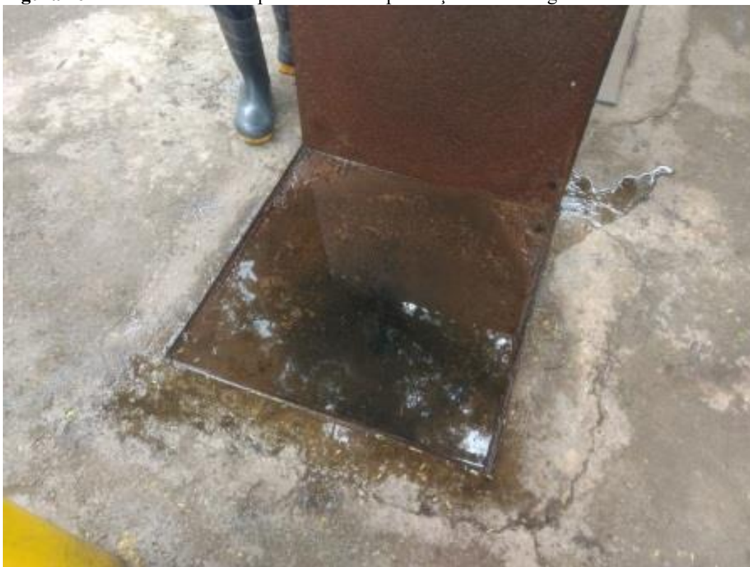
Figura 27 - Antigo sistema separador da área de lubrificação, obturado.
