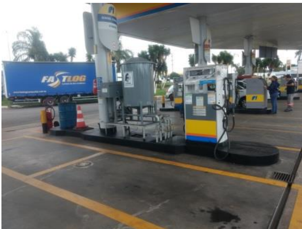
Figura 14 - Pista de abastecimento, onde observa-se uma ilha com um filtro de diesel e uma unidade abastecedora.
