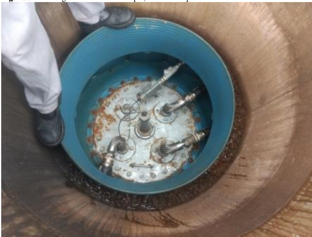
Figura 7 - Acesso a boca de vista do tanque, com câmara de contenção.
