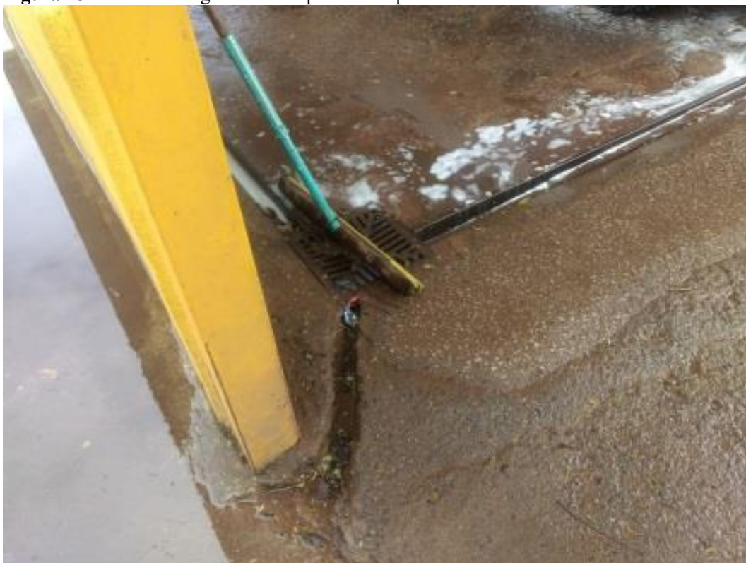
Figura 29 - Detalhe dos canaletes do SDO da área de lavagem de veículos, observa-se extravasor para fora do sistema.
