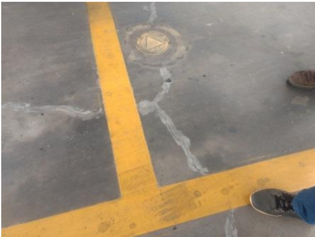
Figura 18 - Formação de rachaduras, mesmo após impermeabilização da pista.
