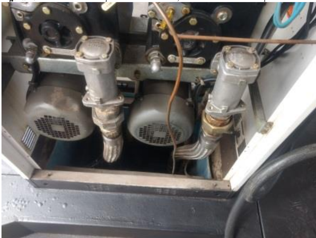
Figura 17 - Câmara de contenção da unidade de abastecimento, observa-se que toda a tubulação que transporta combustível está contida dentro dos limites da câmara, check valve e boa manutenção do equipamento.
