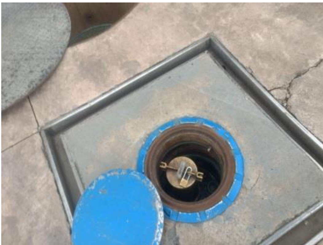
Figura 6 - Descarga selada sobre o tanque, circundada por canaletos destinados ao SAO.
