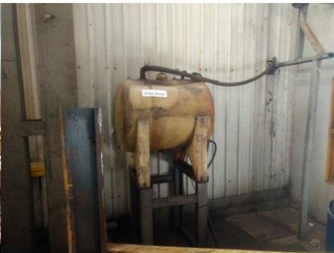
Figura 11 - Tanque de diesel que abastece o gerador sem a devida contenção.
