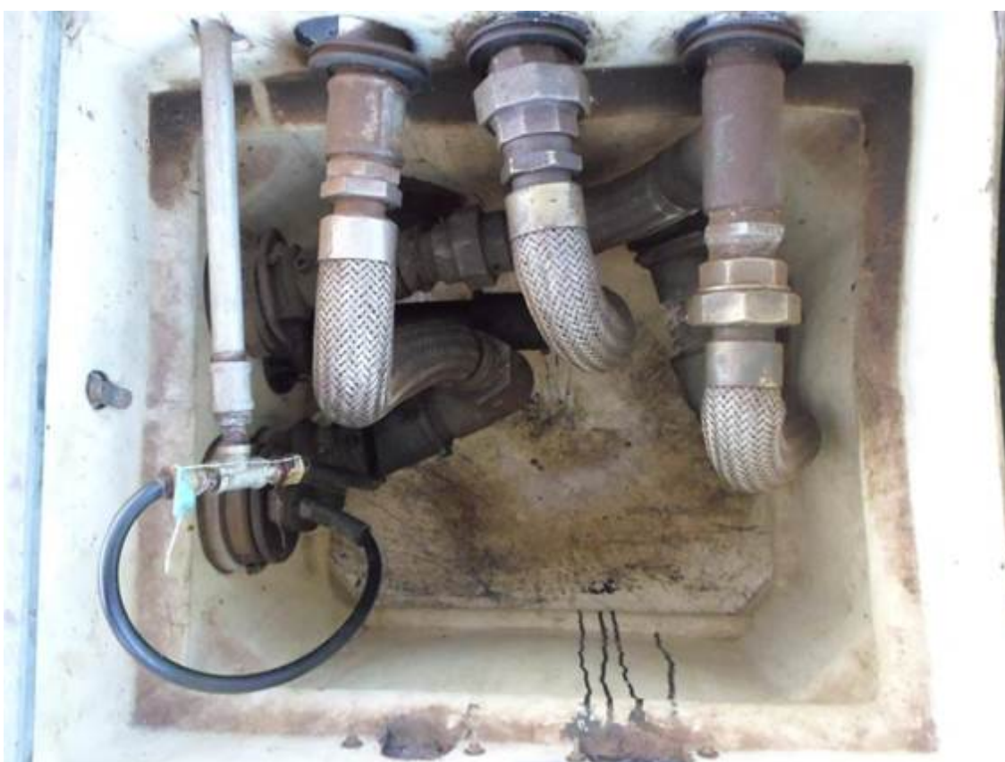
Foto 3 – Câmara de Contenção para Unidade de Filtragem, localizada na pista de abastecimento.
