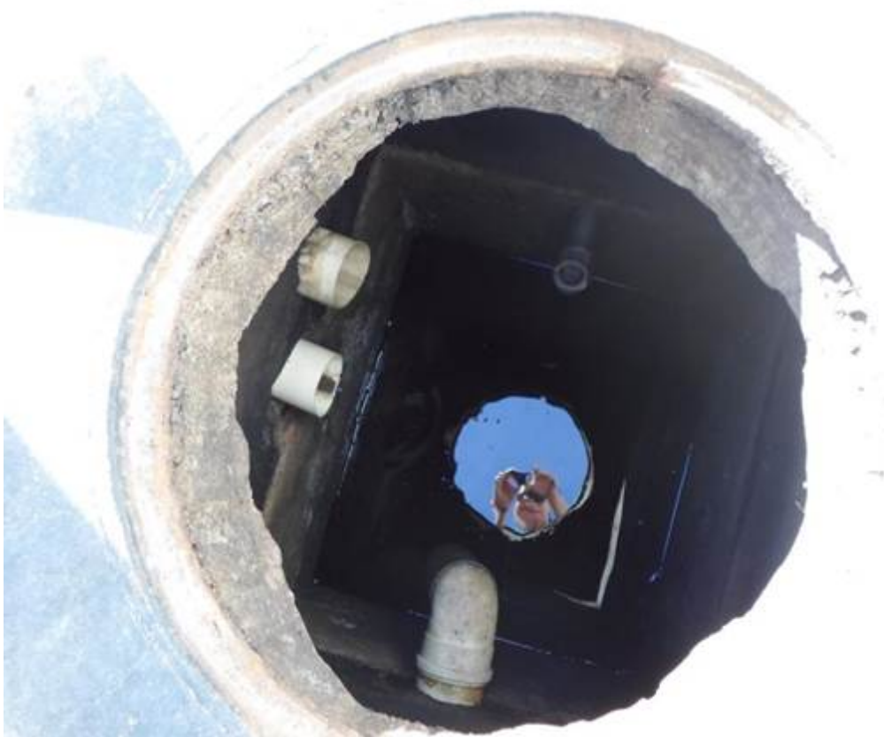
Foto 7 – Caixa Separadora do SAO da pista.
