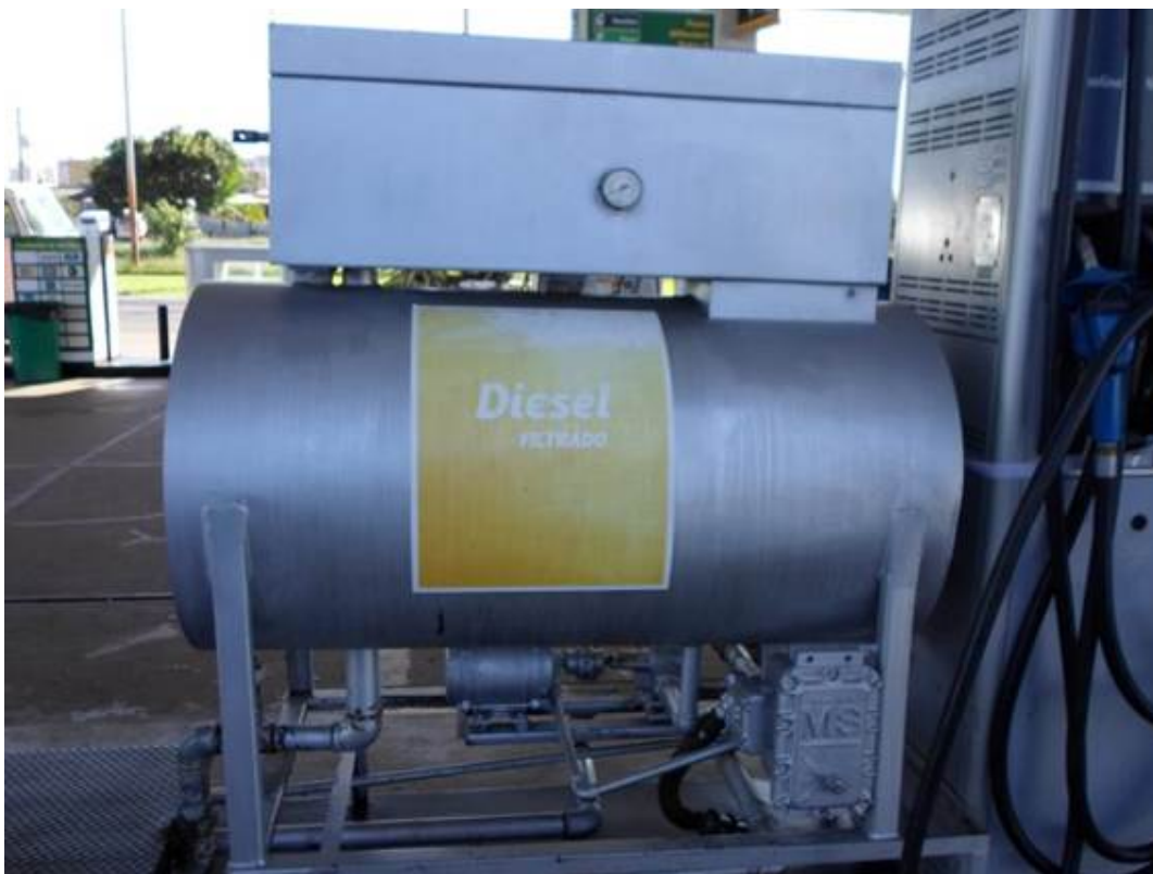
Foto 2 – Filtro de Diesel localizado na pista de abastecimento circundada por canaletes.
