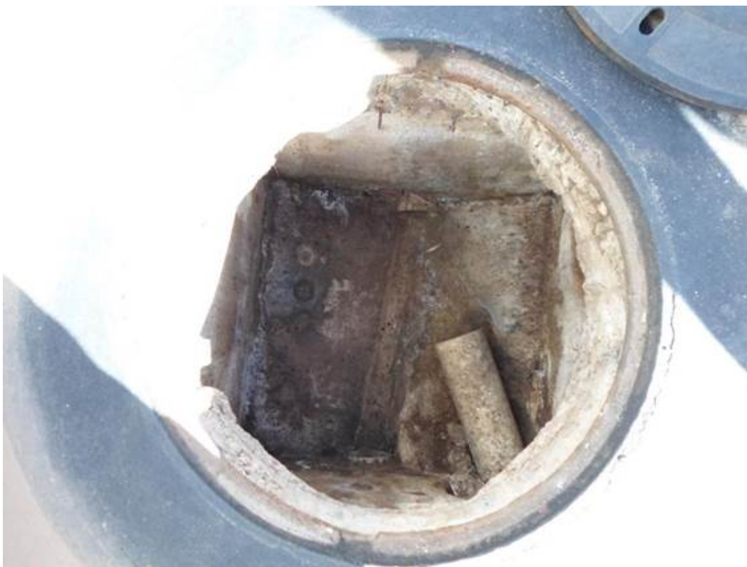
Foto 6 – Caixa Coletora de óleo do SAO da pista.
