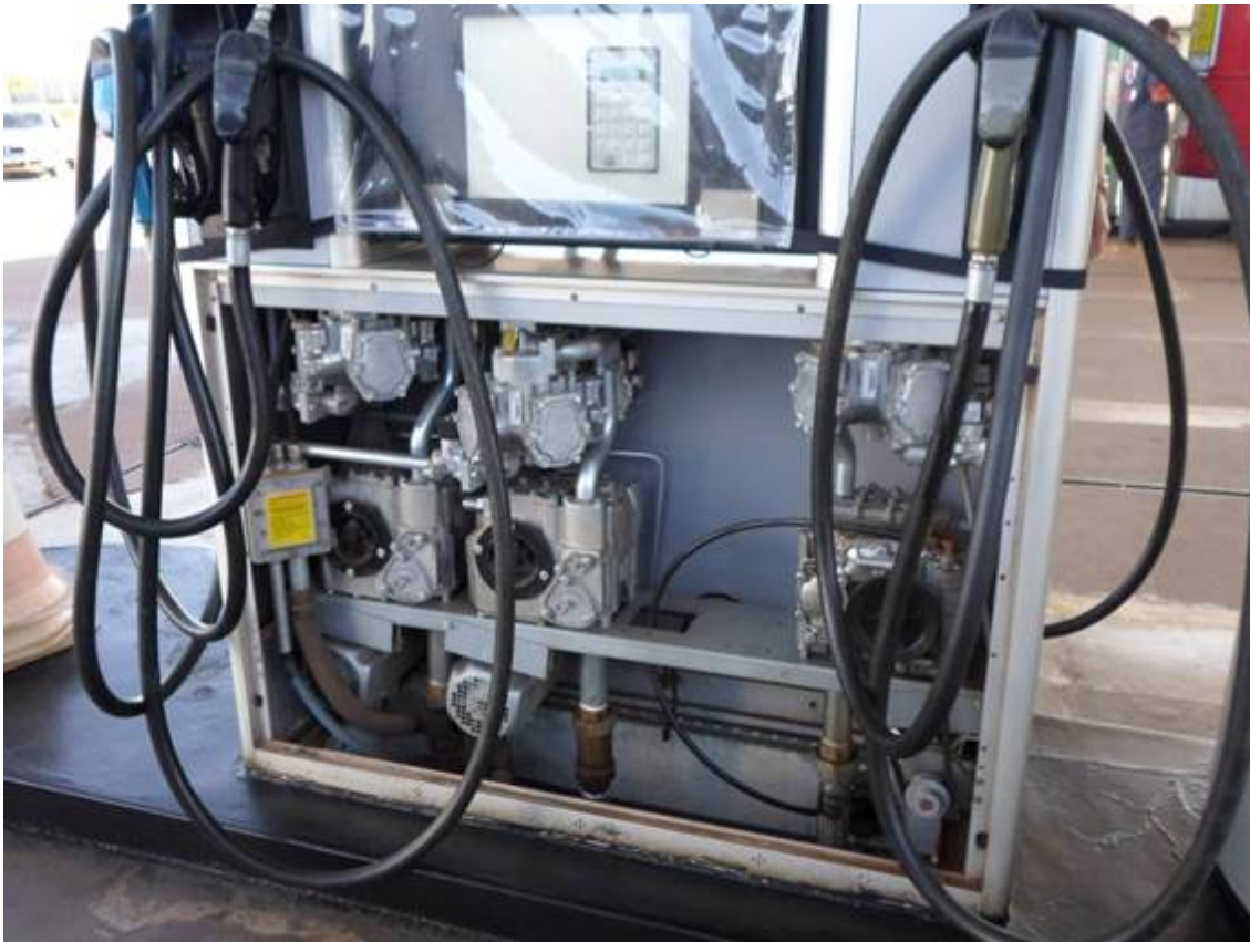
Foto 16 – Visão geral da Bomba de Abastecimento.
