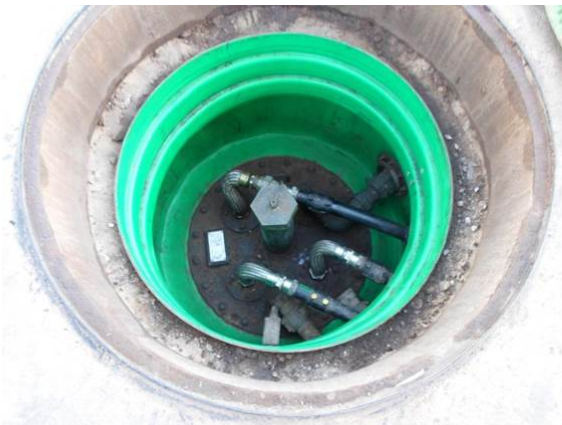
Foto 13 – Boca de Visita do Tanque evidenciando controle eletrônico de estoque, tubulação subterrânea de PEAD e ausência de água ou combustível em seu interior.
