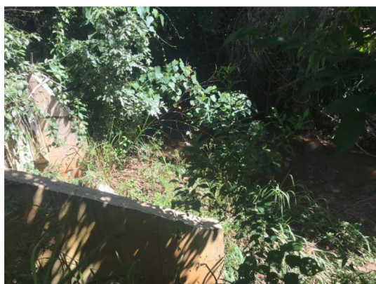
Foto 03 - Dispositivo de lançamento de drenagem no córrego Cachoeirinha.
