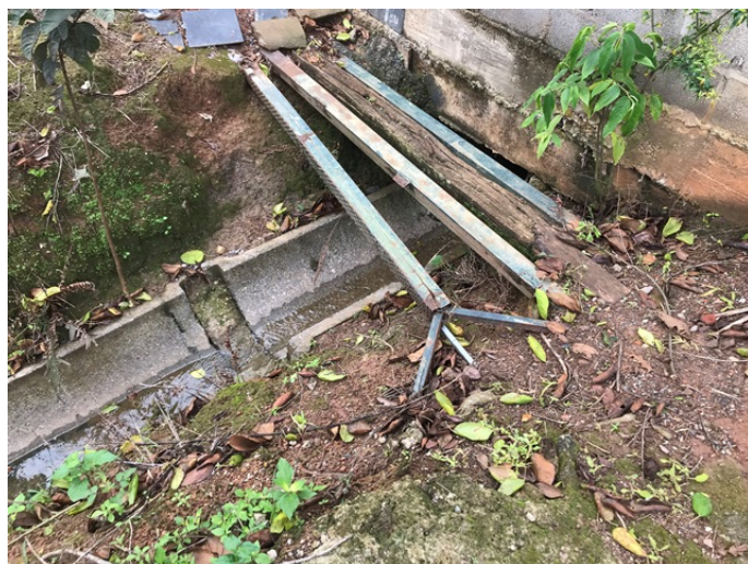
Foto 4 - Lançamento de drenagem de maneira improvisada.
